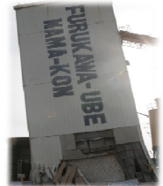
傾いた生コンプラント
