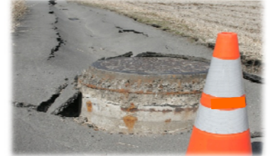
浮き上がったマンホール
