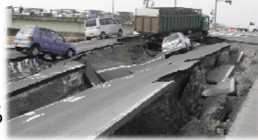
車両も巻き込んだ地割れ
