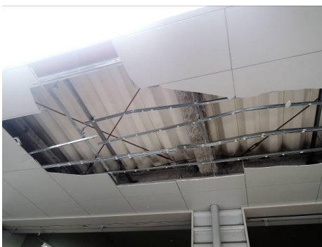
写真8 軒天井の強風による損傷
