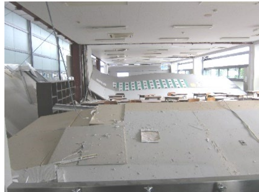
写真1 LGS 壁の地震被害 3)
