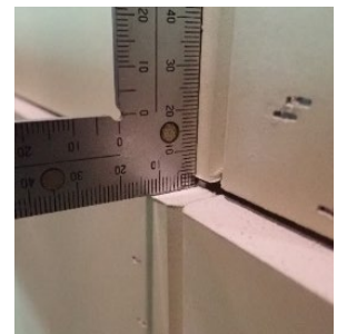
(c) 目地部分でのボードの剥がれ（慣性力 +2.0\% 後）
