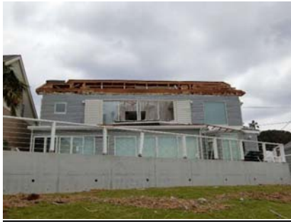
図6 木造住家の屋根の飛散 1)
