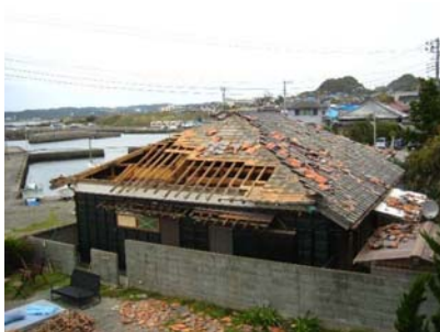
図7 野地板が飛散した木造住宅 1)
