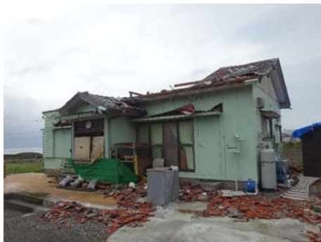
図5 小屋組が飛散した住家 1)
