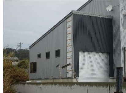
図10 住家の外壁の剥離（館山市）
