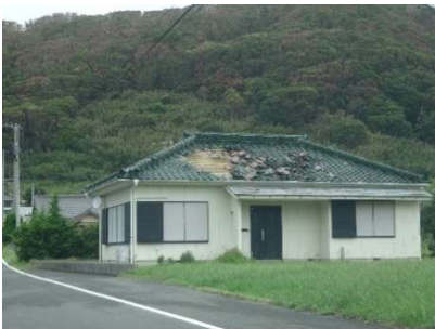
図8 屋根平部の屋根瓦の飛散 1)
