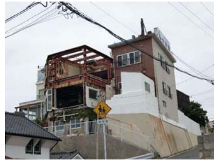
図9 宿泊施設の外壁の脱落状況 1)
