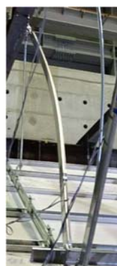
写真 4 ブレースの座屈
