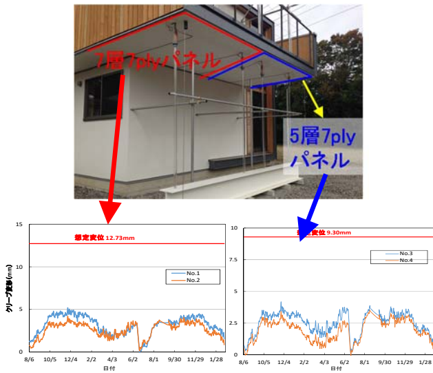
図64 片持ちバルコニーの温湿度変動下のメカのソープティプ変形(左:7層7プライ、右:5層7プライ)
