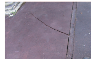
写真 3.3.5 地震計付近の舗装のひび割れ
