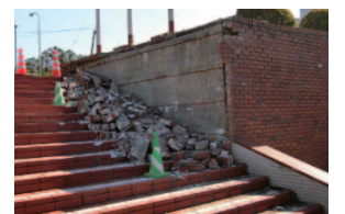
写真 3.3.6 早来町民センター庁舎南側の擁壁の仕上煉瓦の崩壊
