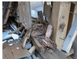
(e) 柱脚部の腐朽
