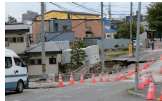
写真 4.1 道路舗装の損壊と著しい地盤変状
