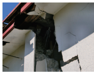
(d) 破壊部分の詳細 (頂部)
