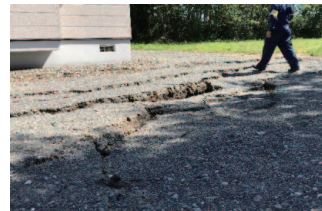
(a) 西側の地割れ
