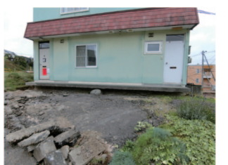
写真 4.8 地盤が沈下したとみられる住宅
