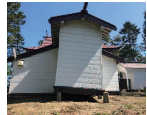
写真 3.2.12 寺社建築 C 西側の破壊状況
