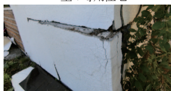
写真 3.3.31 写真 3.3.30 の浴室と思われる部分の立ち上がり基礎部分の脱落
