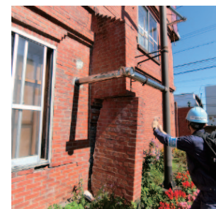
写真 3.3.14 写真 3.3.11 の破損した控え壁のような部分
