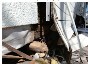
(d) 一部の構造躯体の腐朽
