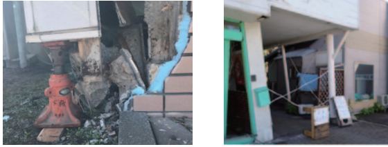
(b) ジャッキによる支持 (c) 傾斜した柱 写真 3.1.7 建築物⑥の被害状況
