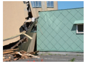
(f) 隣接建築物との衝突部分
