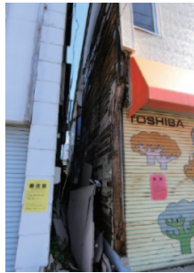
写真 3.3.27 写真 3.3.25 右端の外壁の激しい腐朽と残留変形
