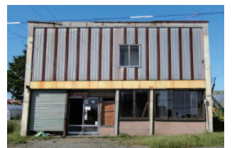
写真 3.3.38 残留変形が見られる店舗併用住宅
