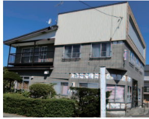
写真 3.1.19 旧国道である中央通り以外で一部損壊した店舗併用住宅
