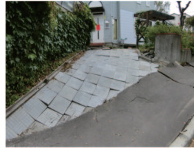
写真 4.12 敷地入口が約 1.5 m 沈下した住宅
