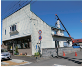
写真 3.1.18 煙突の崩壊の可能性により応急危険度判定の結果が‘危険’の店舗併用住宅
