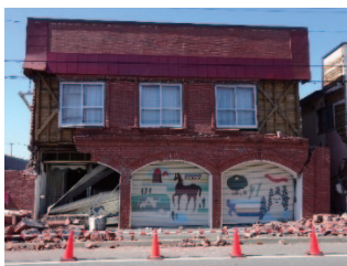
写真 3.3.11 外壁煉瓦の木造建築物の被害
