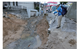
写真 4.5 道路にできた約1.5mの段差
