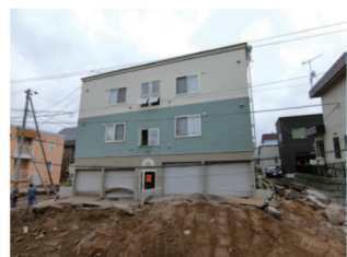
写真 4.7 流出土砂が数十cm堆積し、前面の路盤が沈下、又は削られた住宅
