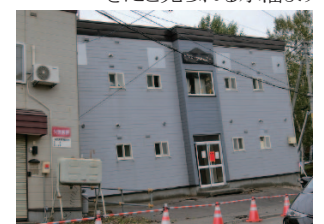
写真 4.4 大きく傾いたものの上部構造に目立った被害が認められない住宅
