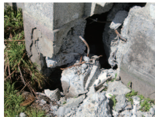
(c) 破壊部分の詳細 (底部)
