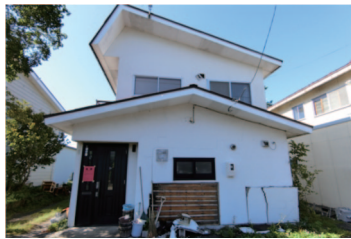
写真 3.3.30 応急危険度判定の結果が“危険”のモルタル外壁の専用住宅
