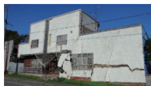
写真 3.3.41 外壁の剥落(今回の地震動による被害ではない可能性が高い)
