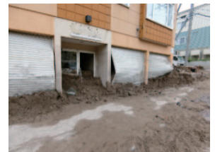
写真 4.24 シャッターを押し破って建築物内部にも堆積した土砂
