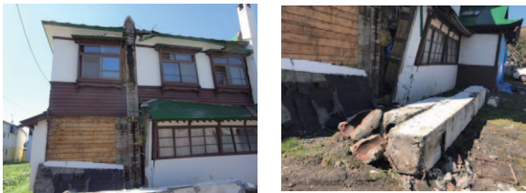
(b) 煙突の倒壊 写真 3.1.11 建築物10の被害状況
