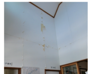
(b) 内部仕上材の損傷
