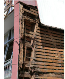
(f) 柱等の腐朽・蟻害
