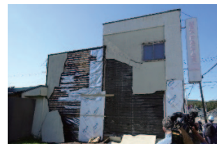
写真 3.3.21 外装材の脱落した建築物
