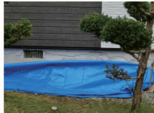
写真 4.14 ひび割れの入った基礎
