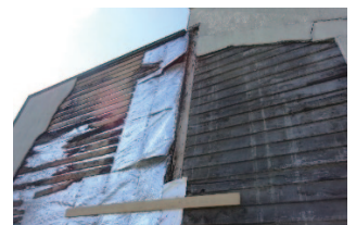
写真 3.3.22 写真 3.3.21 の壁面（柱・壁の腐朽）
