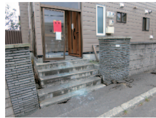
写真 4.21 著しい地盤変状で基礎の沈下、建具の破損等の被害を受けた住宅
