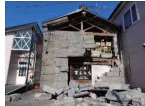
写真 3.3.17 比較的古い組積造の壁の崩落
