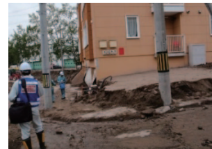
写真 4.23 流出した土砂の堆積状況
