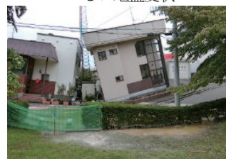
写真 4.3 最大傾斜(建築物全体)を有すると見られる住宅
