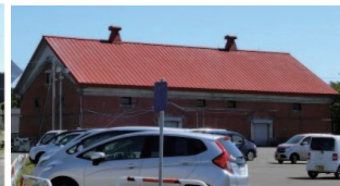
写真 3.2.21 外観上無被害に見受けられる組積造による大規模倉庫
