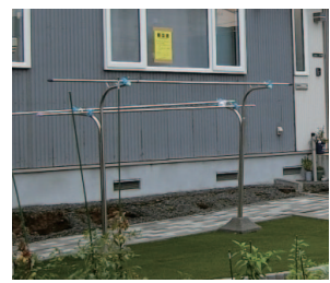
写真 4.16 地盤が沈下しているにもかかわらず、ほぼ無被害に見える基礎
