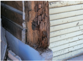
写真 3.3.26 写真 3.3.25 右端の柱脚の激しい腐朽
