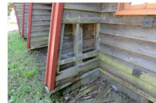
(c) 下見板の脱落 (今回の被害かどうかは不明)
