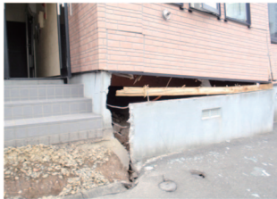
写真 4.13 地盤沈下による基礎の被害
