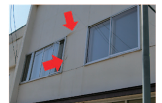
写真 3.3.24 写真 3.3.23 の壁面のひび割れ
