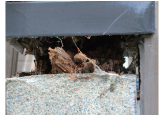
写真 4.22 写真 4.21 の住宅の土台の腐朽
