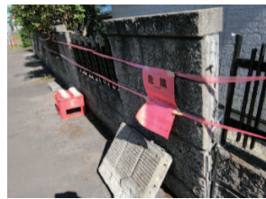
写真 3.3.29 写真 3.3.28 に附属し、傾斜したブロック塀
