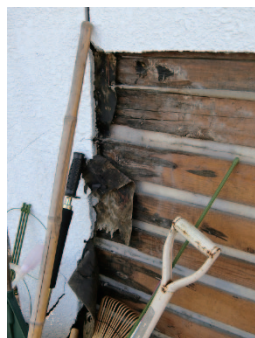
写真 3.3.32 写真 3.3.30 の外壁モルタルの剥落とその下地の腐朽
