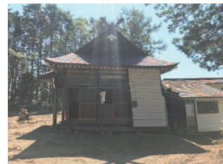
写真 3.2.11 寺社建築 C 北側の破壊状況
