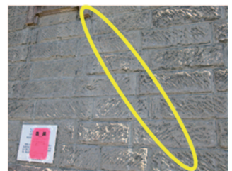
写真 3.3.20 写真 3.3.19 前面のせん断ひび割れ
