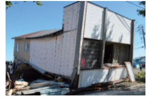
(b) 2階が東側へ倒れた正面部分
