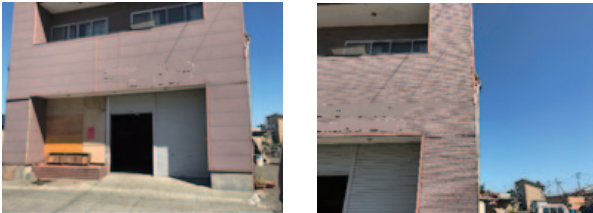
(b) 傾斜の様子 (c) 2Fのずれ 写真 3.1.8 建築物⑦の被害状況
