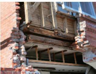
写真 3.3.13 写真 3.3.11 の露出した躯体の腐朽・蟻害
