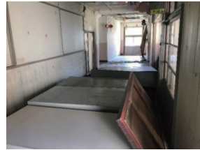
(a) 渡り廊下内部の家具等の転倒
