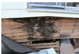
(e) 開口下部のモルタル下地板の腐朽 写真 3.1.3 建築物①の被害状況
