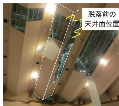
写真1 複数の勾配から成るホール天井（地震被害後）
