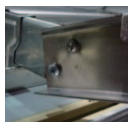
写真3 ビス2本による接合： 勾配変化部での損傷
