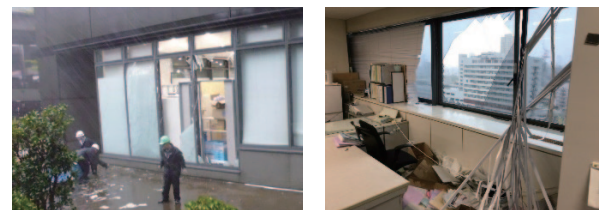
(a) 1階店舗のガラス (b) 13階の破損した窓ガラス 図3 庁舎Aの主な開口部の被害状況(当該庁舎提供)
