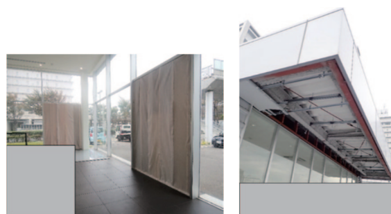
(a) 屋外（南西）に面する開放型の (b) 屋上階段室の軒天井 建具の脱落
