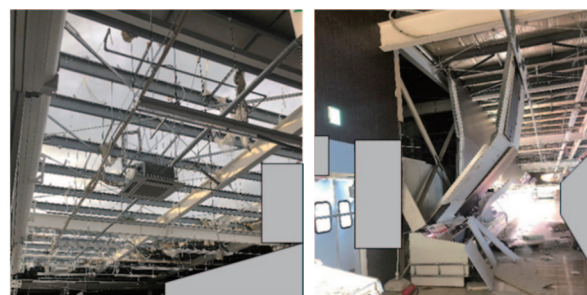
(a) 鋼板製屋根の飛散 (b) 間仕切りの倒壊
