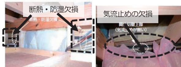
図9 壁の断熱が貼りあげられておらず断熱・防湿欠損が生じている例
