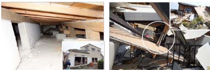
大破の建築物 基礎・地盤に著しい被害
