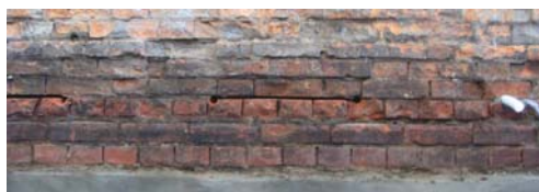
既存の目地材を切除した状況(500mm間隔で切除、第一工程で目地を置き換えた部分)
