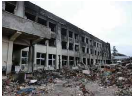
写真1 開口部から侵入した火災で3階が激しく燃えた小学校
