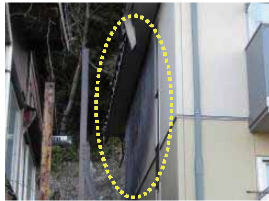
写真 3 隣棟住宅火災で焦げた外壁
