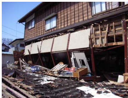
写真1 大破した比較的古い木造家屋
