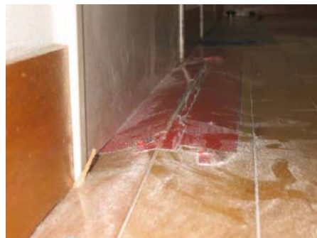
写真16 防火扉の被害
