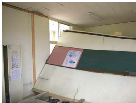
写真14 教室の間仕切り壁の転倒
