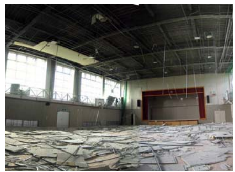
写真15 体育館天井の被害(3)
