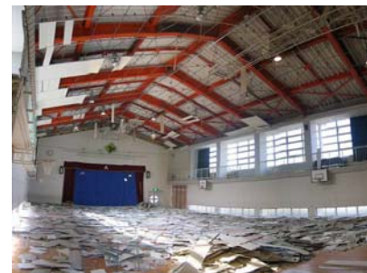
写真13 体育館天井の被害(2)
