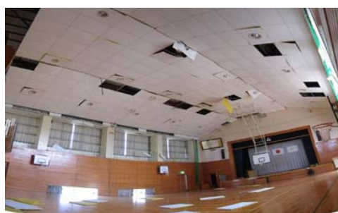
写真12 体育館天井の被害(1)
