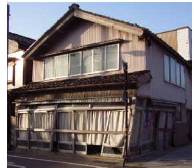
写真2 大破した店舗併用住宅
