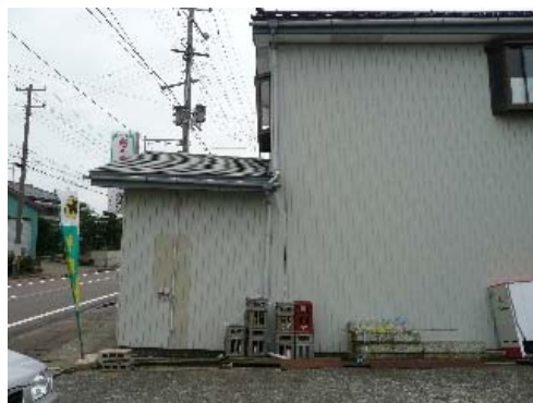
写真8 地盤変状により不同沈下した店舗併用住宅
