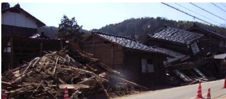
写真3 門前地区で軒並み倒壊する家屋群
