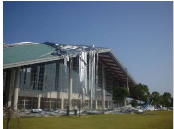
写真1 香川県立大川体育館鋼板製屋根ふき材(台風0423号 香川県大川体育館 提供)
