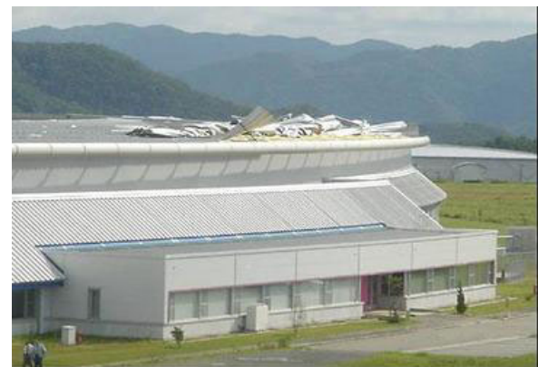
写真2 兵庫県SPring-8鋼板製屋根ふき材のはく離と飛散(台風0416号 独立行政法人理化学研究所 提供)
