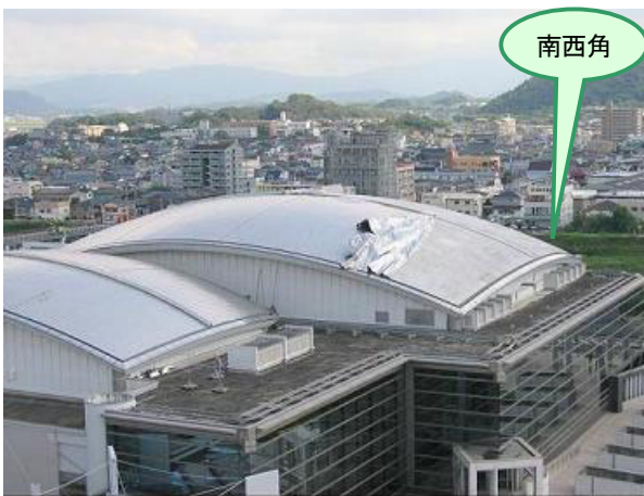
写真 3 ホール鋼板製屋根の被害直後の状況(飯塚市教育文化振興事業団 提供)
