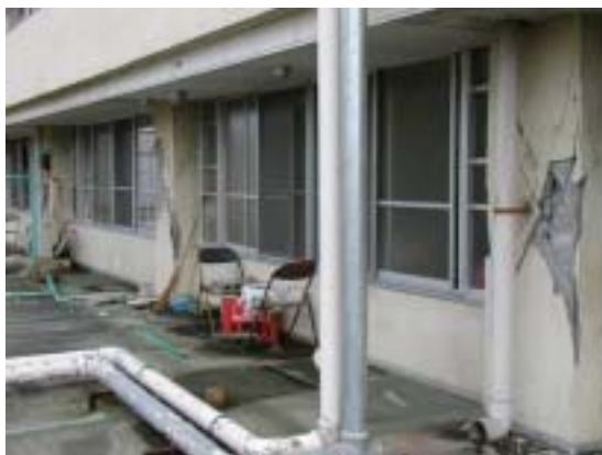
写真4 深谷病院の被害(2階柱のせん断破壊)
