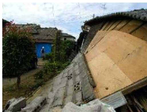
写真5 ブロック塀の被害
