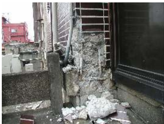
写真3 鹿島台役場の被害(柱脚の曲げ破壊)
