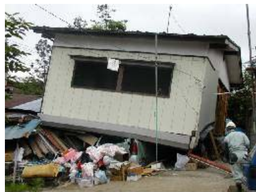
写真2 併用構造の被害(1階部分の層崩壊)
