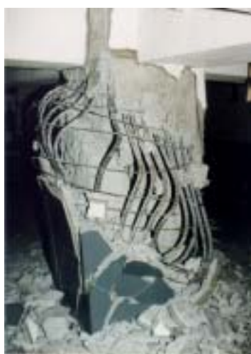
(a) 柱のせん断破壊による崩壊
