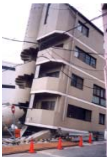
(b) 1階に過度の変形集中が生じたことによる層崩壊
