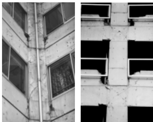
(b) 柱のせん断破壊や損傷 (c) 柱、梁、接合部の損傷
