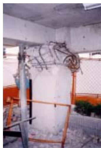
(c) 転倒モーメントによる大きな変動軸力が柱に作用したことによる崩壊
