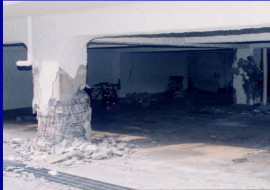
柱のせん断破壊
