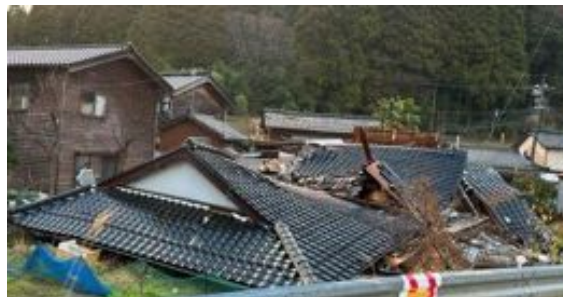
写真 6.4.2 穴水町鹿島の倒壊家屋群
