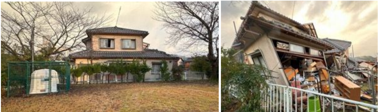
写真 6.4.10 K-NET 穴水の設置状況と近接する住宅の被災状況
