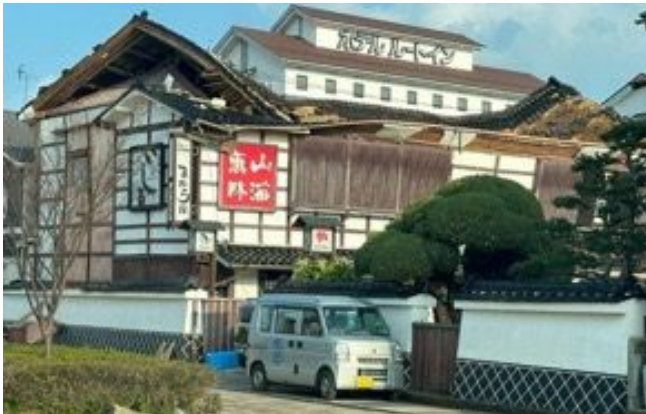
写真 6.1.7 小屋組のみが崩壊した店舗
