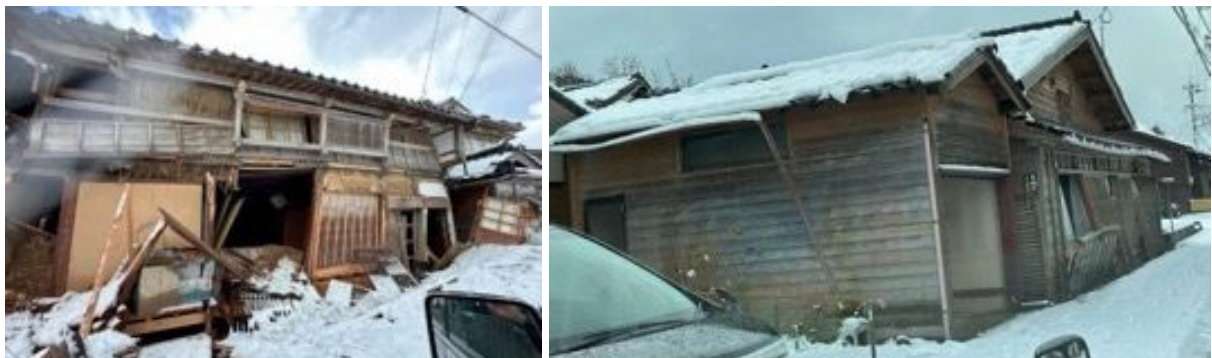
写真 6.2.14 一部は安全限界変形を超えるような大きな残留変形がある家屋（門前町黒島）
