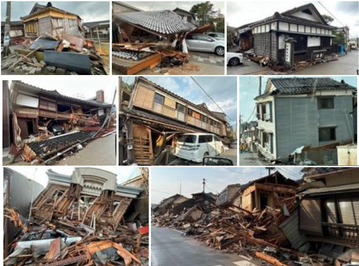
写真 6.1.9 鳳至町の倒壊家屋群
