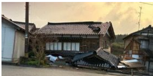
写真 6.4.3 穴水町曾福の倒壊家屋
