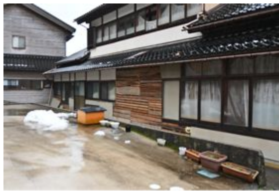
写真 6.7.2 外壁の剥落した木造住宅
