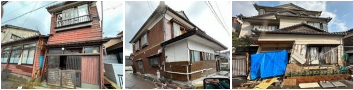
写真 6.1.10 一部は安全限界変形を超えるような大きな残留変形のある住宅（鳳至町）
