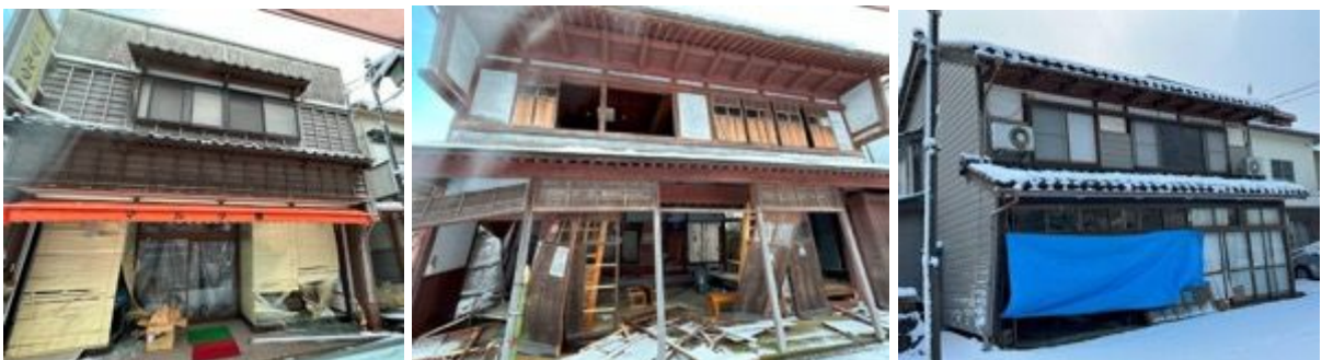
写真 6.2.2 一部は安全限界変形を超える大きな残留変形のある家屋（門前町門前）
