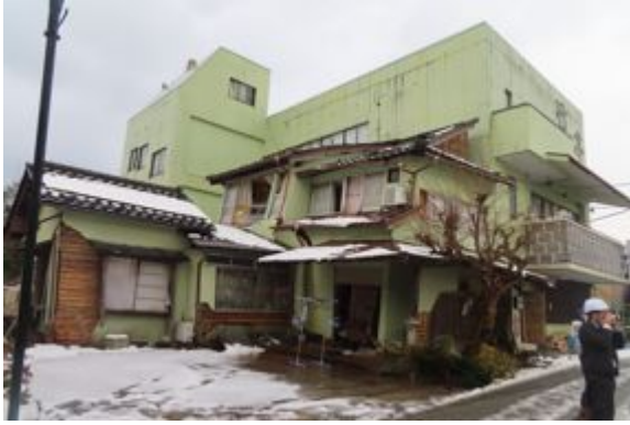
写真 6.4.11 2階が損傷した木造住宅
