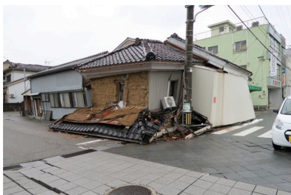
写真 6.7.7 倒壊した木造住宅
