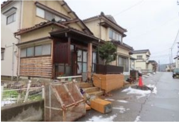
写真 6.6.1 外壁が剥落した木造住宅
