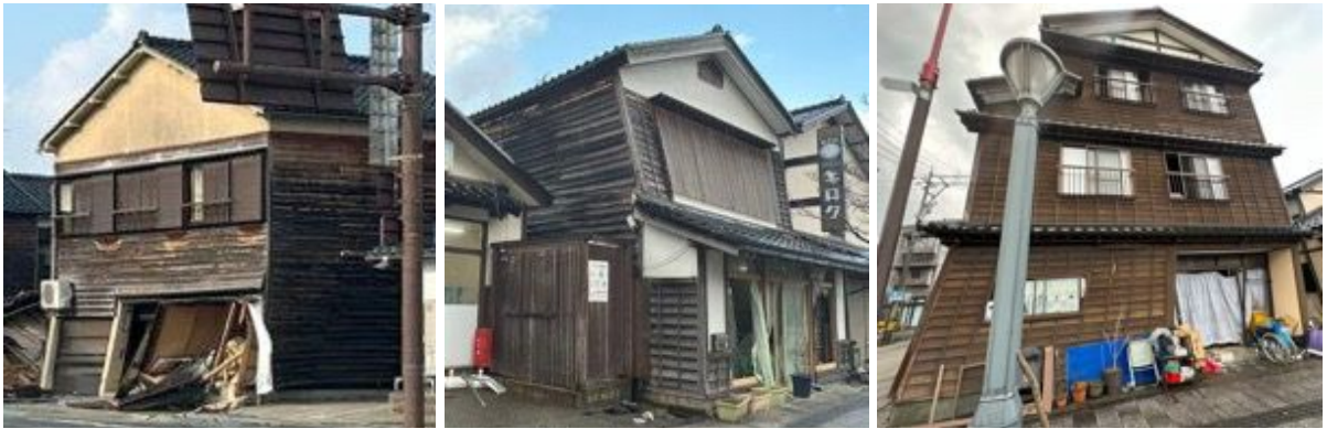
写真 6.1.2 一部は安全限界変形を超えるような大きな残留変形のある家屋
