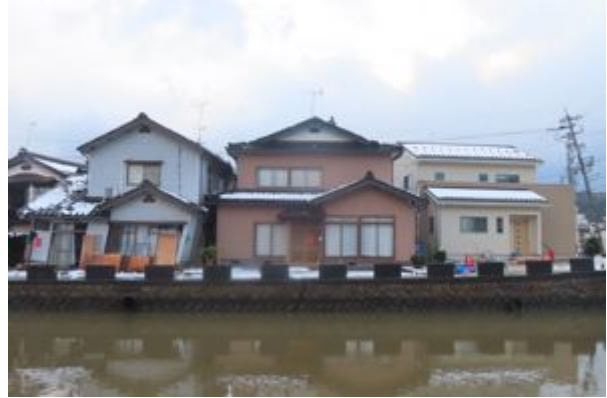
写真 6.4.12 大きく傾斜した木造住宅 (左)
