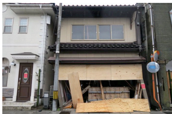
写真 6.7.8 大きく傾斜した木造店舗併用住宅
