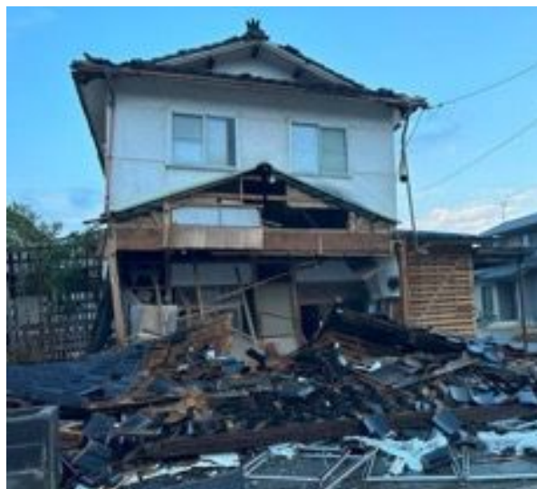
写真 6.4.6 傾斜が残る住宅(穴水町川島)
