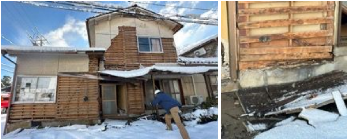
写真 6.2.5 モルタル外壁が大規模に剥落した住宅とその土台の腐朽
