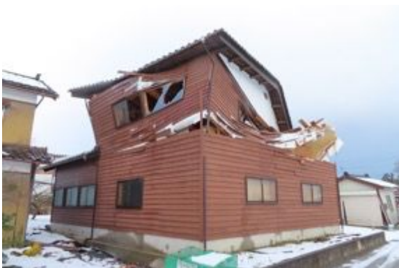
写真 6.3.25 2層が崩壊した木造住宅
