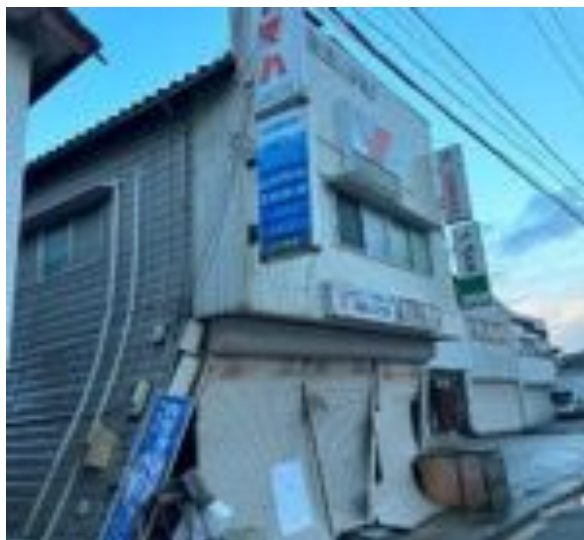
写真 6.4.5 傾斜が残る店舗併用住宅(穴水町川島)
