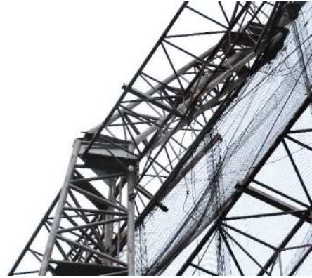
写真 3.35 被害部分の拡大写真(2) (北側の鉄柱)
