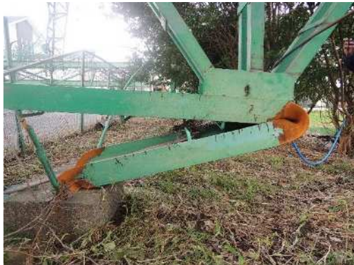
写真 3.6 鉄柱を構成するH形鋼の変形(2)
