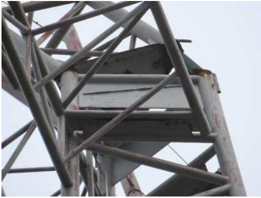
写真 3.34 被害部分の拡大写真(1) (北側の鉄柱)
