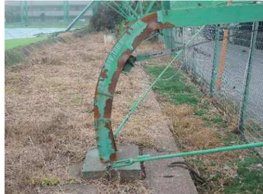
写真 3.7 鉄柱を構成するH形鋼の変形(3)
