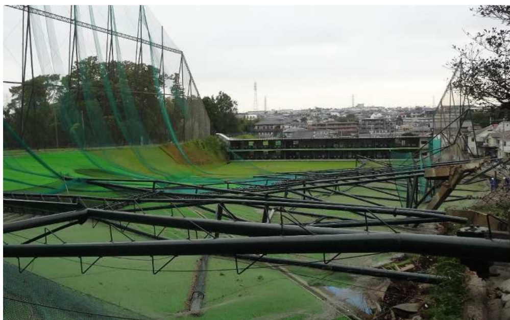
写真 3.15 鉄柱の倒壊状況(1)
