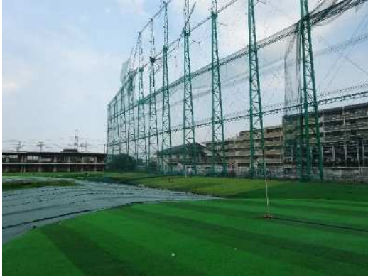
写真 3.10 敷地をはさんで倒壊した鉄柱の反対側にある鉄柱の状況
