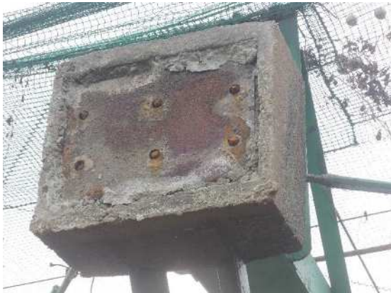
写真 3.4 柱脚アンカーボルトの破断(2)
