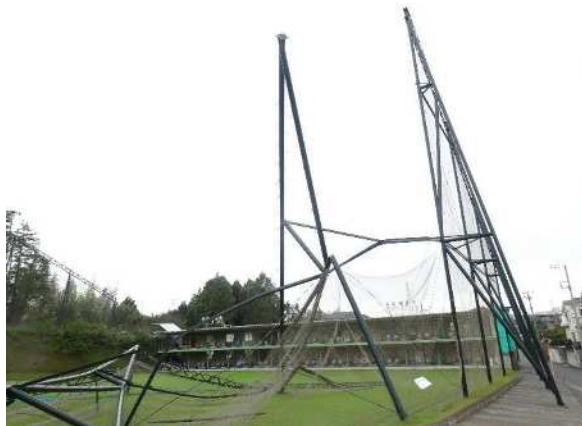
写真 3.16 鉄柱の倒壊状況(2)
