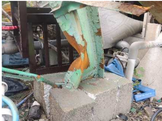
写真 3.5 鉄柱を構成するH形鋼の変形(1)
