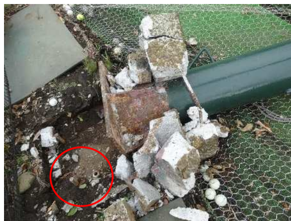
写真 3.21 柱脚のコンクリートの破壊 (写真 3.20 のアンカーボルトは赤丸部)
