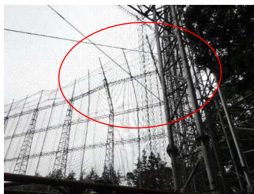
写真 3.29 先端部の被害状況(1)(北側)
