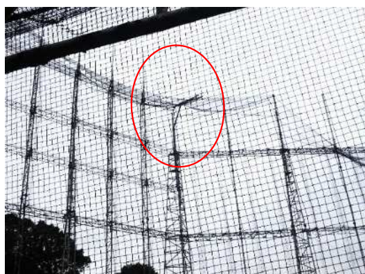
写真 3.30 先端部の被害状況(2)(南側)
