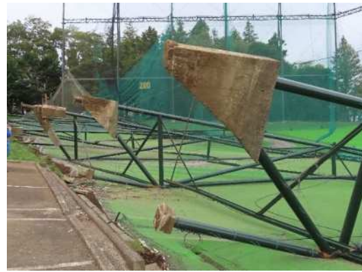
写真 3.23 引き抜けた柱脚(1)
