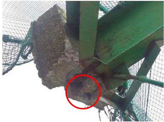
写真 3.3 柱脚アンカーボルトの破断(1)
