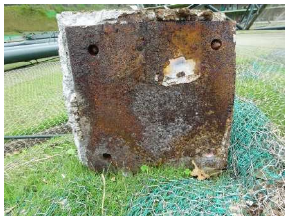
写真 3.19 ベースプレートとアンカーボルト(2)
