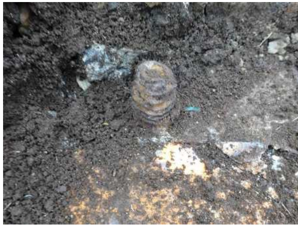
写真 3.22 破断したアンカーボルト
