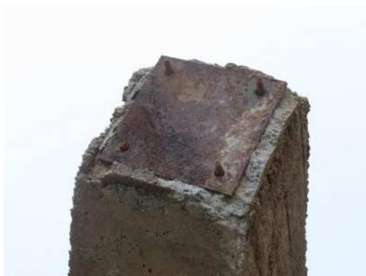
写真 3.18 ベースプレートとアンカーボルト(1)
