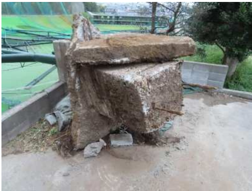
写真 3.24 引き抜けた柱脚(2)
