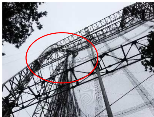
写真 3.33 先端部の変形(北側の鉄柱)
