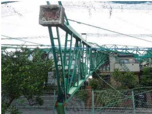
写真 3.8 隣接する住宅への倒壊状況
