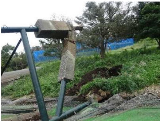
写真 3.26 写真 3.25 の引き抜け部分
