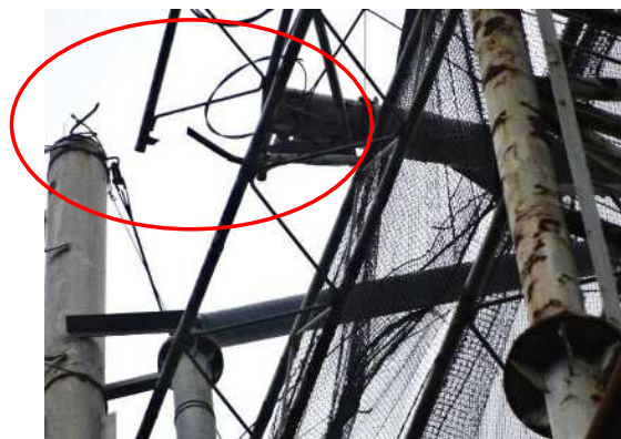
写真 3.32 折損した鉄柱(2)(南側の鉄柱)
