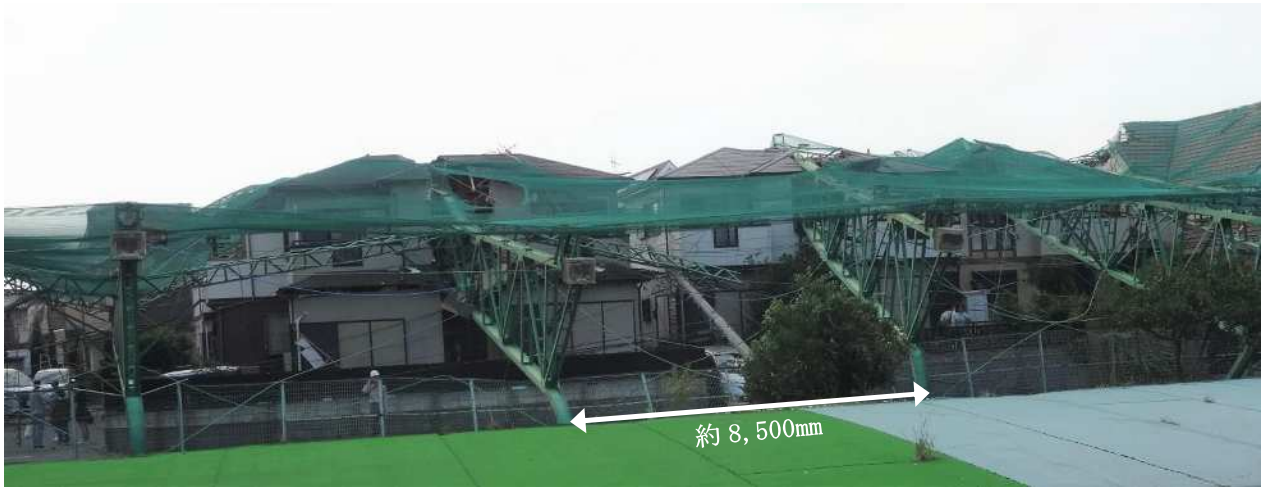
写真 3.1 鉄柱の倒壊状況
