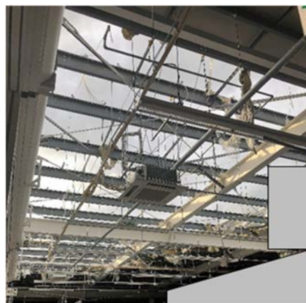
写真 4.16 鋼板製屋根の飛散 (当該店舗提供)
