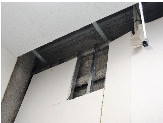
写真 4.6 北西側の内壁の損傷 1
