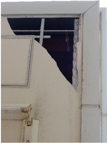
写真 4.44 軒天井の隅角部での損傷
