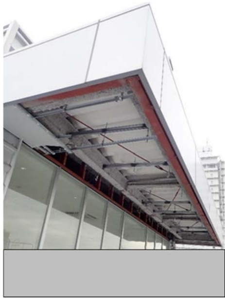
写真 4.28 屋上階段室の軒天井の脱落
