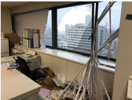
写真 3.9 13階の破損した窓ガラス (当該庁舎提供)
