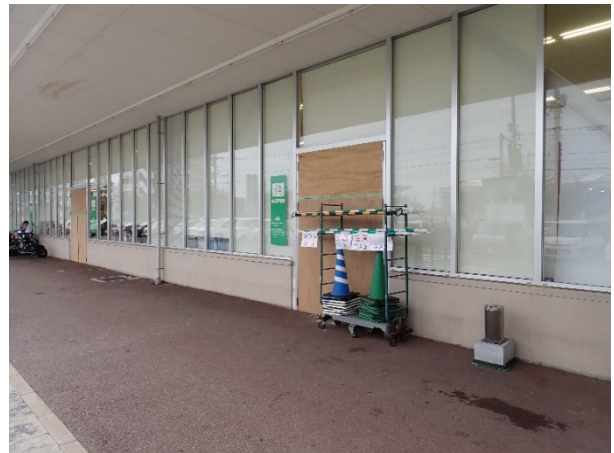
写真 4.45 南西側のガラス扉の損傷
