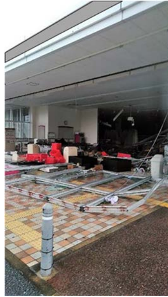
写真 4.37 南西に面する建具の脱落・ 屋外への転倒(当該店舗提供)
