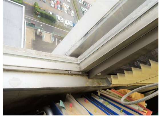
写真 3.17 庁舎Dの10階で破損した窓ガラスの サッシ (復旧済み)
