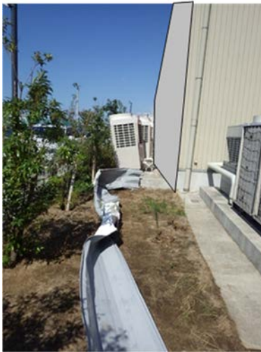
写真 4.10 鋼板製屋根材の脱落 (当該店舗提供)
