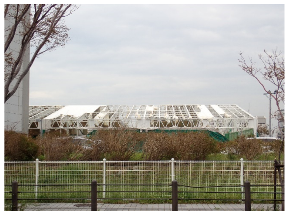
写真 4.35 屋根に張った膜材料の破損状況
