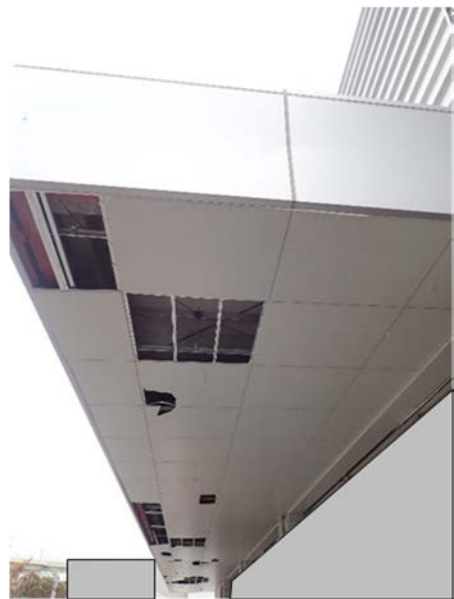
写真 4.26 軒天井の損傷 1
