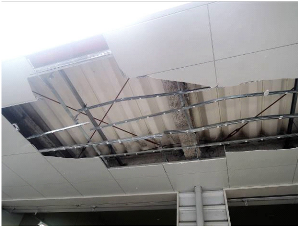
写真 4.27 軒天井の損傷 2
