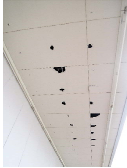
写真 4.43 軒天井の損傷
