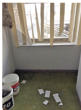
写真 3.15 庁舎Eの2階で破損した窓ガラス（当該庁舎提供）
