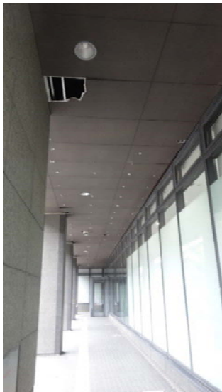
写真 3.3 1階の軒天井の持ちあがり
