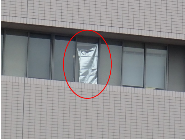
写真 4.50 医療施設での窓ガラスの損傷
