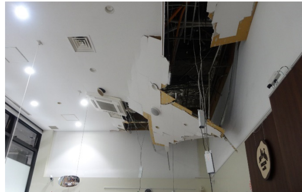
写真 3.4 1階店舗の天井の被害
