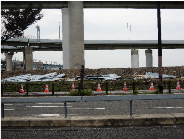
写真 4.52 海に面した工事現場の囲いの飛散
