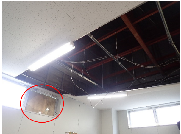
写真 4.30 1階倉庫の窓ガラスの破損（仮修復済み）と天井の脱落 1
