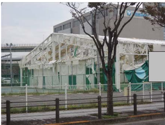
写真 4.34 壁に張った膜材料の破損状況
