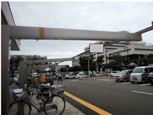
写真 4.12 駐輪場の屋根材の損傷 (店舗Aの南東側)
