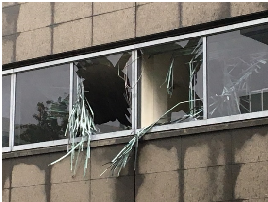
写真 3.7 2階窓ガラスの破損 (当該庁舎提供)
