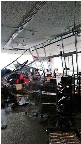
写真 4.40 建具の脱落・転倒とカート等の移動 (当該店舗提供)
