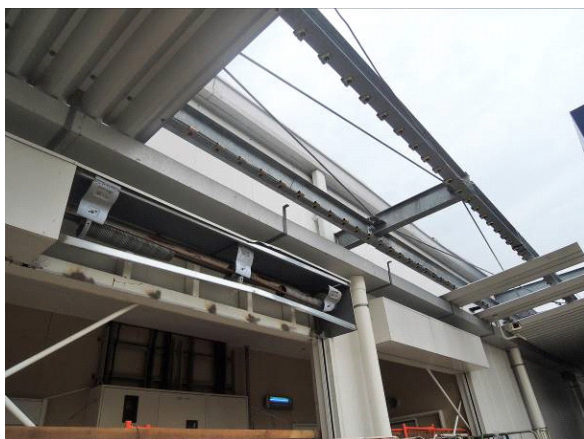
写真 4.21 庇の屋根材の脱落とシャッターの損傷
