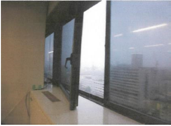
写真 3.13 15 階窓枠の外れ（当該庁舎提供）
