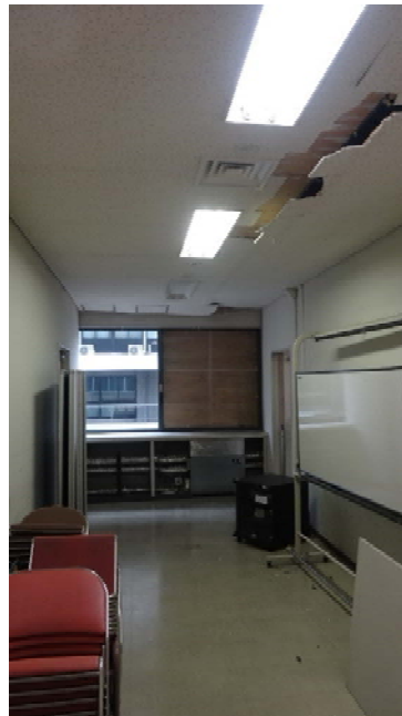
写真 3.8 窓ガラスが破損した2階室内
