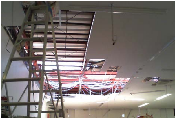
写真 4.8 店舗内天井と屋根の損壊状況 (当該店舗提供)
