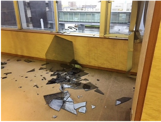
写真 3.16 庁舎Fの3階で破損した窓ガラス (当該庁舎提供)
