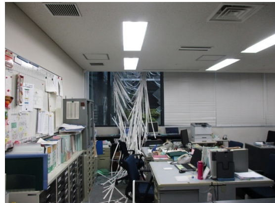
写真 3.6 窓ガラスが破損した1階室内 (当該庁舎提供)
