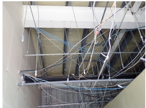
写真 4.20 倉庫・事務室での天井の脱落
