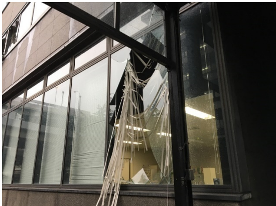
写真 3.5 1階窓ガラスの破損 (当該庁舎提供)
