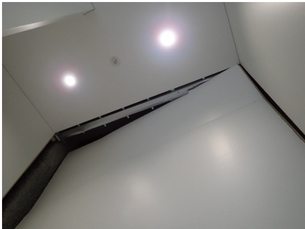
写真 4.29 階段室内の間仕切の損傷
