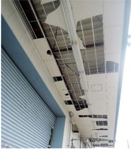
写真 4.46 軒天井の損傷
