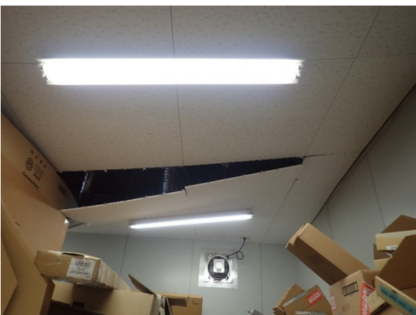
写真 4.31 1階倉庫の天井の脱落 2
