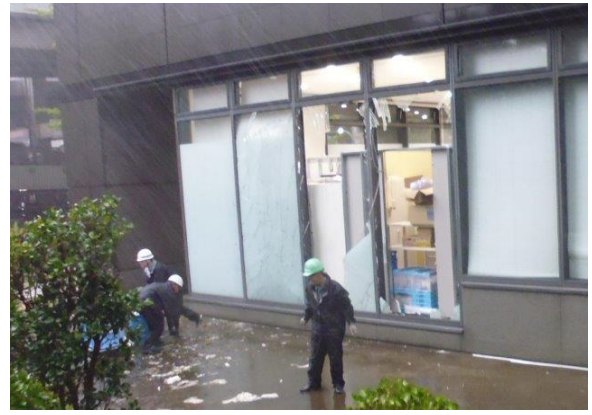
写真 3.2 1階東面窓ガラスの破損 (当該庁舎提供)
