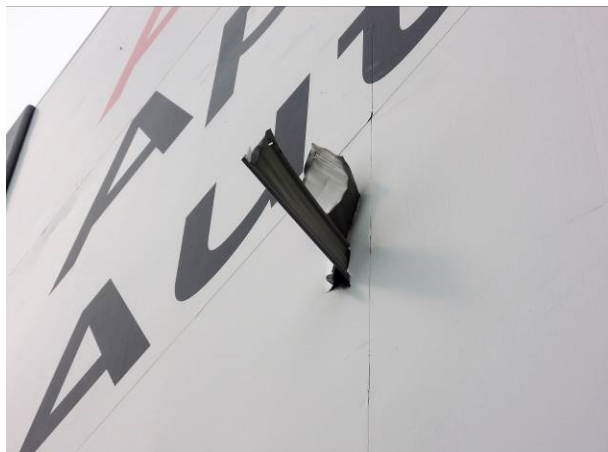
写真 4.32 看板への飛来物の突き刺さり
