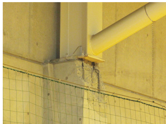
写真 4.1.2-2 支承部のコンクリートの側方破壊
