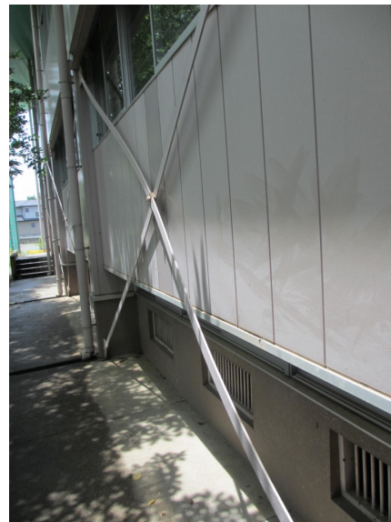
写真 4.1.6-2 平鋼ブレースのたわみ
