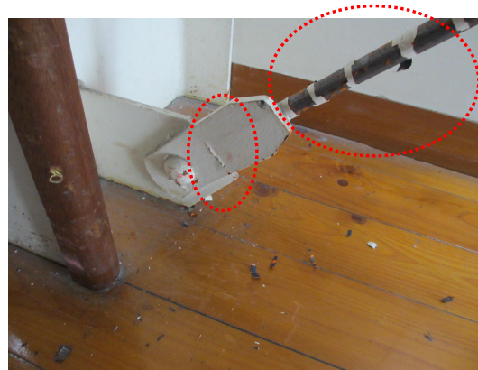
写真 4.1.9-4 ブレース端部の塑性化と羽子板の曲がり
