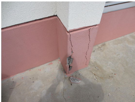
写真 4. 1. 1-9 柱脚部のコンクリートひび割れ
