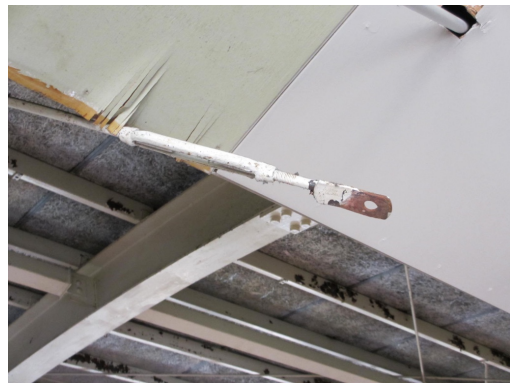
写真 4. 1. 1-6 屋根面水平ブレースのボルト破断
