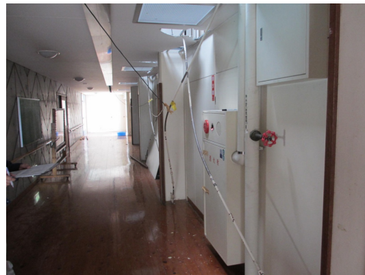
写真 4.1.9-2 1階の大きくたわんで変形したブレース
