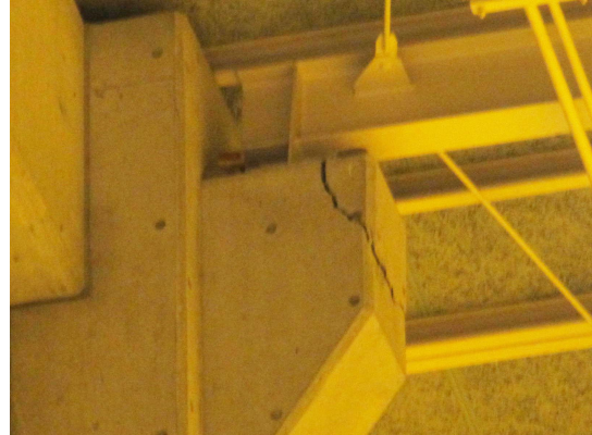
写真 4.1.2-4 支承部のコンクリートのひび割れ
