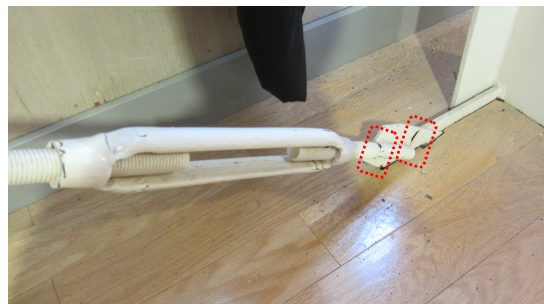
写真 4. 1. 4-6 鉛直ブレース（2階）の軸部 及び羽子板の変形
