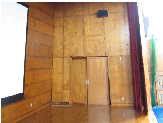
写真 4.1.9-7 舞台壁の損傷、引き戸の外れ
