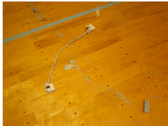
写真 4.1.2-6 落下した吊り金具
