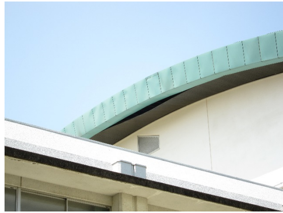
写真 4.1.14-12 軒天の部分的な垂れ下が
