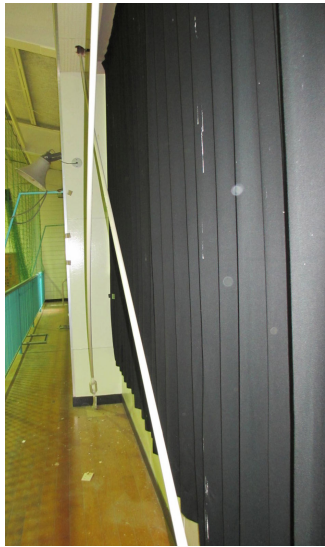
写真 4.1.6-11 2階ブレースのわずかなたわみ
