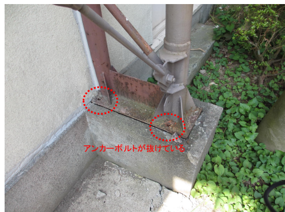
写真 4.1.13-4 柱脚のアンカーボルトの破断
