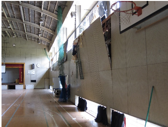
写真 4.1.1-11 損傷して傾いた内壁
