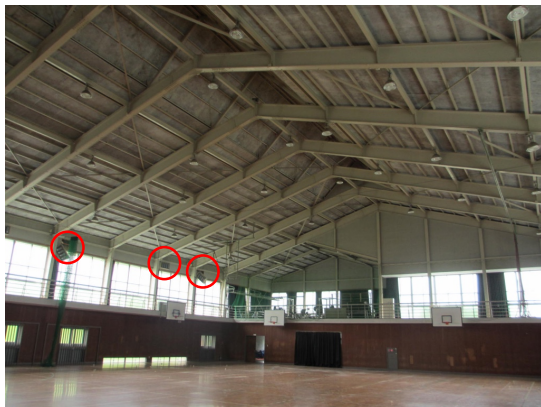
写真 4.1.5-1 内観（赤円内が安定器を留め付けた板が外れた箇所）
