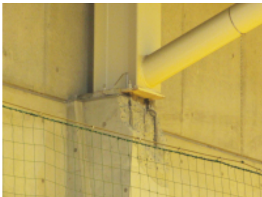
写真 4.2-13 体育館Bの屋根支承部のコンクリートの側方破壊
