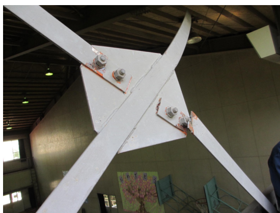
写真 4.2-3 体育館Oのブレース孔欠損部の破断
