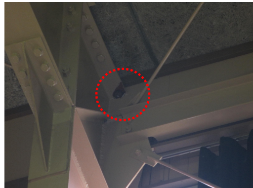
写真 4. 1. 11-6 取り替えられていない屋根面水平ブレースのボルト破断
