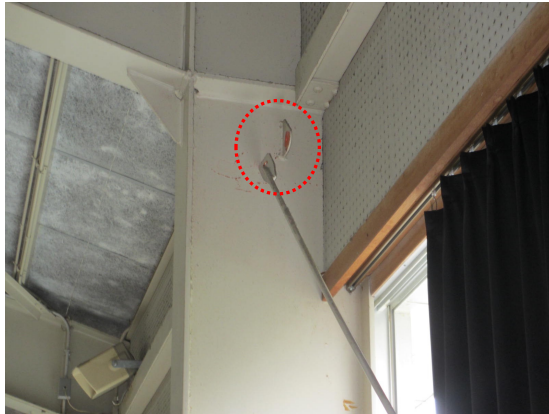
写真 4.1.5-3 鉛直ブレースのボルト破断
