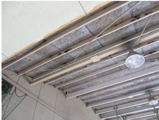
写真 4. 1. 1-5 屋根面水平ブレースの曲がり
