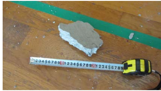
写真 4.1.12-9 落下していたモルタル
