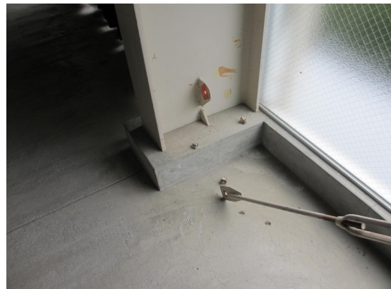
写真 4.1.5-2 鉛直ブレース接合部のボルトの破断
