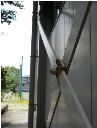
写真 4.1.6-7 ブレースのたわみ
