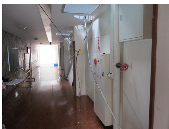
写真 4.2-4 体育館Iのブレースの大きなたわみ及び伸び
