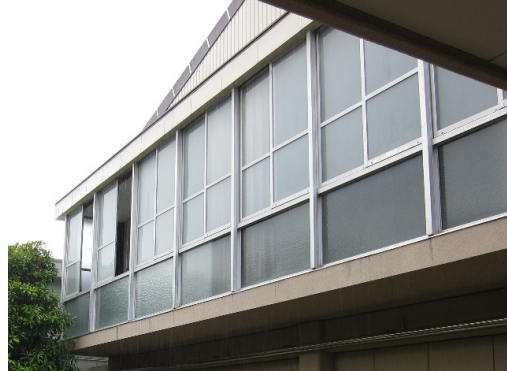
写真 4.1.5-7 窓ガラスの被害
