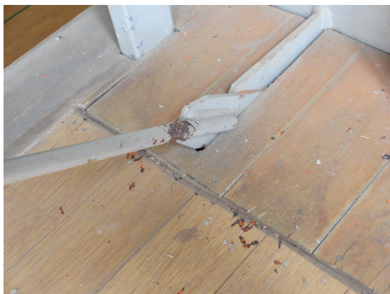
写真 4.1.1-3 ブレース端部の塑性化
