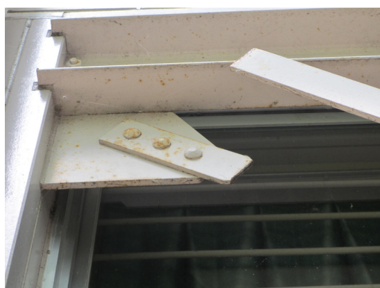
写真 4.2-2 体育館Fの母材破断
