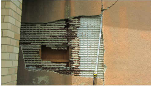
写真 4.1.8-8 入り口脇の外壁モルタルの落下
