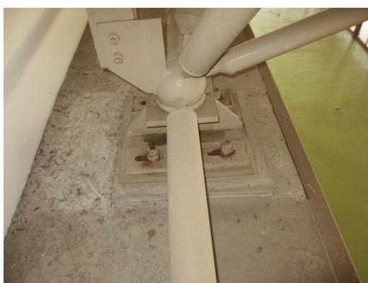
写真 4.1.14-9 建物桁行構面は長孔の支承部で長孔の端までボルトが移動
