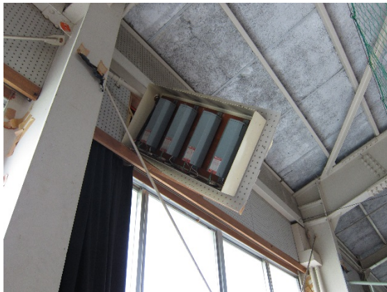
写真 4.1.5-8 安定器を留め付けた板の外れ
