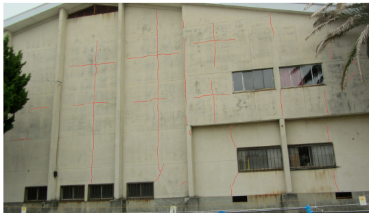
写真 4.1.7-9 舞台裏妻面（仕上げモルタルにひび割れ（赤線））
