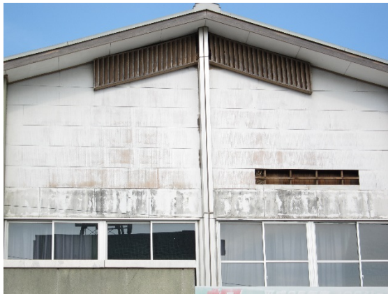
写真 4. 1. 11-7 妻面の外装材の脱落
