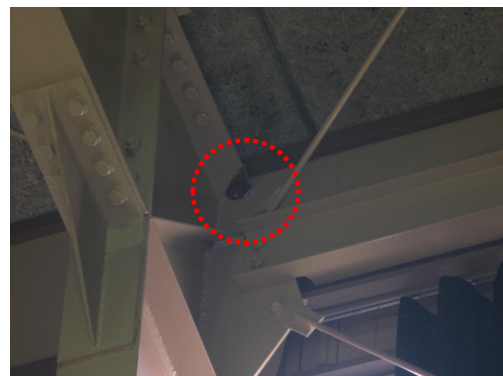
写真 4.2-8 体育館Kの屋根面水平ブレースのボルト破断
