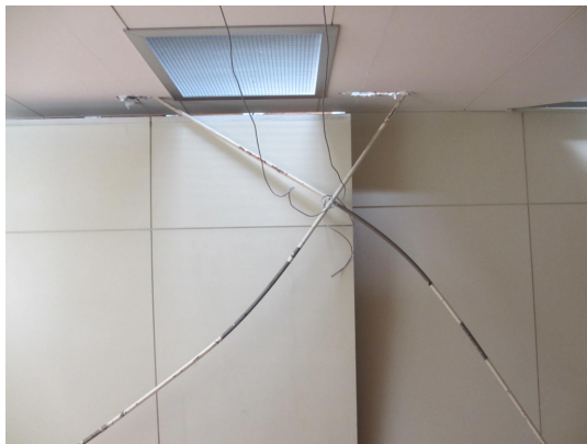
写真 4.1.9-5 ブレースの変形状況
