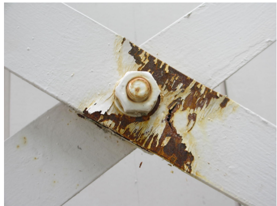
写真 4.1.6-8 ブレース交差部の塑性化と破断
