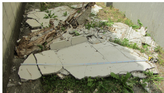
写真 4.1.3-10 左の壁面から脱落したモル タル（厚さ約 3.5cm）
