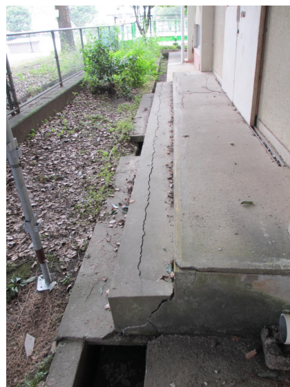
写真 4. 1. 1-10 周辺地盤の沈下
