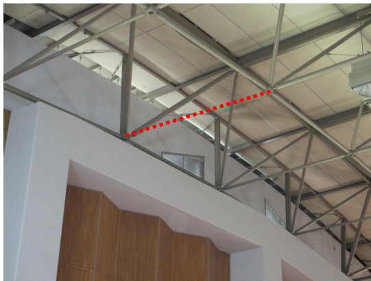
写真 4.1.14-3 落下したトラス部位
