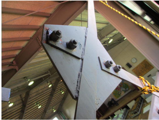
写真 4. 1. 15-3 孔欠損部近傍での破断
