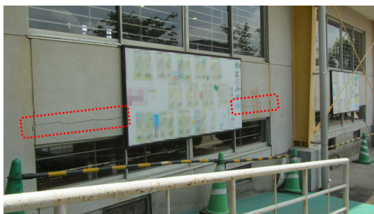
写真 4.1.8-7 1階外壁の水平なひび割れ
