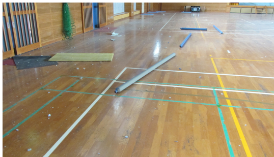
写真 4. 1. 12-5 落下した立体トラスの部材
