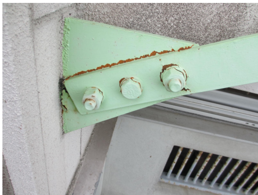
写真 4.1.10-3 ブレース接合部におけるブレースのわずかな滑り
