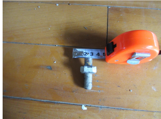
写真 4. 1. 1-8 破断した屋根面水平ブレースのボルト
