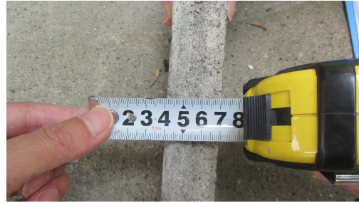
写真 4.1.8-9 左の落下したモルタル(厚さ約3cm)
