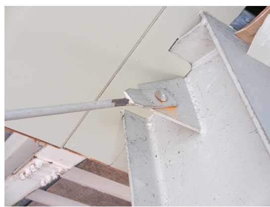
写真 4.1.1-4 ガセットプレートの曲がり
