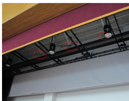
写真 4.1.14-10 ステージ上の下屋の支承部コンクリートの破損
