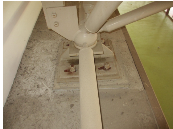
写真 4.2-16 体育館Nの桁行き構面の屋根根支承部（長孔の端までボルトが移動）
