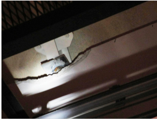
写真 4.2-15 体育館Nのステージ上の屋根根支承部のコンクリートの破壊
