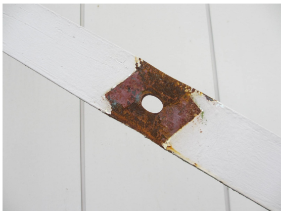
写真 4.1.6-9 ブレース交差部の伸び
