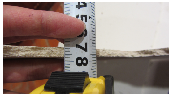
写真 4.1.7-6 落下した舞台上部内壁の仕上げ材
