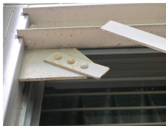
写真 4.1.6-4 平鋼ブレースの端部での破断 (写真 4.1.6-3 の拡大)
