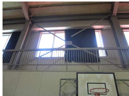
写真 4.1.15-2 2階のブレースの破断
