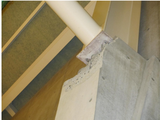
写真 4.1.2-3 支承部のコンクリートの側方破壊
