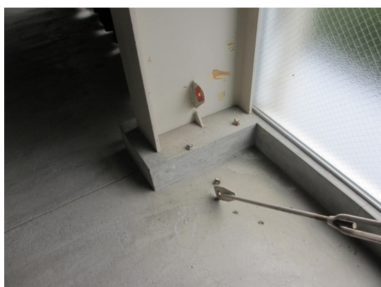
写真 4.2-1 体育館Eのボルト破断
