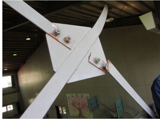
写真 4. 1. 15-4 孔欠損部での破断
