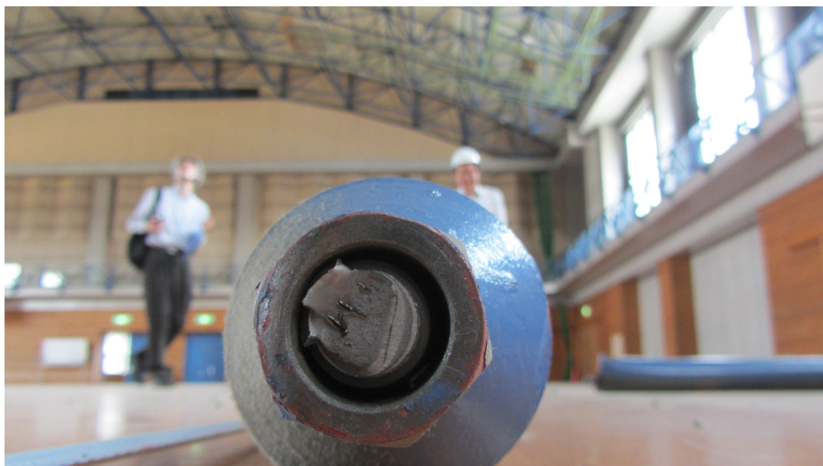
写真 4. 1. 12-7 落下した立体トラス部材の端部 (ボルトの破断)
