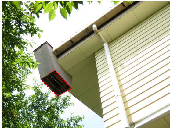
写真 4. 1. 15-9 外装材の脱落
