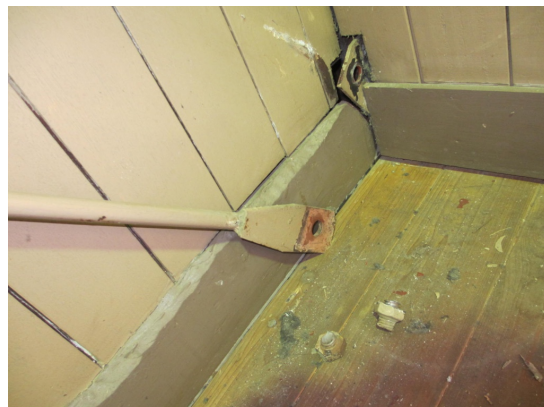
写真 4. 1. 11-2 取り替えられていない妻面 ブレースのボルト破断
