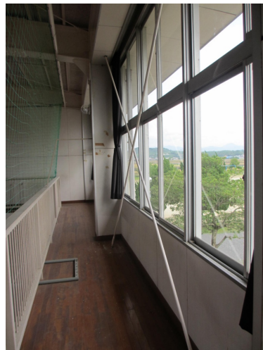
写真 4.1.10-4 2階のブレースのわずかなたわみ
