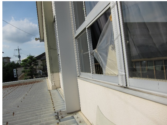
写真 4. 1. 11-8 妻面の窓ガラスの損傷
