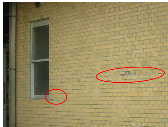
写真 4.1.6-14 外壁のひび割れ・タイル剥落（赤円内にひび割れ・タイル剥離）
