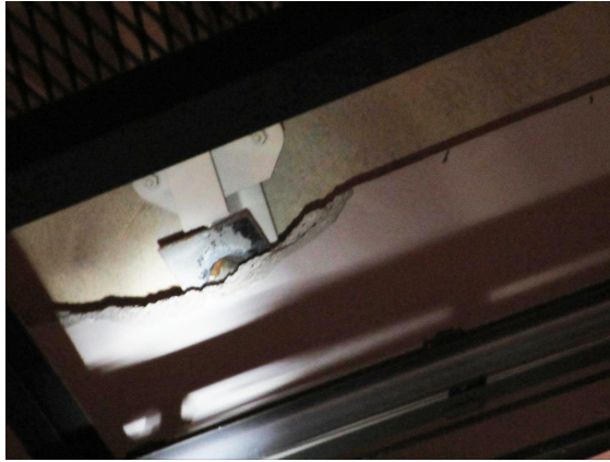
写真 4.1.14-11 ステージ上の下屋の支承部コンクリートの破損、落下
