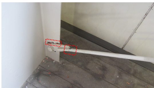
写真 4.1.8-5 2階鉛直ブレース下端接合部 塗料の剥げ、ブレースの若干の変形
