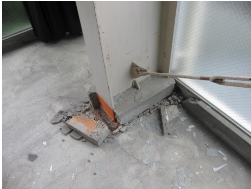
写真 4.1.5-5 柱脚部のコンクリート破壊
