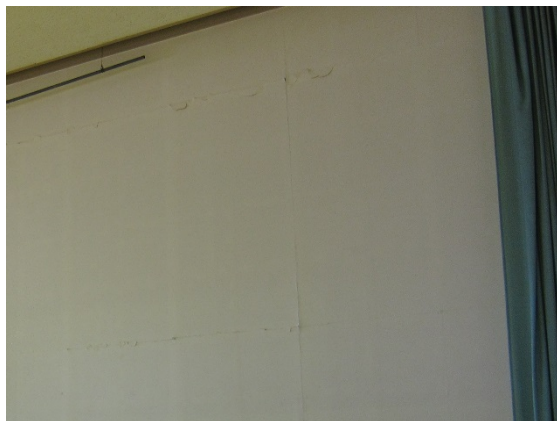
写真 4.1.6-13 舞台背面壁の仕上げボード継ぎ目のずれ
