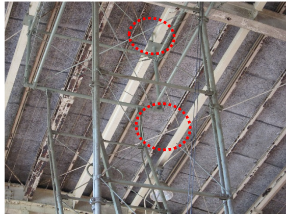
写真 4.1.1-12 損傷したバスケットゴール (赤点線箇所のテンションリングが脱落)
