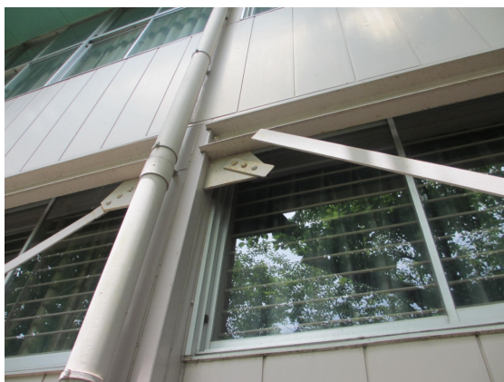
写真 4.1.6-3 平鋼ブレースの端部での破断
