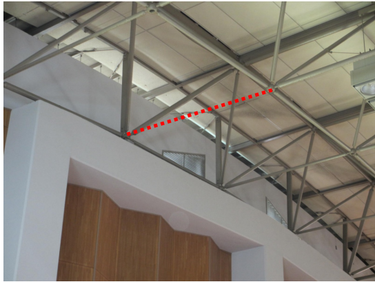
写真 4.2-11 体育館Nのトラス屋根の下弦材の落下
