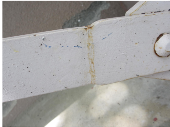
写真 4.1.6-6 ブレース母材と端部の幅広プレートの境界がわずかに降伏している (写真 4.1.6-5 の拡大)
