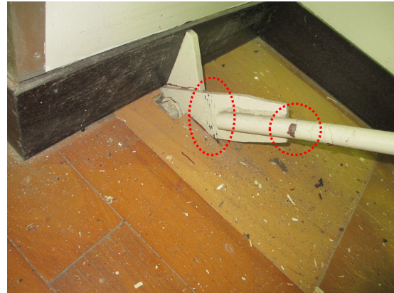
写真 4.1.6-12 2階ブレース端部の降伏とブレース端部羽子板のわずかな曲がりが見られた
