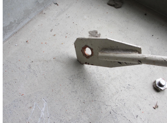
写真 4.1.5-4 鉛直ブレースのボルト破断
