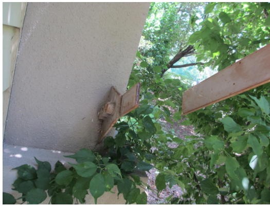
写真 4. 1. 15-5 ブレース端部での母材破断
