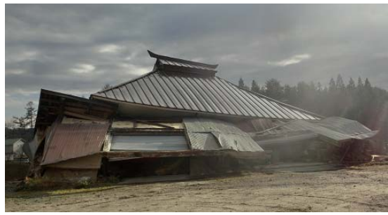
写真 5.2.5 倒壊した住宅
