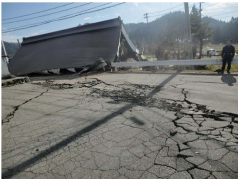
写真 5.1.4 激しく損傷した道路舗装
