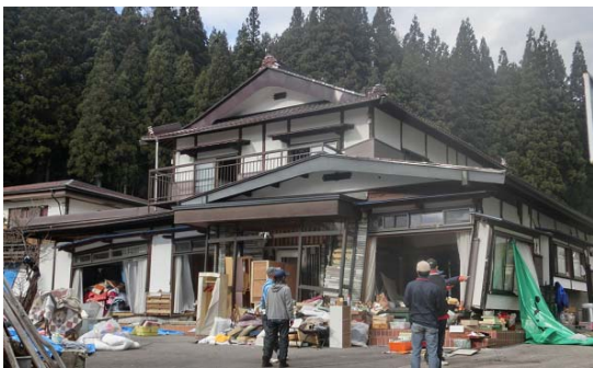
写真 5.2.12 残留変形が大きい住宅
