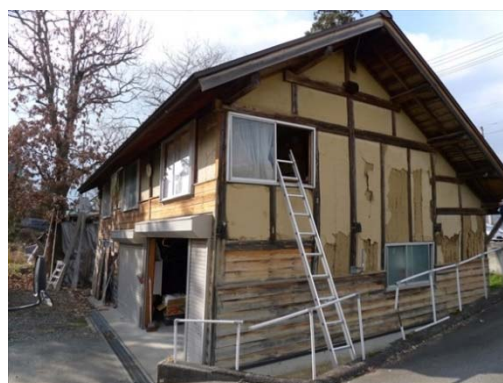
写真 5.3.23 被害を受けた倉庫
