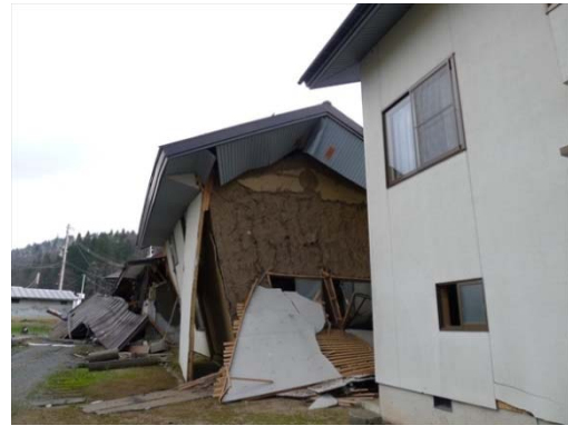
写真 5.3.4 既存部の土蔵の被害
