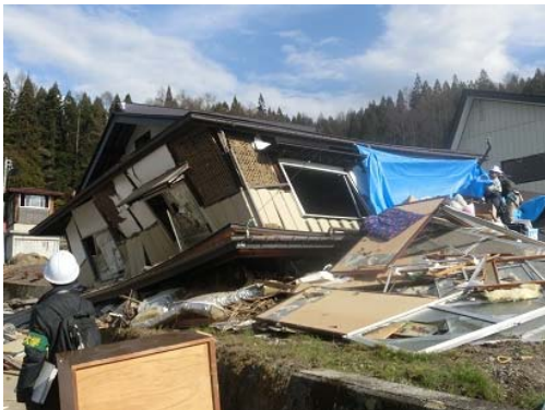
写真 5.1.16 北へ向かって倒壊した住宅
