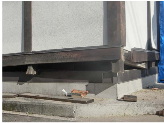
写真 5.2.11 土台を踏み外した柱脚
