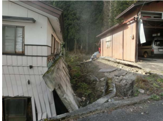
写真 5.2.7 崩壊した北側の擁壁
