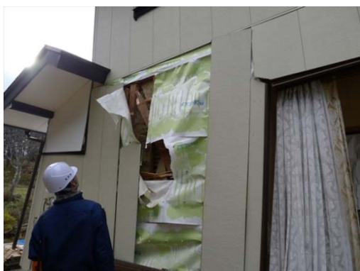
写真 5.3.10 筋かいが確認された壁の外装材の脱落
