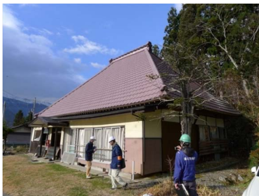
写真 5.3.17 被害を受けた平家の住宅
