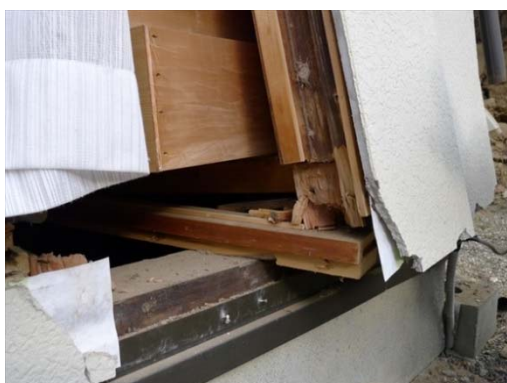
写真 5.3.8 柱の抜け出し
