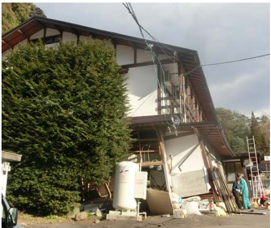
写真 5.2.8 大きく北側に傾いた住宅
