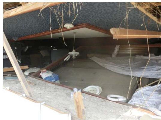
写真 5.1.11 1階に生じた空間
