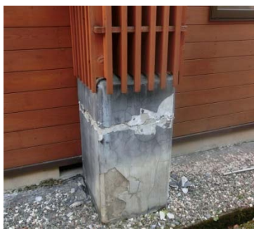
写真 5.2.3 鋼管脚部の損傷
