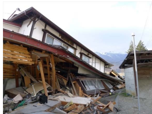
写真 5.3.2 既存部の母屋の倒壊
