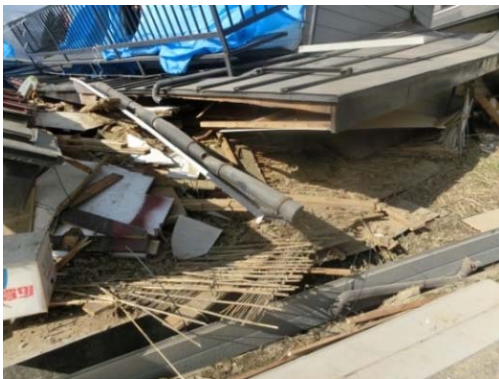
写真 5.1.14 倒壊した住宅の土塗り壁
