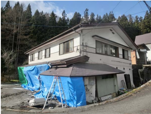
写真 5.2.6 大きく南側に傾いた住宅
