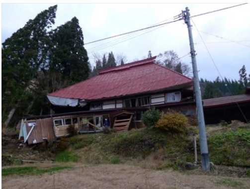
写真 6.1.1 部分的に崩壊した住宅
