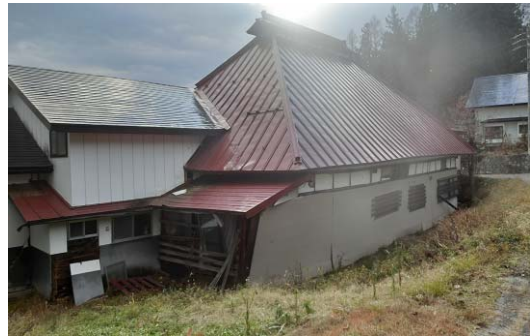
写真 5.2.13 山側への残留変形が大きい住宅
