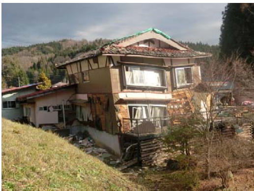
写真 5.2.16 残留変形が大きい住宅
