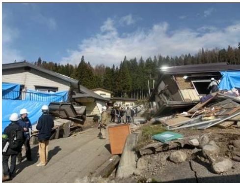
写真 5.1.2 堀之内西部の倒壊した住宅
