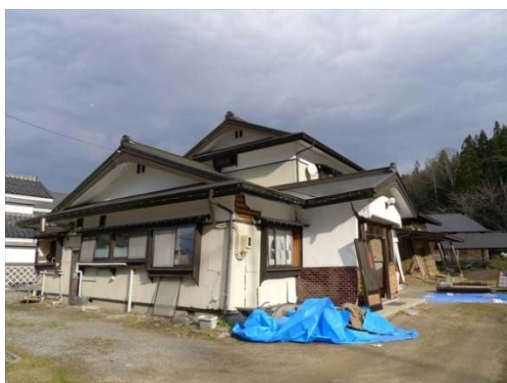
写真 5.3.6 大破した住宅
