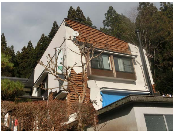
写真 5.2.9 モルタル外壁が剥落した宿泊施設
