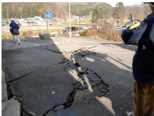
写真 5.3.20 道路の隆起によるひび割れ
