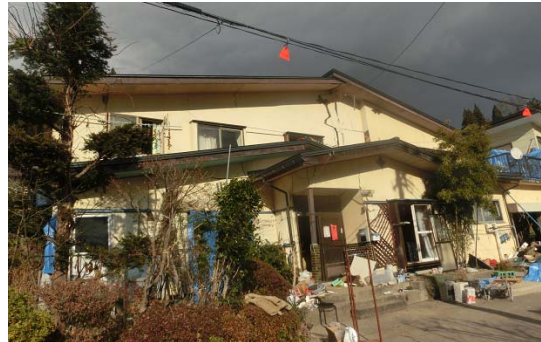
写真 5.2.15 西（写真左）へ傾斜した住宅
