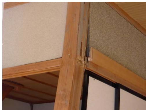
写真 5.3.7 差鴨居部での柱の折損
