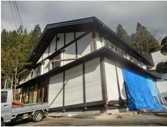
写真 5.2.10 上部構造が損傷した住宅
