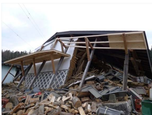
写真 5.3.22 倒壊した土蔵
