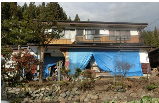
写真 5.2.14 東（写真右）へ傾斜した住宅
