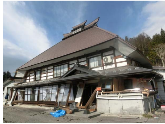
写真 5.1.21 1 階が大破した住宅
