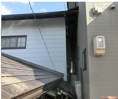
写真 5.1.10 隣家にもたれかかった2階部分
