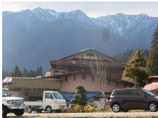
写真 5.2.17 残留変形が大きい住宅
