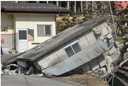
写真 5.1.24 コンクリートブロック造の崩壊
