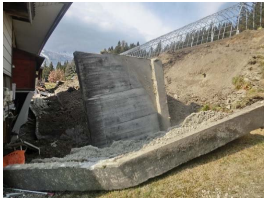
写真 5.1.23 北側の擁壁の崩壊
