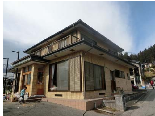
写真 5.1.19 被害が軽微な住宅
