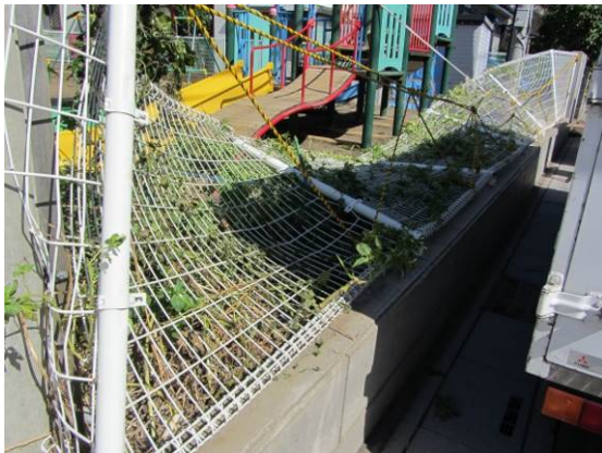
写真 4. 1. 14 フェンスの倒壊
