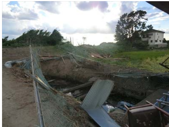
写真 5. 1. 16 フェンスの被害
