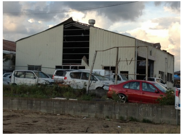
写真 5.1.8 外装材の被害
