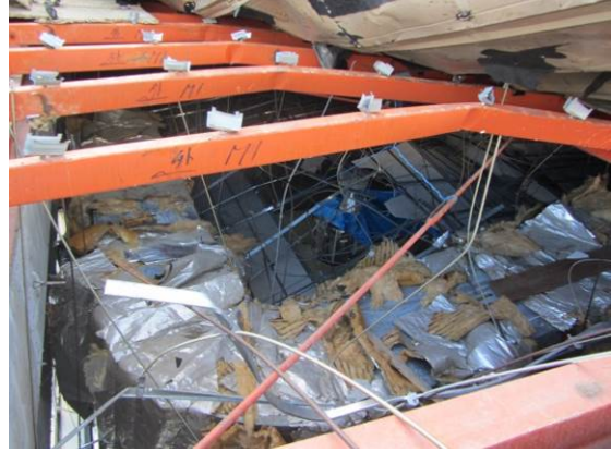
写真 4. 1. 26 母屋及び天井の破壊
