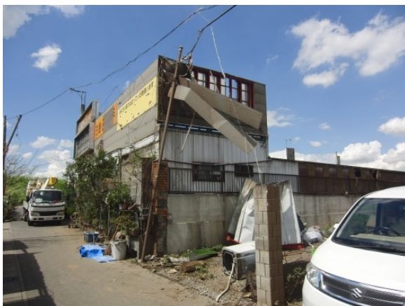
写真 5.2.10 外壁材の脱落
