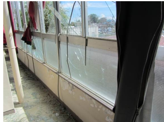
写真 4.1.8 ガラス窓の破損
