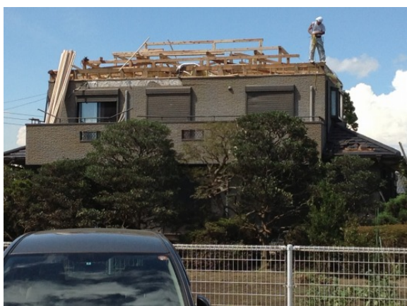
写真 5. 2. 5 小屋組の被害
