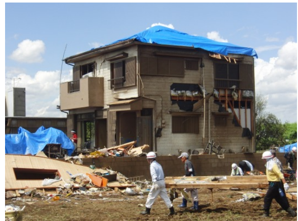
写真 5.2.11 外装材の破損
