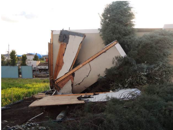
写真 4. 4. 5 木製塀の倒壊
