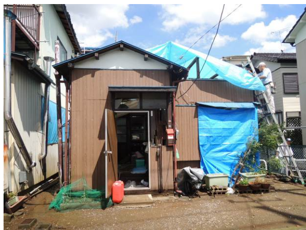
写真 4.2.7 小屋組の被害
