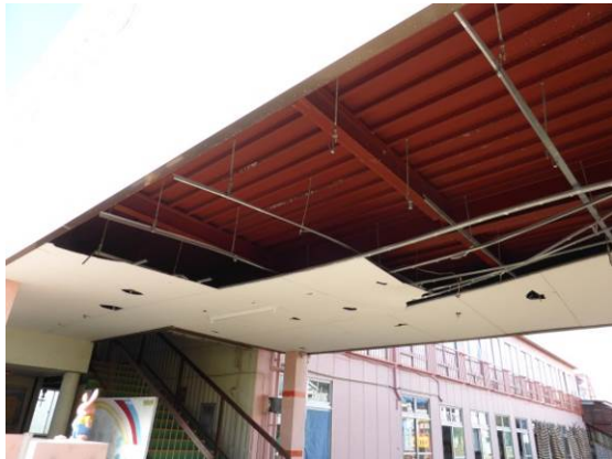
写真 4.1.21 ピロティの天井の被害
