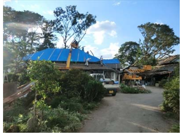
写真 5. 1. 2 屋根ふき材の被害
