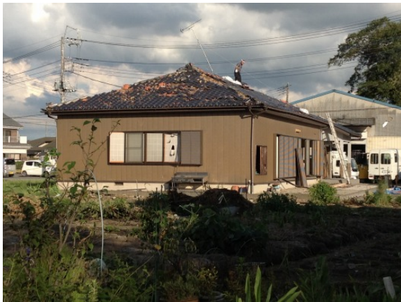
写真 5. 1. 3 屋根ふき材の被害
