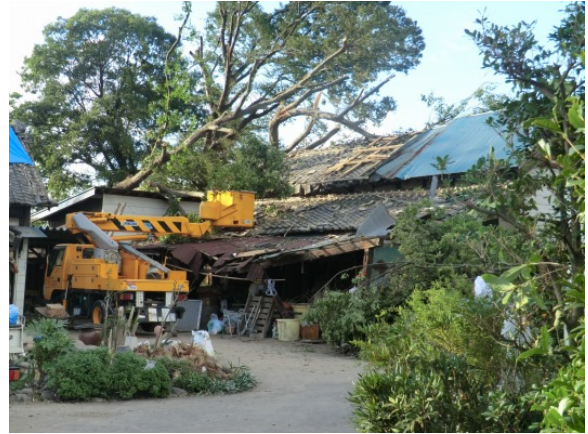
写真 5. 1. 13 樹木の倒壊による小屋組の被害
