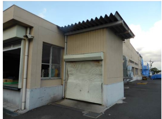
写真 4. 1. 30 シャッターの変形
