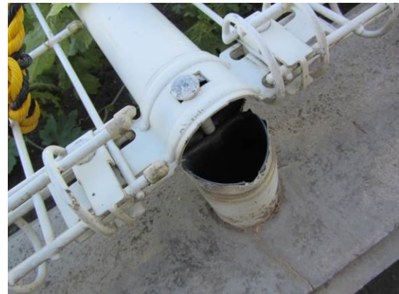
写真 4. 1. 15 支柱部の破断
