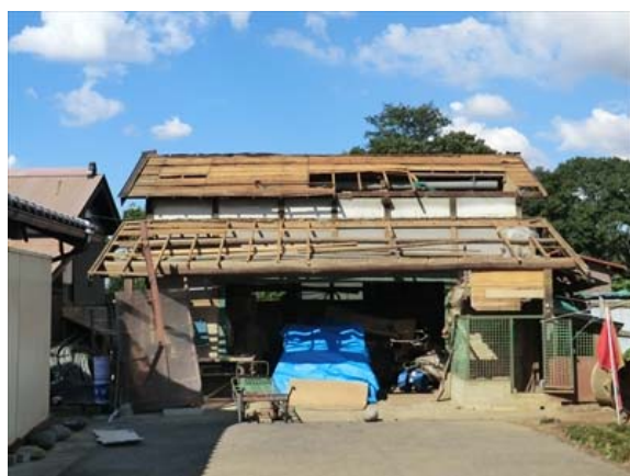
写真 5. 2. 6 小屋組の被害
