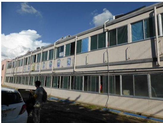
写真 4. 1. 19 建築物外観及び網入りガラス損傷
