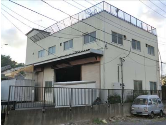
写真 5. 1. 14 屋上フェンスの被害
