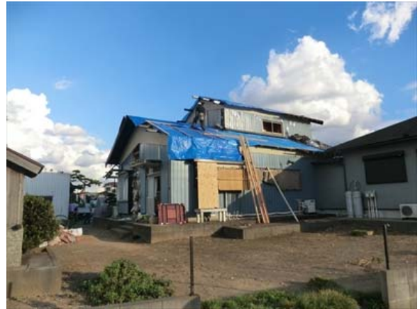
写真 5. 1. 4 屋根ふき材の被害
