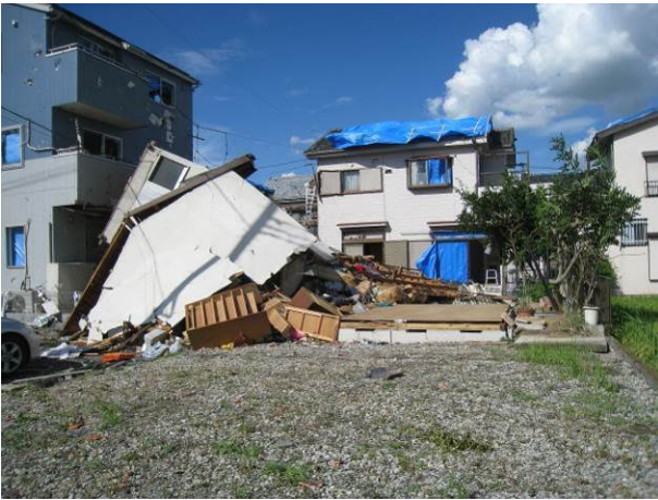
写真 4.2.1 上部構造の倒壊 (1)
