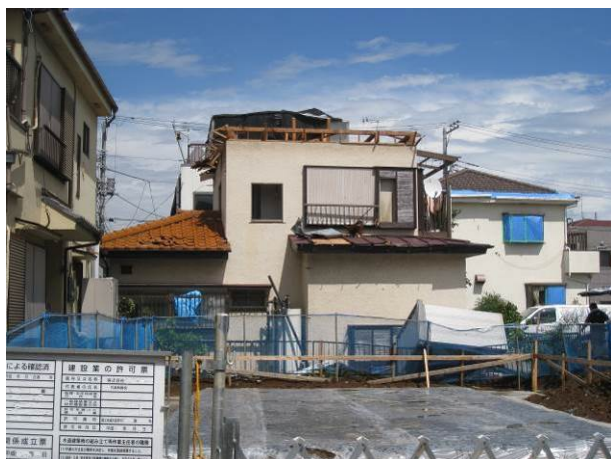
写真 4.2.5 小屋組の被害
