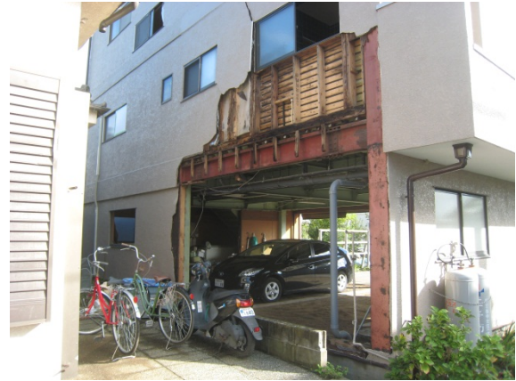
写真5 1階の開口部および壁の破壊
