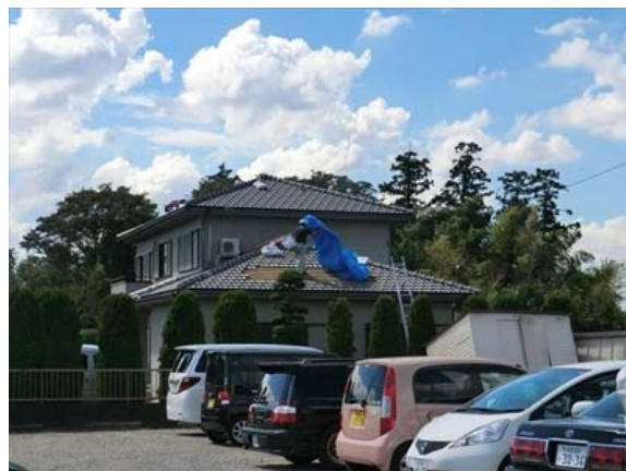
写真 5. 2. 2 屋根ふき材の被害
