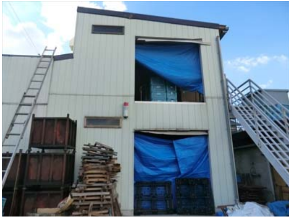
写真 5.1.7 シャッターの被害
