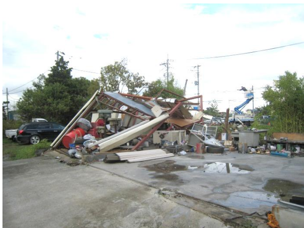
写真2 軽量鉄骨造住家兼作業場跡
