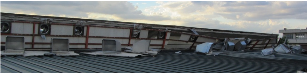
写真 4. 1. 27 屋根部分の立ち上がり壁の仕上げ及び換気扇フードの脱落
