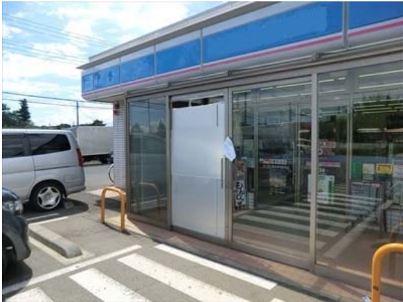
写真 5.2.8 ガラスの破損
