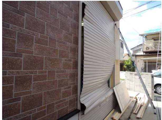
写真 4.2.12 シャッターの被害
