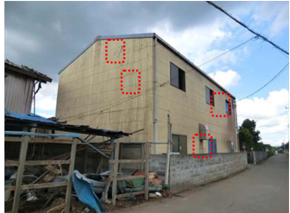
写真 5.2.9 外壁材及びガラスの破損
