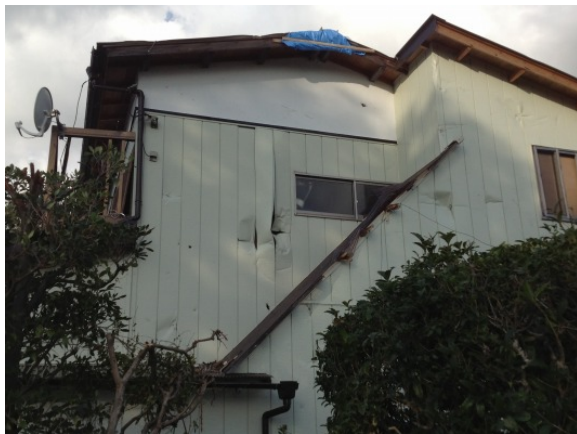
写真 5.1.9 外装材の被害
