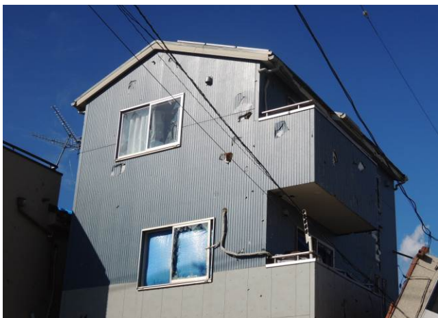
写真 4.3.1 外壁の飛来物による衝突痕
