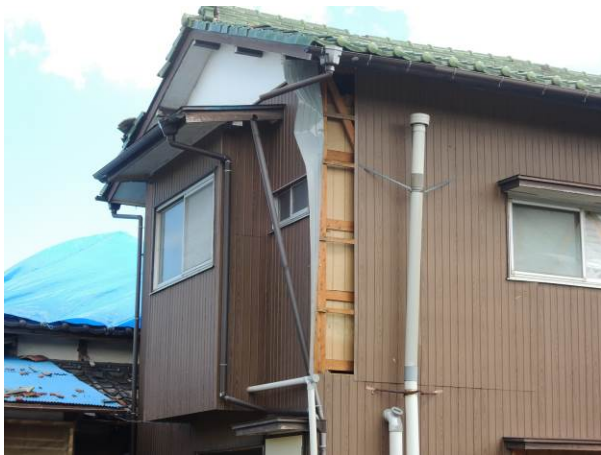
写真 4.2.11 外壁材の剥離
