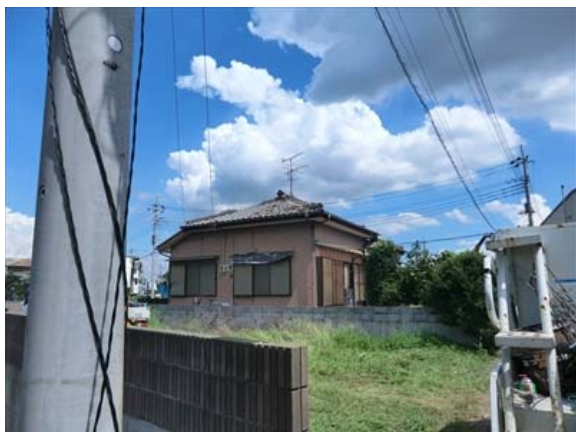
写真 5. 2. 1 屋根ふき材の被害
