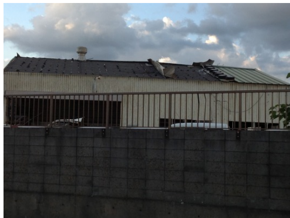
写真 5. 1. 5 屋根ふき材の被害
