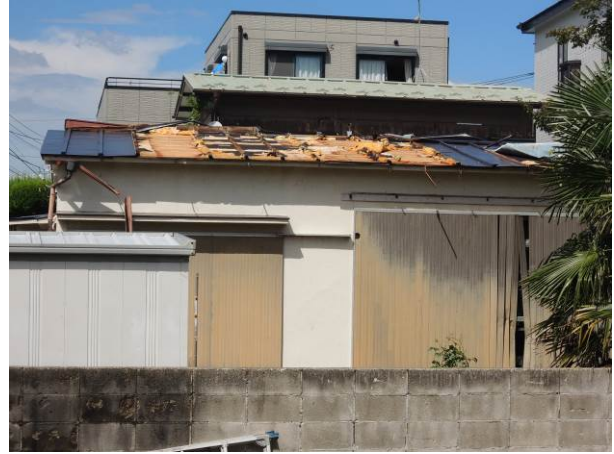
写真 4.2.10 屋根鋼板の飛散状況
