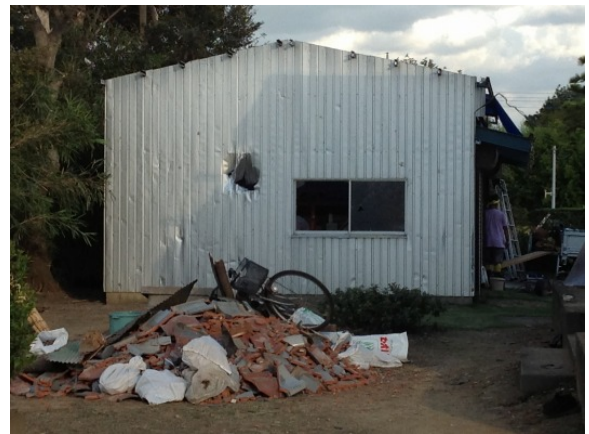
写真 5.1.10 外装材の被害
