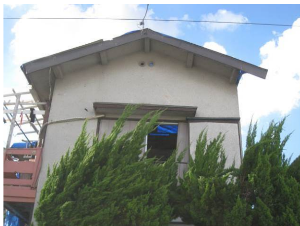
写真 4.2.6 屋根の軒先の被害
