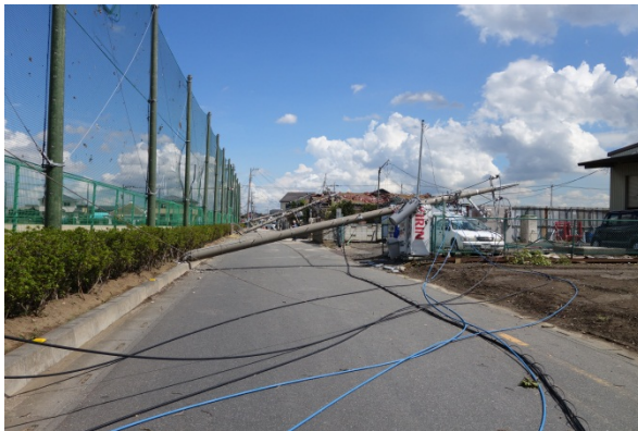
写真6 電柱の被害（室井公美子氏提供）
