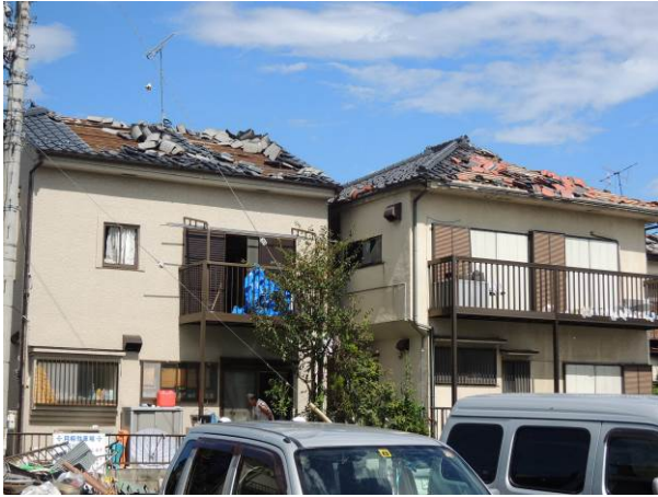
写真 4.2.9 粘土瓦の脱落状況
