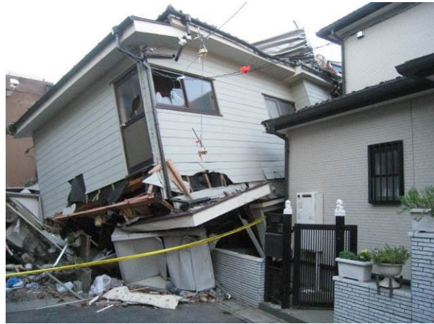
写真 4.2.2 上部構造の倒壊 (2)
