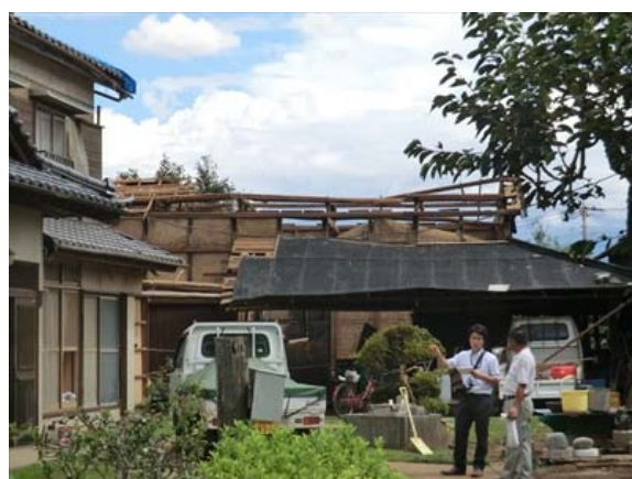
写真 5. 2. 4 小屋組の被害
