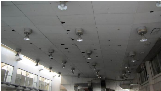
写真 4. 1. 29 天井の部分的な損傷
