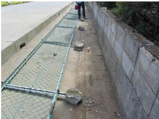
写真 4. 1. 9 フェンスの倒壊
