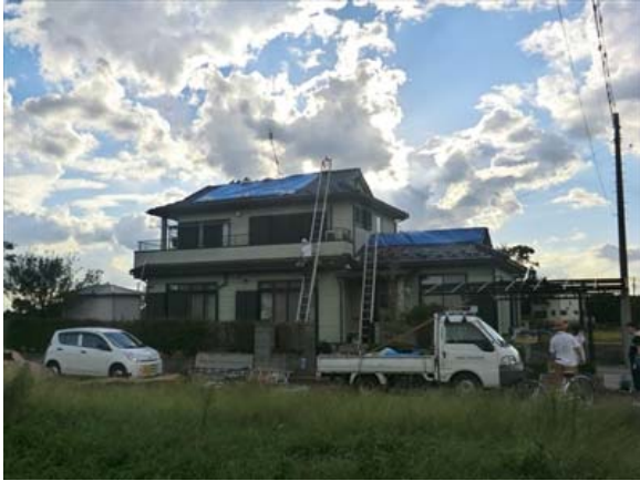
写真 5. 1. 1 屋根ふき材の被害
