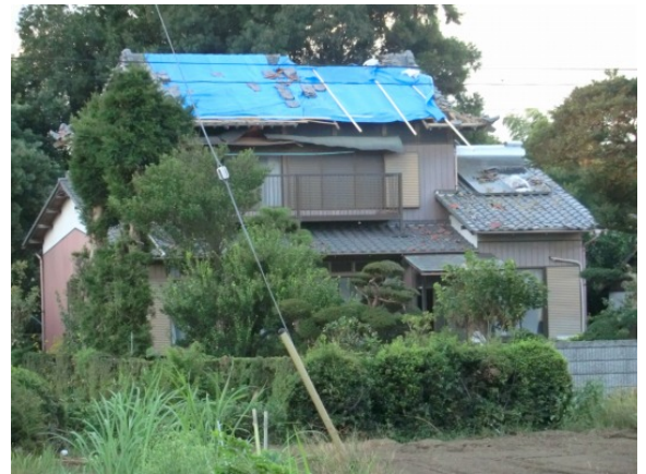
写真 5. 1. 6 屋根ふき材の被害
