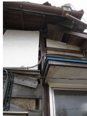
写真 5. 4. 2-8 柱の曲げ変形（台所と居室の境）
