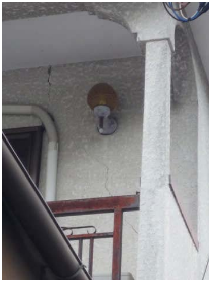
写真 5. 4. 2-53 外壁モルタルの亀裂
