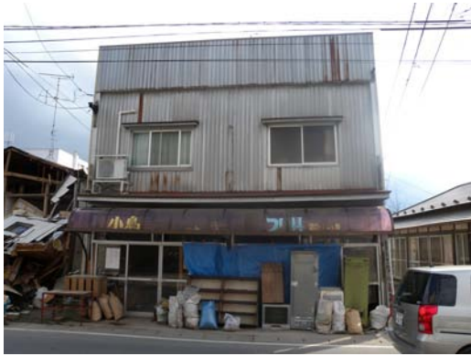
写真 5. 4. 2-43 建物の外観 (1 階傾斜)
