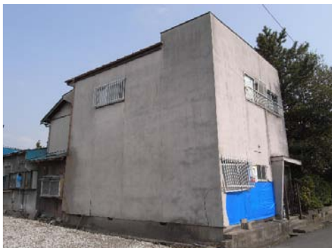
写真 5. 4. 2-29 建物外観（増築部のモルタルの亀裂）
