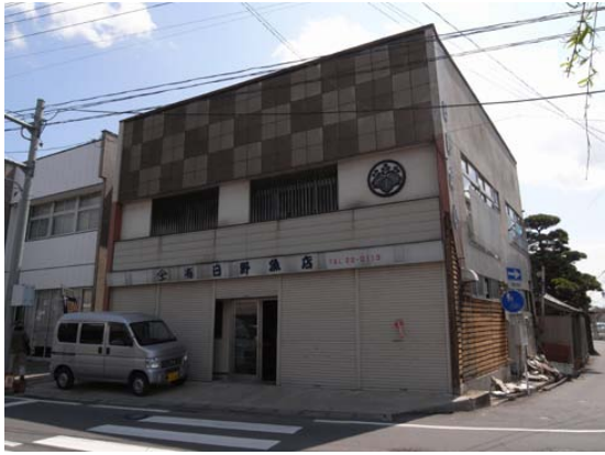
写真 5. 4. 2-31 外観（モルタル外壁の落下）
