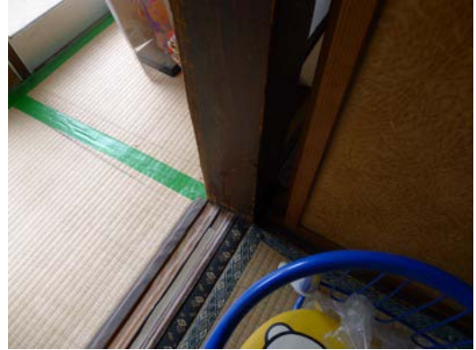
写真 5. 4. 2-6 水平方向に移動した柱脚
