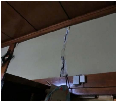
写真 5. 4. 2-49 住居部分 1 階居間土壁の損傷
