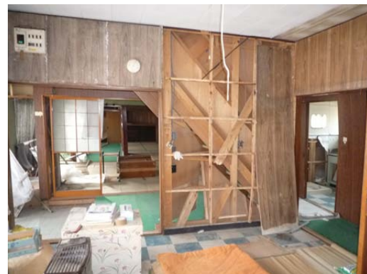
写真 5. 4. 2-22 内観と座屈した筋かい
