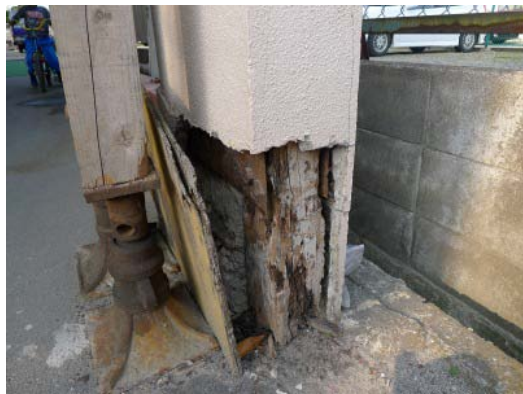
写真 5. 4. 2-24 門型架構 脚部の生物劣化
