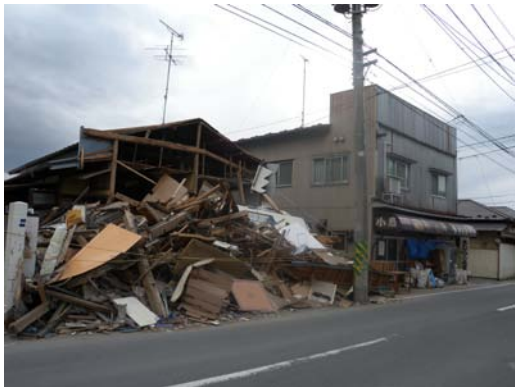
写真 5. 4. 2-45 増築部分が倒壊した隣家
