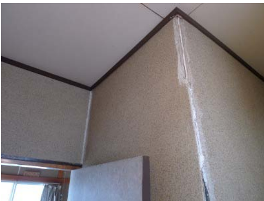
写真 5. 4. 2-25 内壁ラスボードの亀裂
