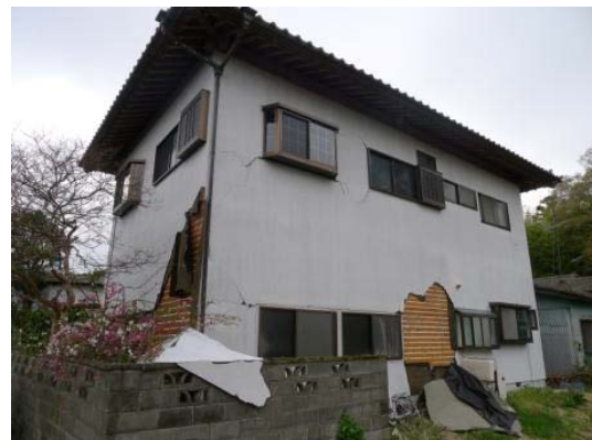
写真 5.4.2-12 モルタル外壁の脱落
