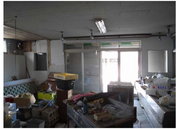
写真 5. 4. 2-32 内部の様子（内装材の落下）
