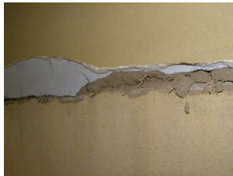
写真 5. 4. 2-2 土塗り壁等の剥落
