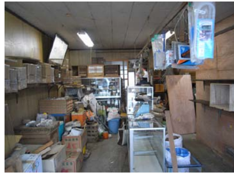
写真 5. 4. 2-44 内観 (1 階店舗部分の傾斜)
