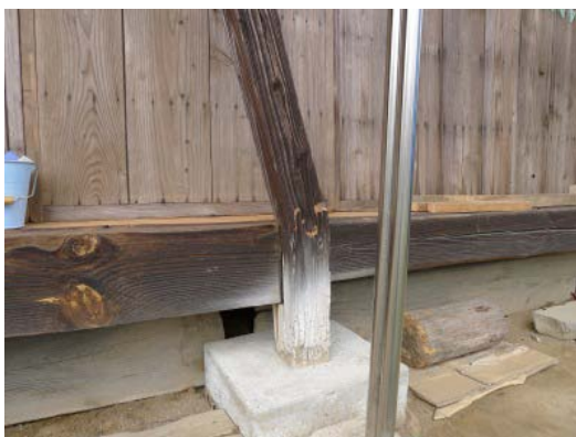
写真 5. 4. 2-17 足固めの高さでの柱の折損
