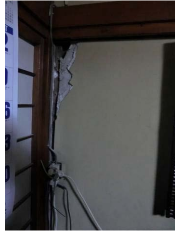
写真 5. 4. 2-48 住居部分 1 階居間土壁の損傷
