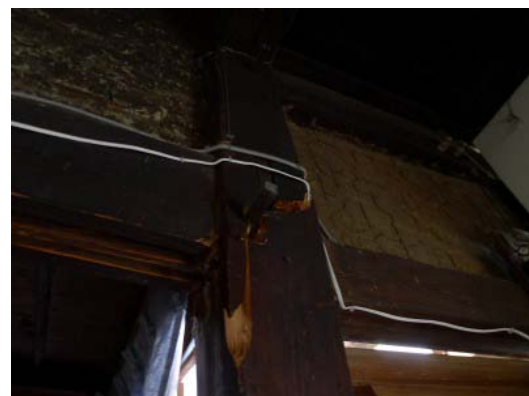
写真 5. 4. 2-18 内部の柱の折損（垂れ壁下端）
