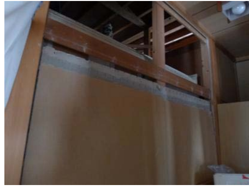
写真 5. 4. 2-14 内壁漆喰ボードの脱落
