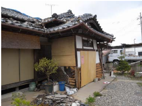
写真 5. 4. 2-7 玄関部の分離、傾斜
