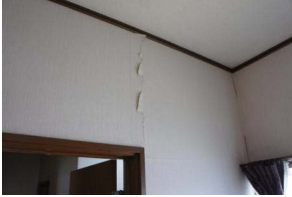
写真 5. 4. 2-13 内壁クロスの切れ
