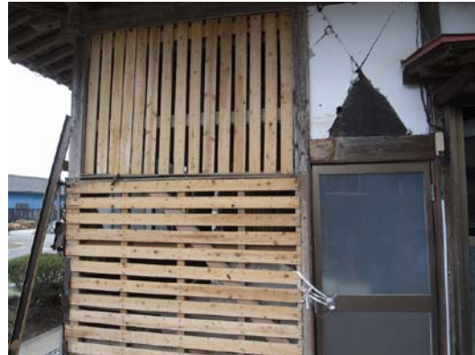
写真 5.4.2-10 脱落した外壁の仕上げと破断した筋かい
