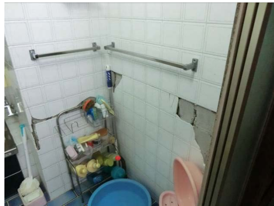
写真 5. 4. 2-50 住居部分浴室のタイルの脱落・亀裂
