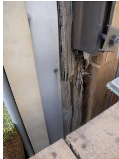
写真 5. 4. 2-46 柱の蟻害と腐朽
