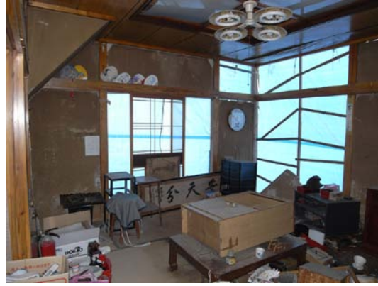
写真 5. 4. 2-28 内部の様子（内壁の損傷）
