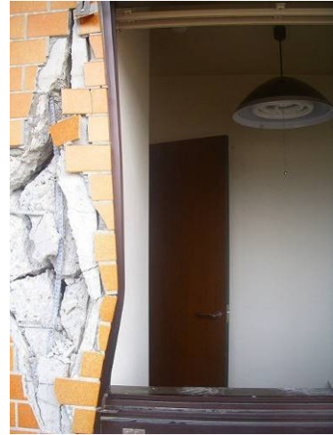
写真 38 サッシの変形
