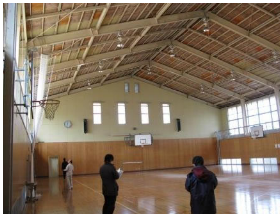
写真 16 体育館内部の状況
