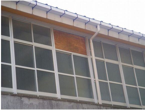
写真7 第1体育館のガラス破損箇所
