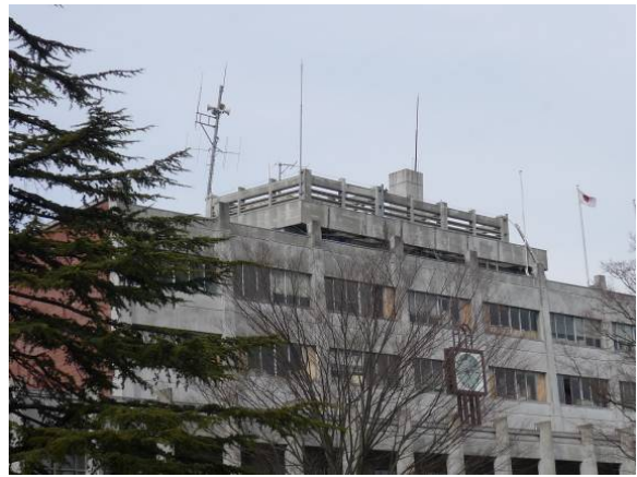
写真 22 ペントハウス部の損傷
