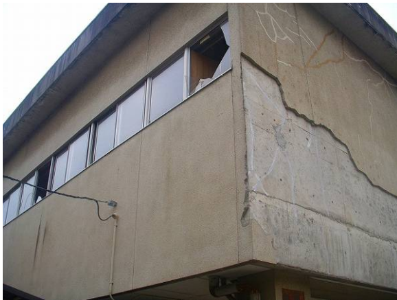
写真 70 体育館の外装被害
