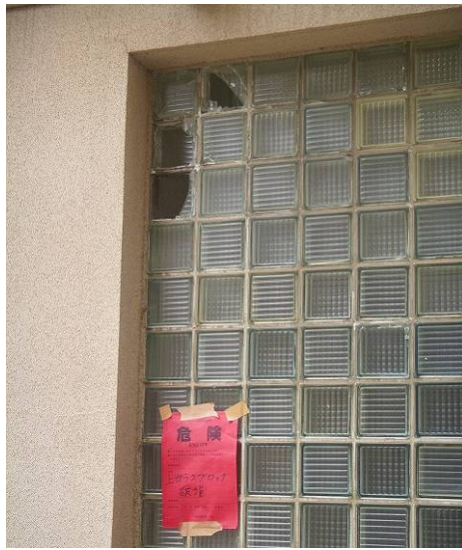
写真 69 ガラスブロックの破損
