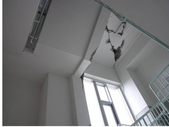
写真 68 時計塔内部の損傷状況
