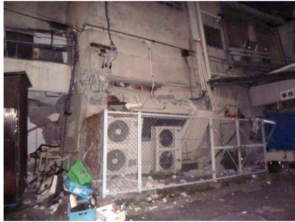
写真 56 1階耐力壁頂部の曲げ破壊
