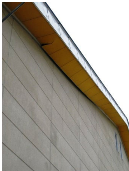
写真 13 妻面の軒天井の損傷
