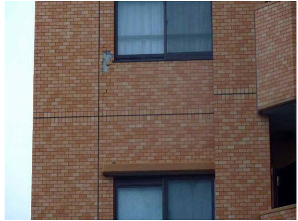
写真 46 非構造壁の損傷（ひび割れ）
