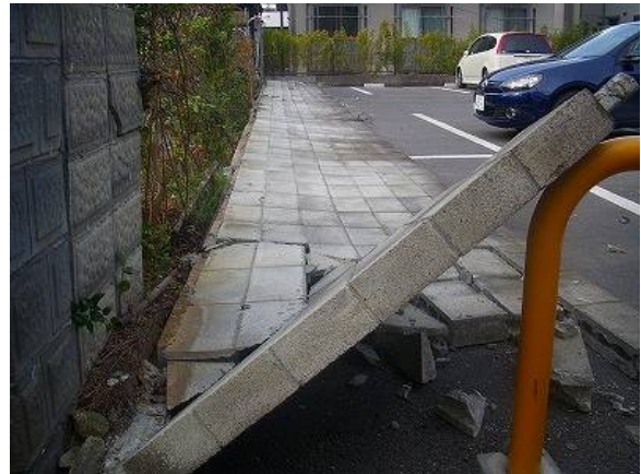
写真 58 コンクリートブロック塀の転倒
