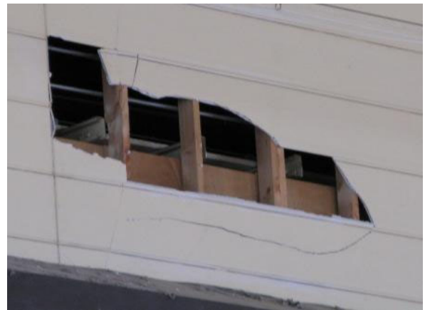
写真10 内装仕上げ材損傷箇所の詳細
