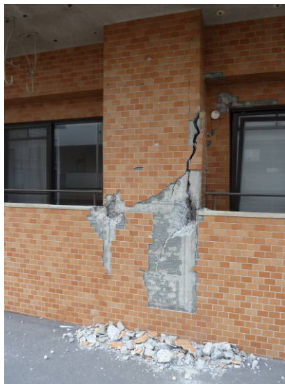
写真 35 1階柱のせん断ひび割れ
