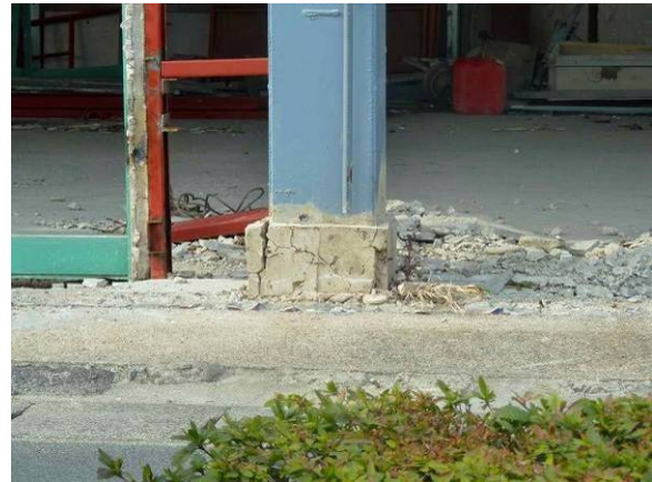
写真 40 柱脚部分の破損
