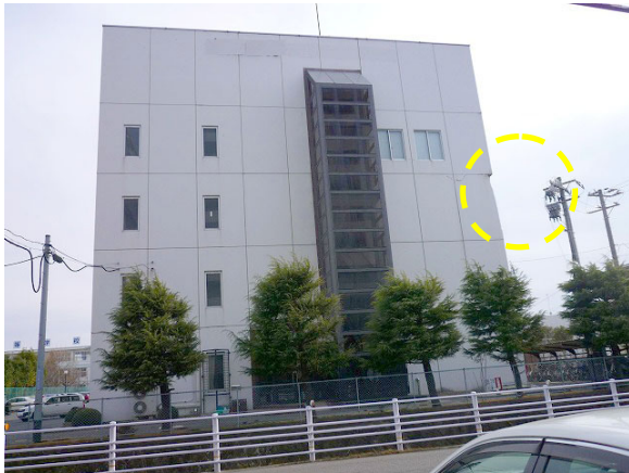
写真 26 事務所ビル A の外観（丸印が剥落箇所）
