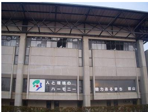
写真 43 大体育館のガラス破損状況
