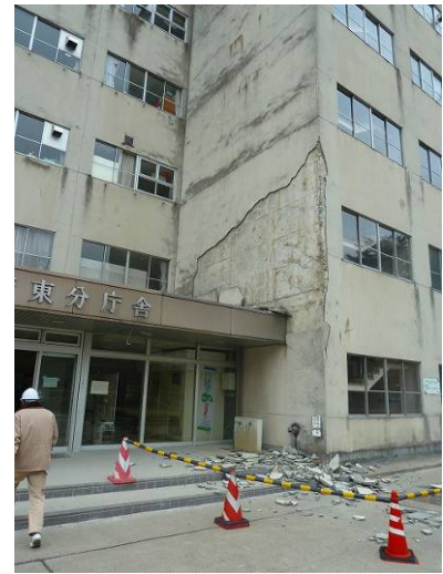
写真 64 エントランス脇の外壁仕上げの剥落
