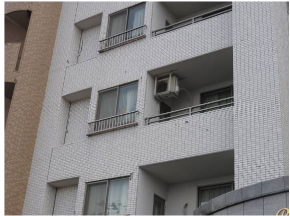
写真 25 軽微なせん断ひび割れ（梁及び柱）
