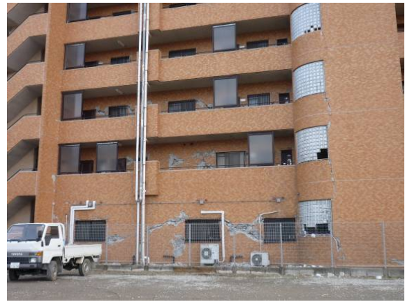
写真 33 非構造外壁の損傷
