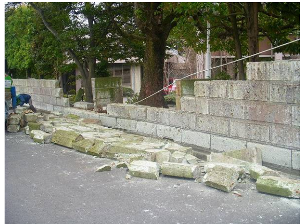
写真 71 知事公館の石塀の崩壊
