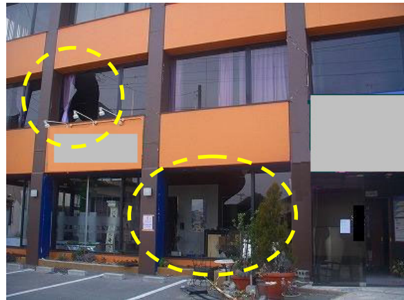
写真 31 窓ガラスの破損
