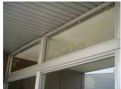
写真 65 ガラスの破損
