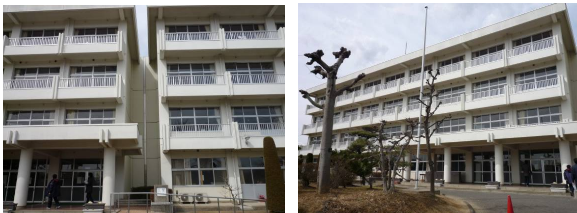
写真 6 A 中学校校舎外観（エキスパンション・ジョイントで隣接する 2 棟）
