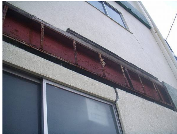
写真 42 外壁仕上げ材の剥離
