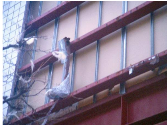
写真 48 仕上げ材の剥離状況
