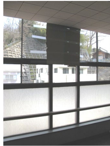
写真 2 窓ガラスの破損箇所
