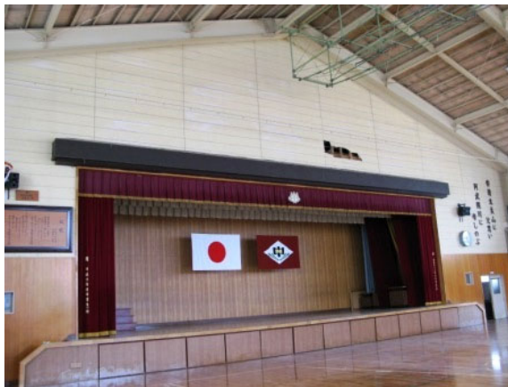
写真9 ステージ上の内装仕上げ材の損傷
