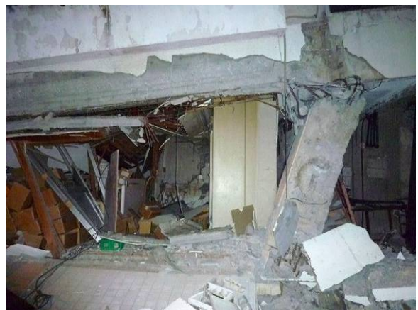
写真 55 1階柱頭・柱脚の曲げ破壊
