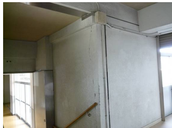
写真12 エキスパンション・ジョイント部の損傷
