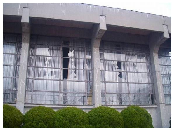
写真 44 小体育館のガラス破損状況
