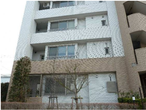
写真 24 非構造外壁の損傷
