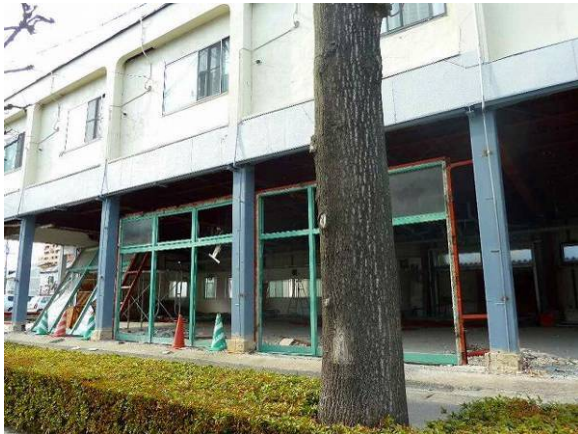
写真 39 ガラスの破損と支持枠の脱落
