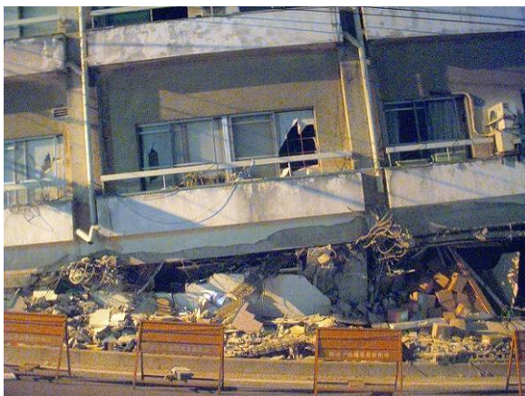
写真 54 ピロティー部の圧壊
