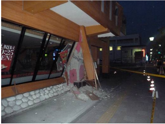
写真 50 1階柱のせん断破壊
