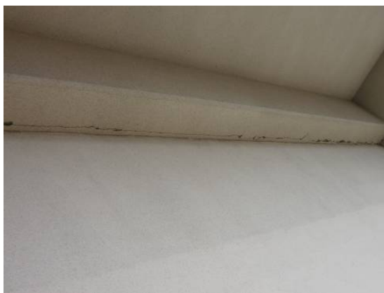
写真 14 壁と梁との接続部のひび割れ
