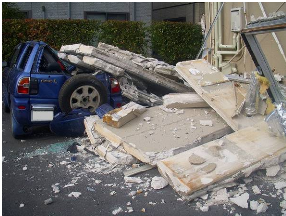
写真 30 乗用車の上に落下した仕上げ材
