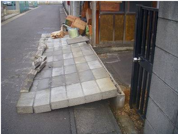
写真 57 コンクリートブロック塀の転倒
