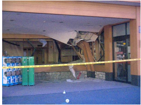
写真 51 1階入隅部の柱と天井の破壊
