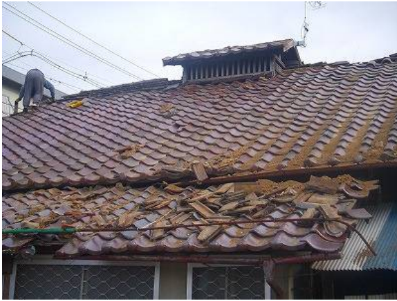
写真 59 屋根瓦のずれと葺き土の表出
