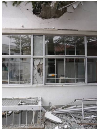
写真 77 1階柱のせん断破壊
