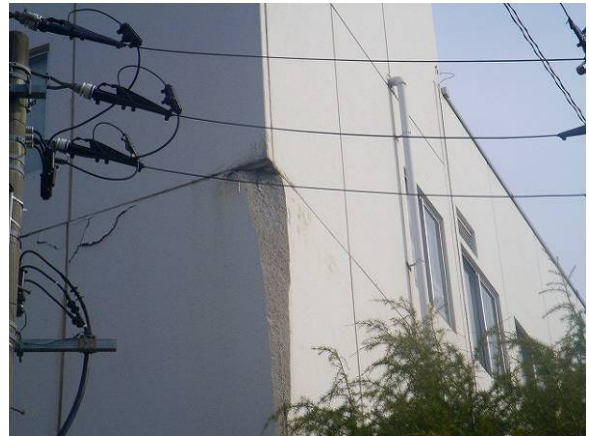
写真 27 かぶりコンクリートの剥落状況
