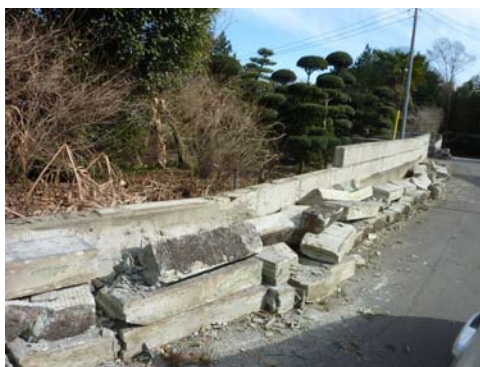
写真 22 ブロック塀の被害
