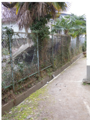
写真3 校舎裏のブロック塀の被害
