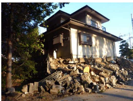
写真 27 地盤変状の被害
