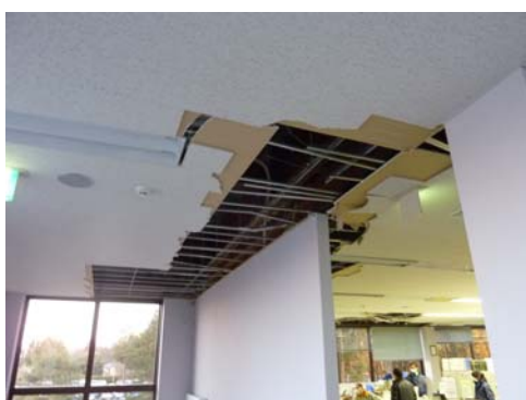
写真 24 付近の建物の天井被害 1
