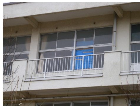
写真2 ガラス窓の脱落（写真1の○印内）
