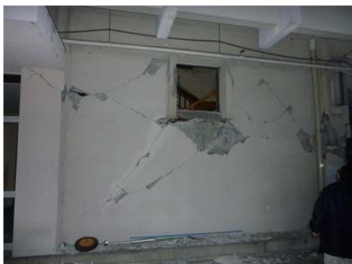
写真 33 開口部付き耐力壁の破壊
