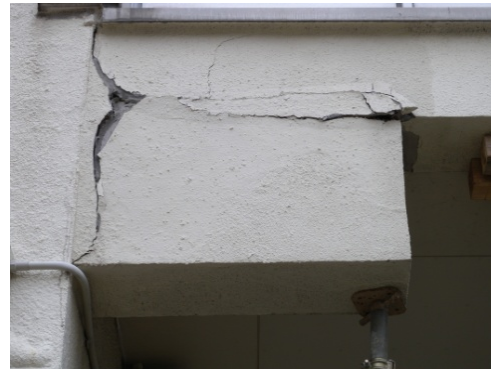
写真 13 支持部分の損傷（写真 12 の○印内）
