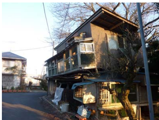
写真 29 木造住宅の被害
