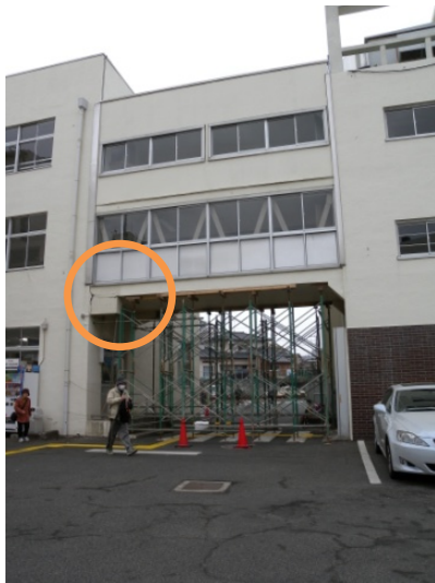
写真 12 使用禁止の渡り廊下
