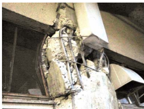
写真 32 極短柱のせん断破壊
