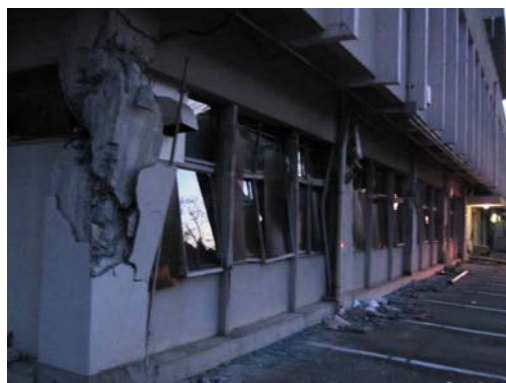
写真 34 外柱のせん断破壊
