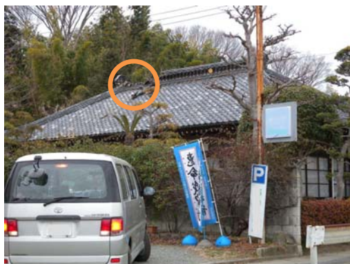
写真 7 瓦屋根の被害
