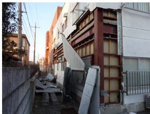
写真 30 鉄骨造建築物の外壁仕上げの剥落
