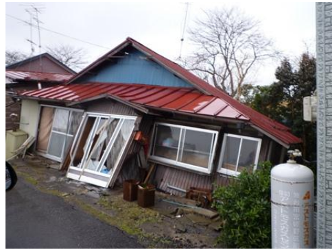
写真13 地盤変状によると見られる被害
