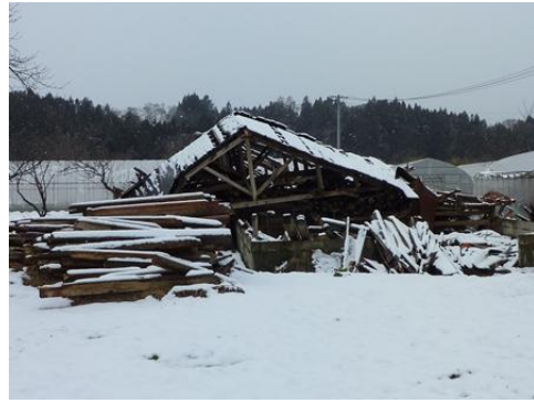
写真 28 木材小屋の倒壊 (栗原市栗駒桜田)
