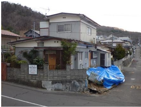
写真2 擁壁破壊と住宅被害 (青葉区折立6丁目)
