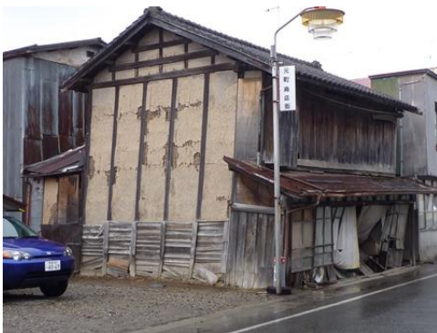
写真14 町屋形式の住宅の被害
