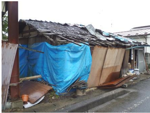
写真 18 老朽化した家屋の倒壊
