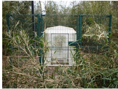
写真11 K-NET 築館 設置状況 (左側に約3mの段差あり)
