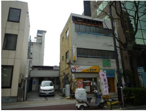
写真1 鉄骨造建築物の外壁仕上げ剥落 (仙台市街)
