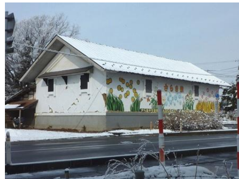
写真 26 写真 25 近傍での土蔵の被害 （北上市更木）
