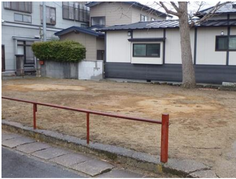
写真12 液状化による噴砂の痕跡
