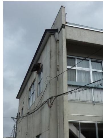
写真 42 瀬峰支所パラペットの傾斜 (栗原市瀬峰)
