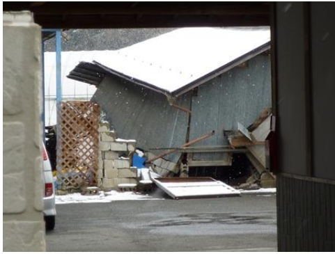
写真 27 作業小屋の倒壊 (栗原市栗駒桜田)
