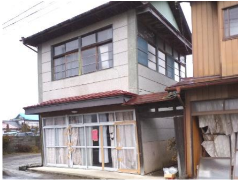
写真 16 町屋形式の住宅の被害
