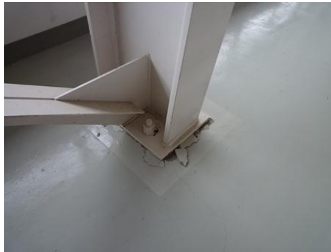
写真 34 写真 31 の鉄骨柱脚部の損傷 (栗原市栗駒)
