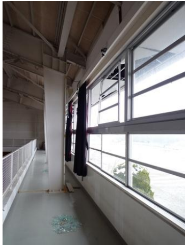
写真 33 写真 31 の窓、軒天の被害 (栗原市栗駒)
