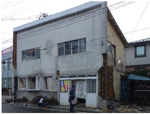
写真 45 モルタル外壁の剥落 (仙台市青葉区小松島)
