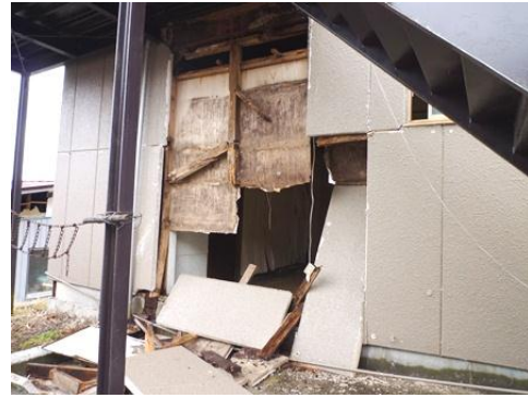
写真 40 写真 39 の外壁の破壊状況 (栗原市瀬峰)
