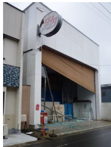
写真 23 鉄骨造と見られる建築物の被害
