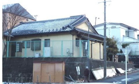
写真 48 棟瓦落下および塀の倒壊 (仙台市青葉区旭ヶ丘)
