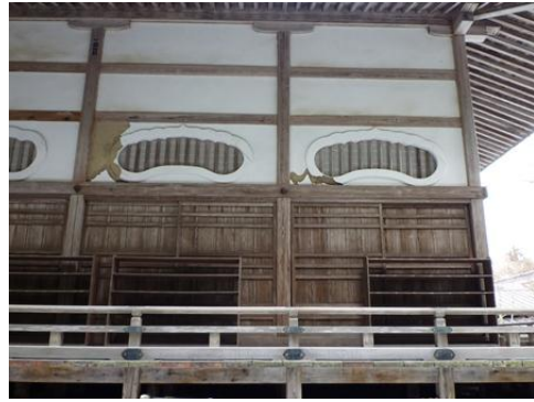
写真9 中尊寺本堂 土壁の剥落
