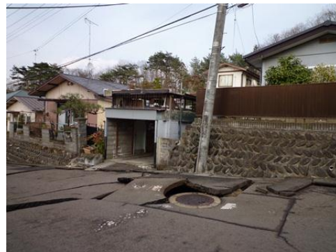
写真5 道路の路面破壊 (青葉区折立5丁目)
