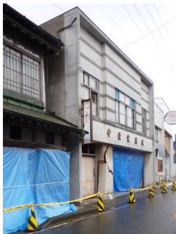
写真 22 商店建築物の被害
