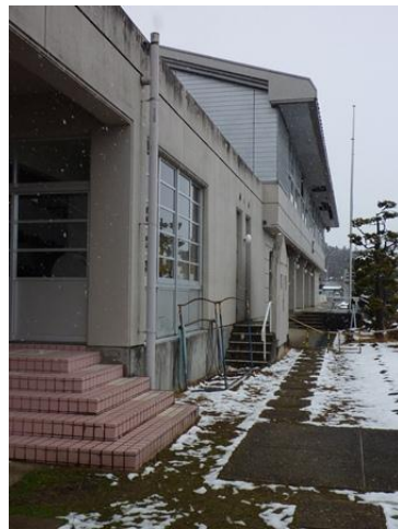
写真 32 写真 31 の軒天井の脱落 (栗原市栗駒)
