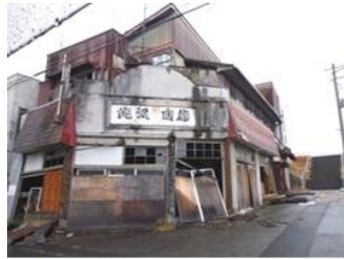
写真 21 老朽化した商店建築物の被害
