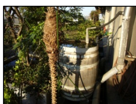
雨水貯留タンク
