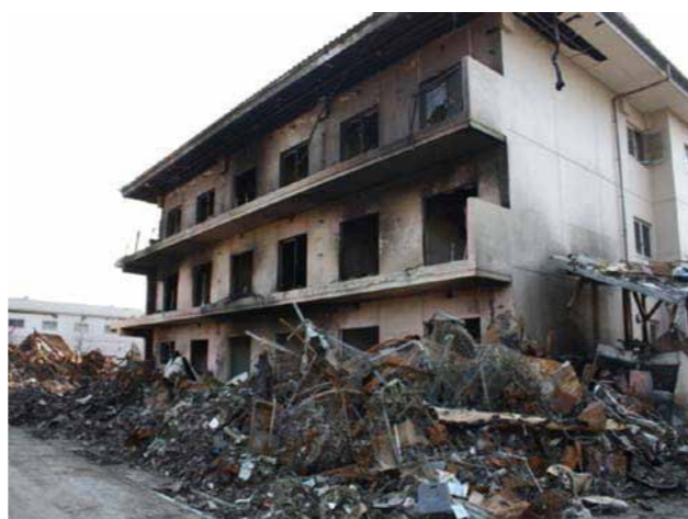
■写真6 津波からの避難に使われた老人ホーム火災後の外観(当時、2階が津波で浸水し35名の人々が3階に避難していた。津波火災により3階にも延焼したが、部屋の移動を繰り返すことで助かった。)
