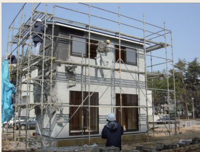
写真1：解体しやすい木造建築物の施工・解体実験（解体の様子）
