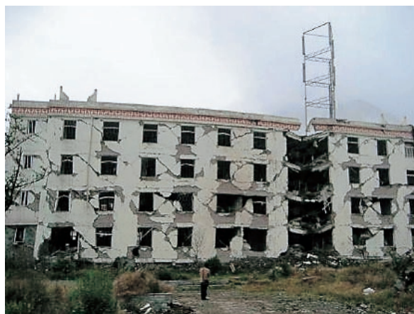
写真1 1階が完全に崩壊した5階建ての学生寮(四川省映秀)
