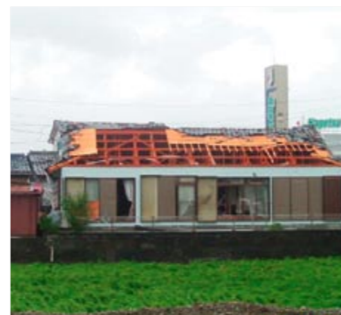
写真4 竜巻により屋根がはく離した住家(延岡市提供)
