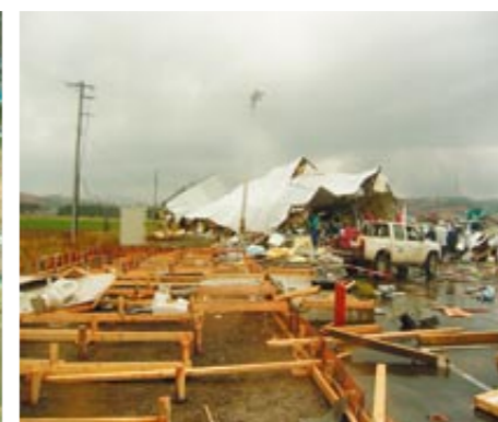
写真8 竜巻の直撃による作業現場仮設建築物の倒壊と飛散の状況(国土交通省北海道開発局提供)
