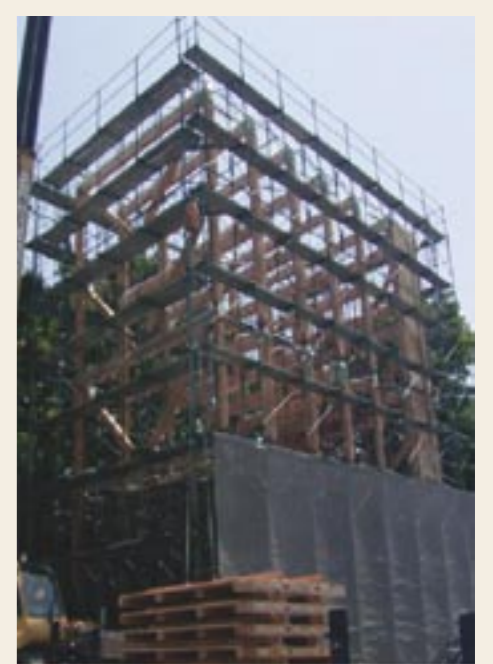
■写真2 燃え止まり工法を用いた中層建築物の例(1階:RC造、2～5階:燃え止まり工法)
