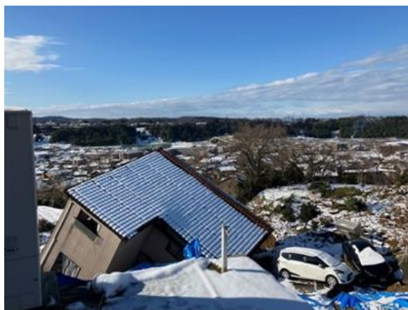
写真 5.4.2-1 崩壊した斜面の状況①
