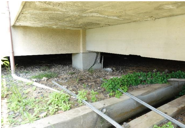
写真 5.3.2-178 東柱のせん断破壊
