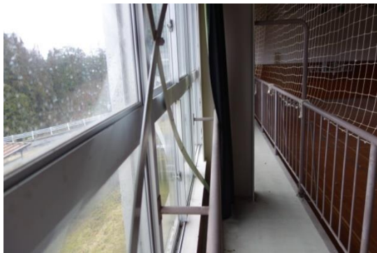
写真 5.5-152 ブレースのたわみ
