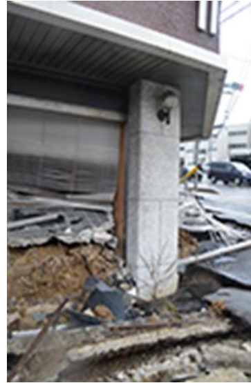
b) 南東隅柱
