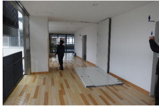
写真 5.6.2. (5)-6 防火扉の外れ、転倒 ※右の扉は通行のために移動してある (WA-102 : 輪島市、教育施設)
