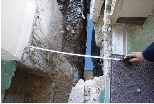
写真 5.5-141 第一体育館と第二体育館 の通路の損傷による約 60cm の隙間
