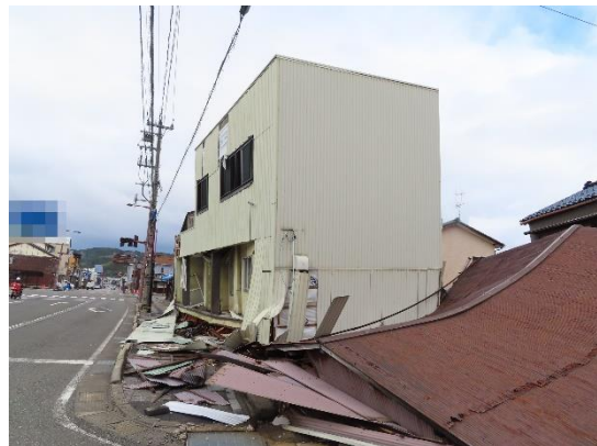
写真 5.5-10 1階の層崩壊（側面）
