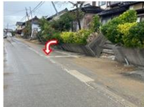
h) 傾斜した擁壁
