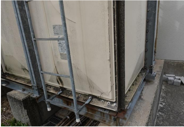
写真 5.3.2-104 受水槽の亀裂
