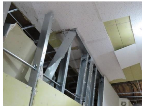
写真 5.6.2.(2)-23 屋内運動場ギャラリー一部分の被害 (壁下地材が天井面ボードに支持されていた) (WA-102: 輪島市、教育施設)
