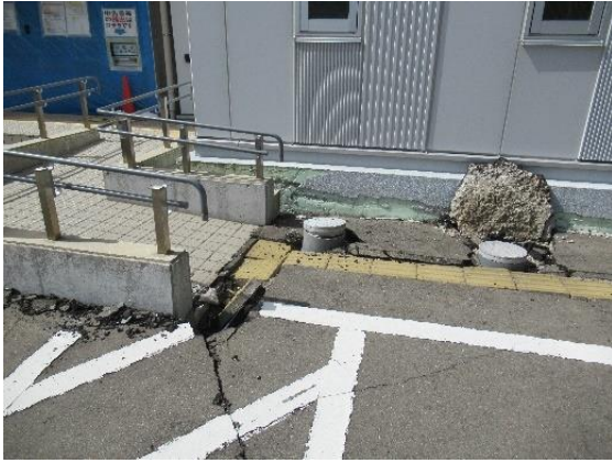
写真 5.3.2-5 建築物周辺の地盤変状
