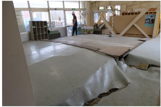
写真 5.3.2-29 建築物 C-1 1 階床面の起伏
