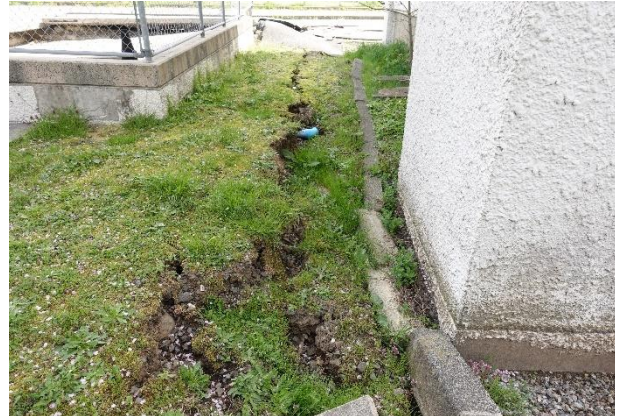
写真 5.3.2-142 建築物 AC-3 北側の地盤変状
