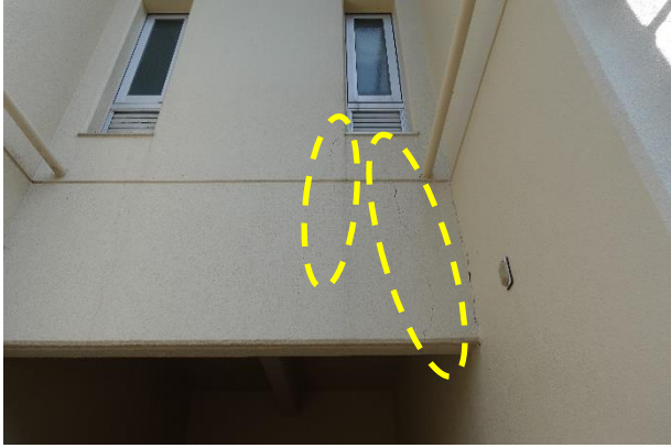
写真 5. 3. 2-58 西側階段室上部のひび割れ
