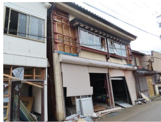
写真 5.5-23 建築物前面の外壁の脱落、シャッター破損、窓ガラス、窓枠の破損
