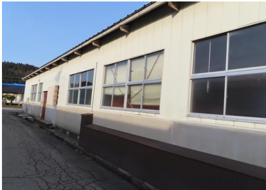
写真 5.5-87 ブレースの座屈
