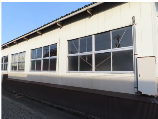
写真 5.5-88 ブレースの座屈
