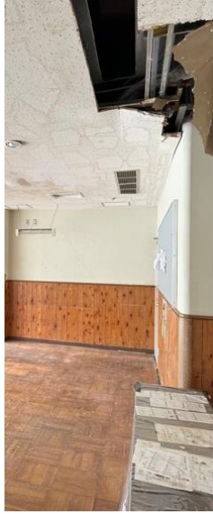
写真 5.3.2-119 P-2 棟の天井材落下
