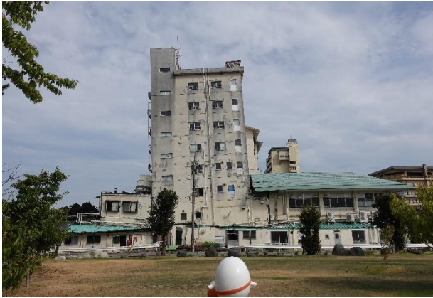
写真 5.3.2-165 西側棟の傾斜
