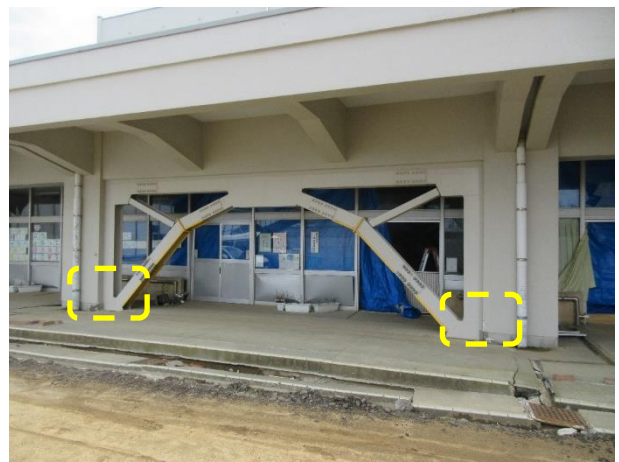
写真 5.3.2-19 建築物 B-2 の鉄骨ブレース補強 周辺柱の被害
