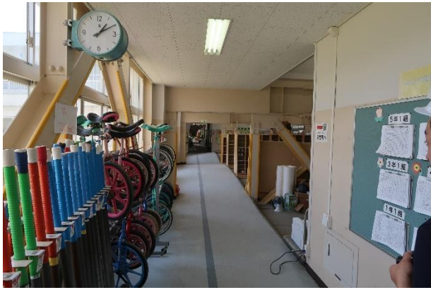
写真 5.3.2-28 建築物 C-1 1 階床面の起伏
