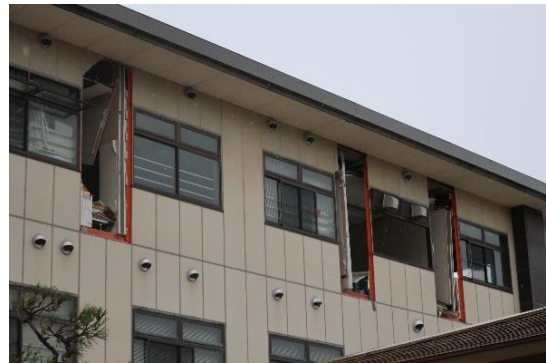
写真 5.6.2.(3)-10 校舎張間方向の ECP による外壁の脱落 (AN-101 : 穴水町、教育施設。写真 5.6.2(2)-19 を再掲)
