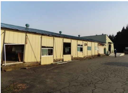
写真 5.5-82 外観及び外壁・サッシの脱落状況
