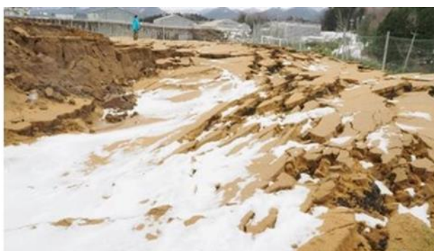
写真 5. 4. 2-43 校庭の地割れ
