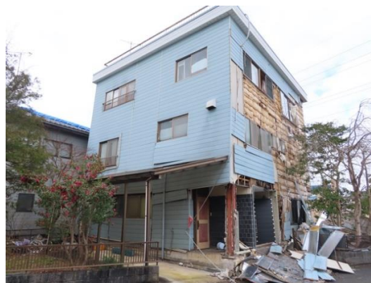
写真 5.5-79 外壁の脱落（裏側）
