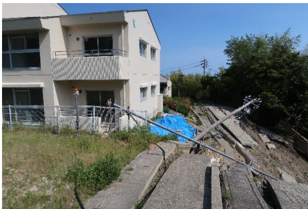
写真 5.3.2-52 東側の地すべり
