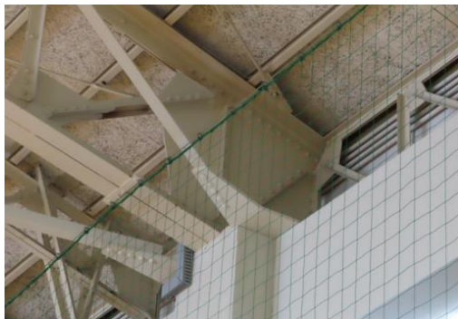
写真 5.5-134 平側のRC造柱の柱頭とトラス梁の接続部（支承部）ではほとんど損傷無し
