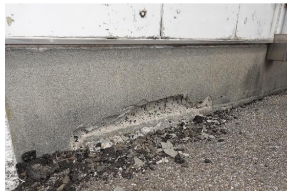
写真 5.3.2-137 上部構造基部のコンクリートの剥落（建築物 AC-1）
