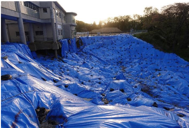
写真 5.3.2-107 地盤崩落の状況
