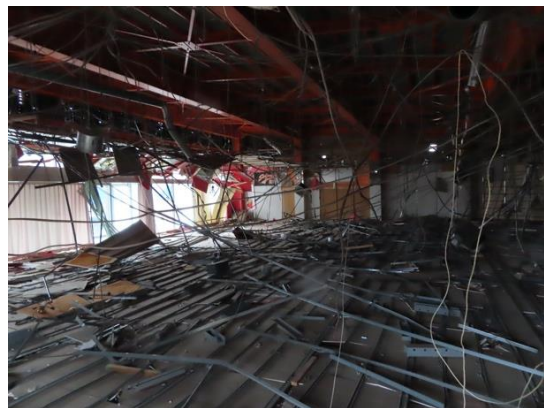
写真 5.5-97 内観（天井の全面的な脱落）
