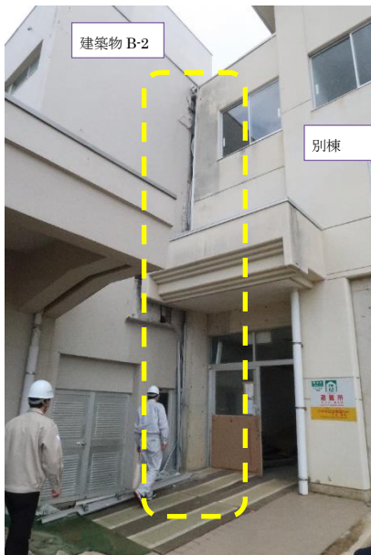
写真 5.3.2-20 建築物 B-2 と別棟の間の Exp. J. の被害
