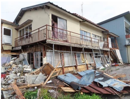
写真 5.5-30 1階の大きな傾き
