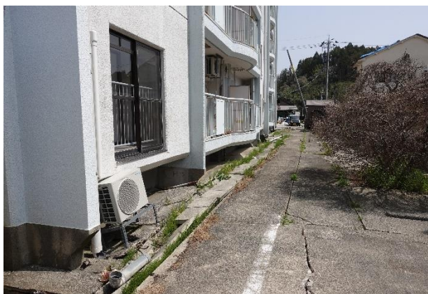
写真 5.3.2-144 建築物周辺の地盤変状
