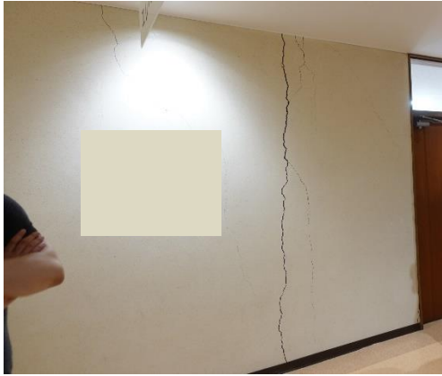
写真 5.3.2-68 壁の縦ひび割れ
