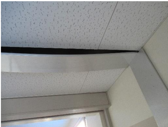
写真 5.3.2-109 Exp. J. の損傷
