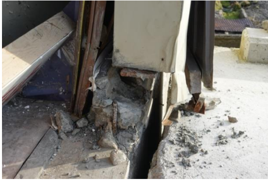
写真 5.5-40 出入り口の柱脚部分のコンクリート破壊、柱脚部のプレートに溶接されたアンカー鉄筋の破断
