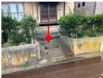
a) 地盤沈下により玄関下に隙間が生じた住宅
