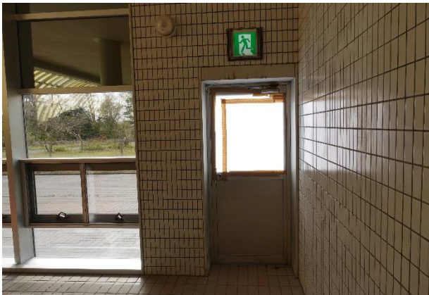
写真 5.3.2-105 建築物 M-2 のドアのガラスの割れ
