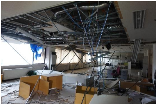
写真 5.6.2.(1)-23 事務所部分 4階天井の被害（WA-104：輪島市、音楽等用ホールを有する施設）
