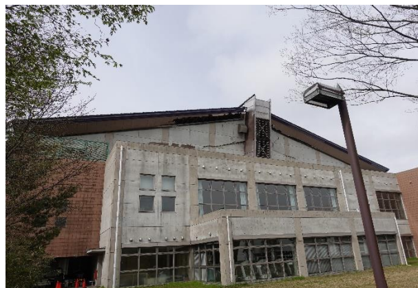
写真 5.3.2-97 妻構面の RC 造壁の面外破壊②
