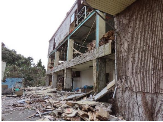
写真 5.5-63 建築物前面の外壁の脱落
