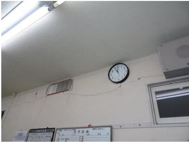
写真 5. 3. 2-182 壁のひび割れ (AN-1)
