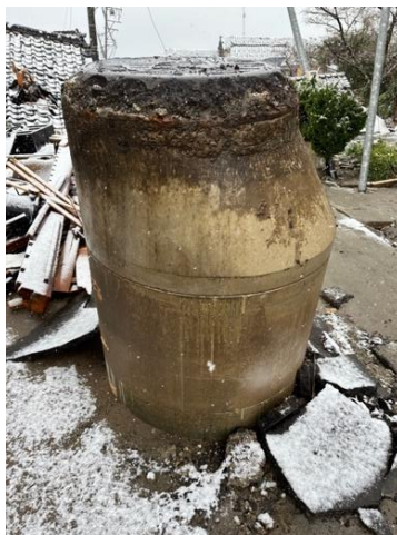
写真 5.7-19 突出したマンホール
