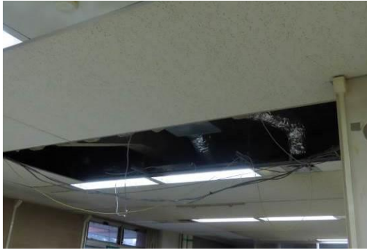
写真 5.6.2.(1)-21 システム天井ボードの落下（建築物 A：金沢市、行政庁舎）
