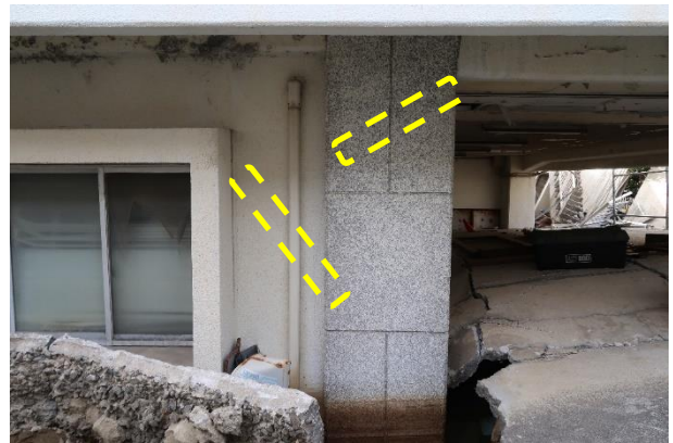
写真 5. 3. 2-132 X4-Y3 柱の損傷
