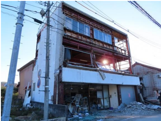
写真 5.5-53 建築物前面の外壁、窓ガラスの脱落
