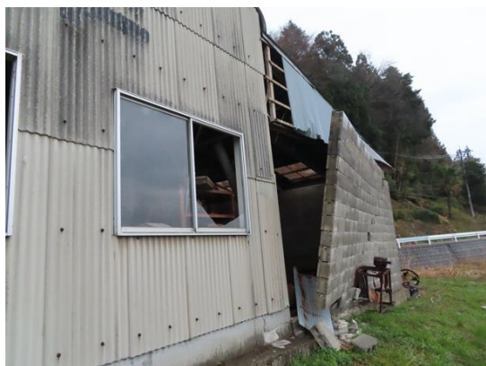
写真 5.5-93 下屋のコンクリートブロック外壁が一部倒れかかっている
