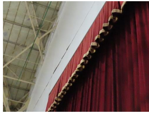
写真 5.6.2.(2)-6 屋内運動場 プロセニウムアーチのパネル目地の浮き (WA-103 : 輪島市、教育施設)
