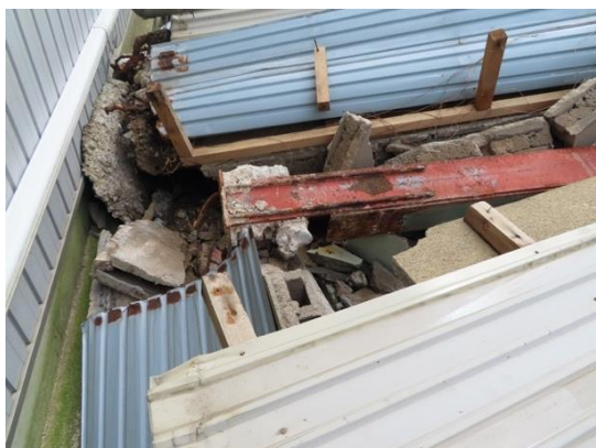
写真 5.5-17 日の字断面柱の露出柱脚の引き抜け
