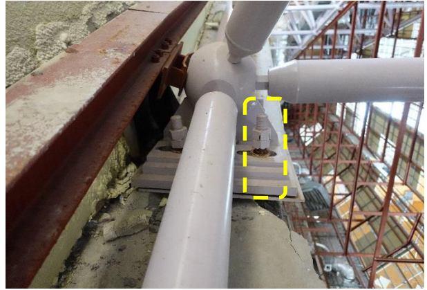
写真 5. 3. 2-99 屋根支承部のアンカーボルトの伸び
