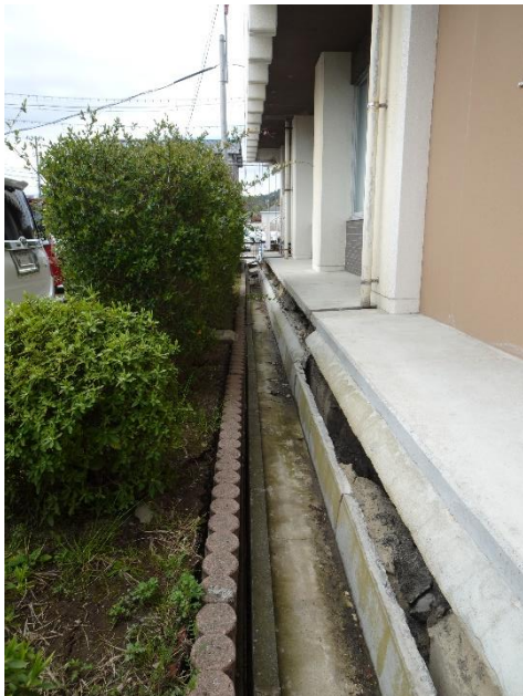
写真 5.3.2-46 建築物外周部の地盤変状
