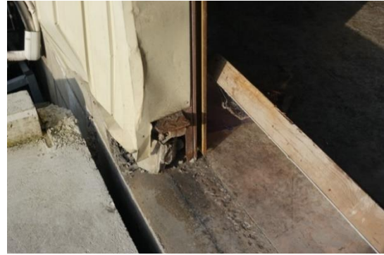
写真 5.5-41 出入り口の反対側の柱脚部(コンクリートの少々の破壊)
