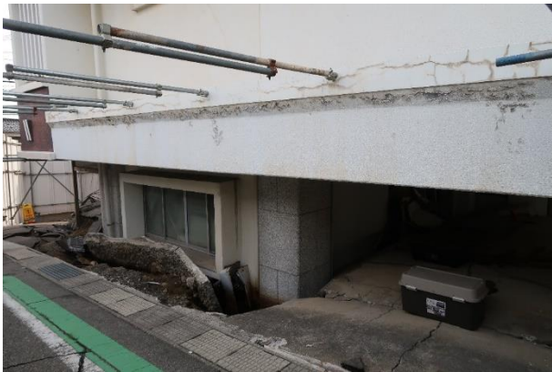
写真 5. 3. 2-131 X4 構面 1 階部分の沈下
