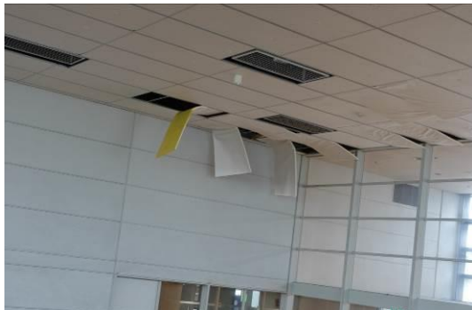
写真 5.6.2.(1)-1 屋内運動場のグラスウール板の垂れ下がり （建築物 C：金沢市、運動施設）
