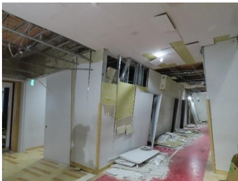
写真 5.6.2.(2)-22 屋内運動場ギャラリー一部分の間仕切壁の傾き、天井の被害 (WA-102: 輪島市、教育施設)
