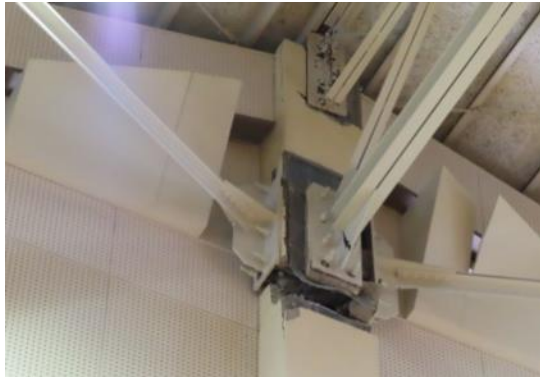
写真 5.5-131 RC造柱のコンクリートの破壊、脱落、アンカーボルトの伸び
