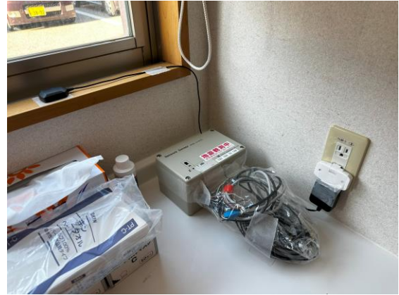
写真 4.4-13 強震計設置状況 (WJMF2 : 北側1階、CV374_146)
