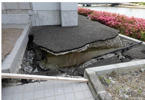
写真 5.3.2-66 建物周辺の地盤変状
