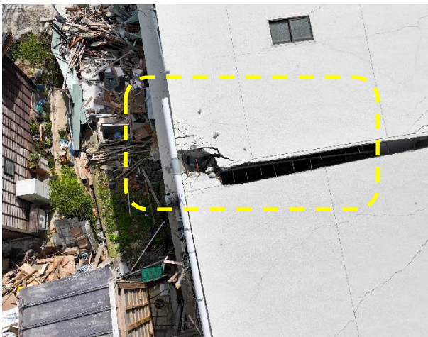
写真 5.3.2-126 西側壁面の損傷
