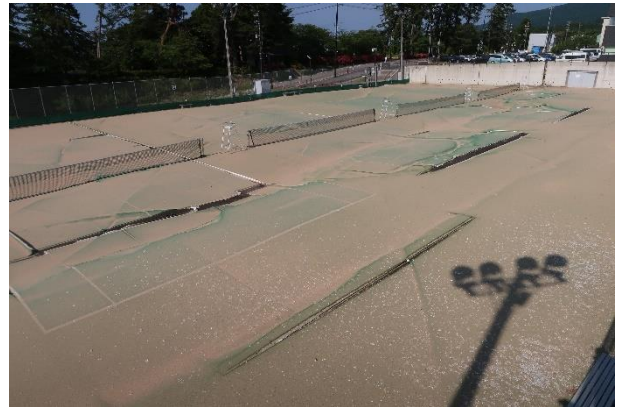
写真 5.3.2-115 建築物 O-2 北側の地盤変状
