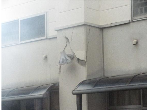
写真 5.3.2-121 2階S柱—RC梁接合部の被害
