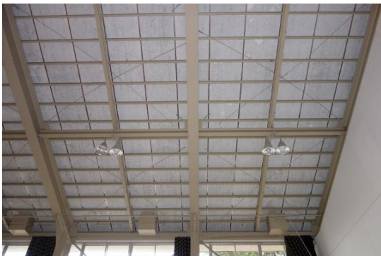
写真 5.5-151 ターンバックルねじ部の破断
