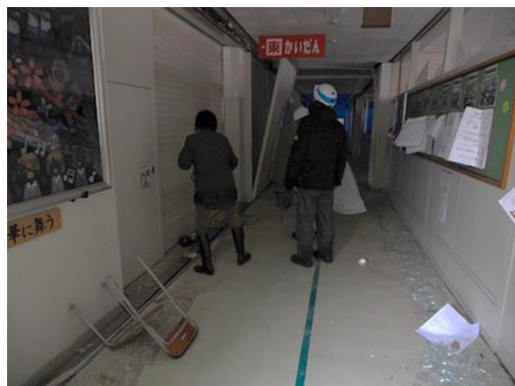
写真 5.4.2-37 建物内部のガラスの散乱状況
