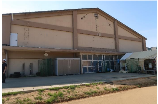
写真 5.3.2-113 建築物 O-4 東妻面の損傷
