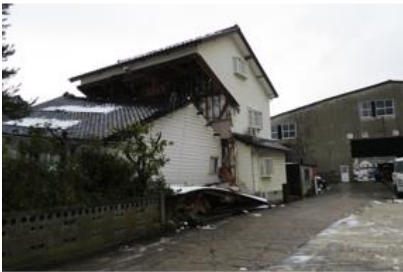
写真5. 2. 2-64 1層が崩壊した3階建て木造住宅
