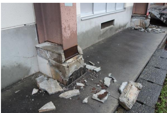
写真 5.5-153 柱脚部のコンクリートの破壊
