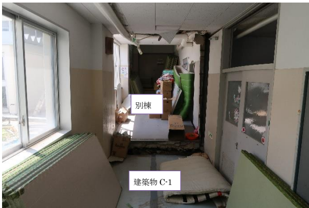
写真 5.3.2-32 建築物 C-1 と別棟の間の Exp. J. の被害
