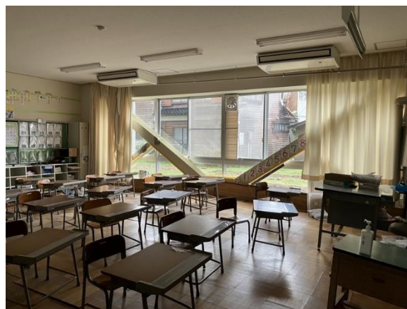
写真 5.4.2-36 1 階での床面の盛り上がり (教室棟)
