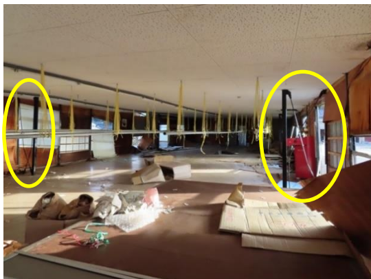
写真 5.5-85 内観及びターンバックルブレースの湾曲
