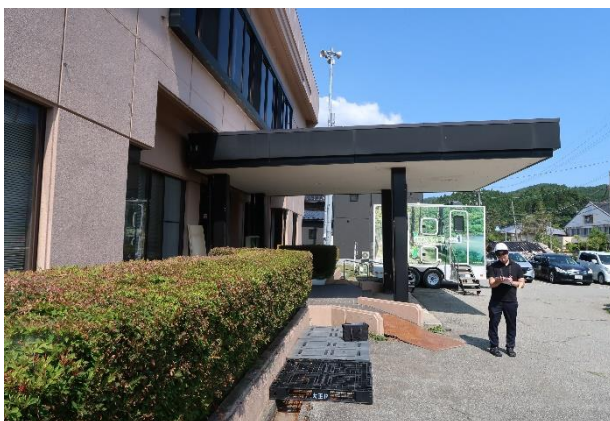
写真 5.3.2-157 建物入口ポーチ部の柱の傾斜
