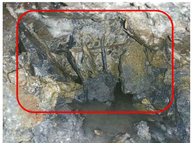
写真 5. 3. 2-42 杭頭部の損傷 (D-3②)
