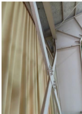
写真 5.5-139 第一体育館 山形鋼ブレース (1 丁) の面外たわみ
