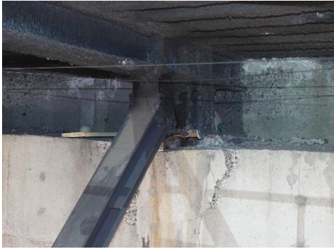
写真 5.5-125 支承部の RC 造架構のコンクリートのひび割れ
