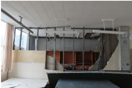
写真 5.6.2.(2)-20 校舎3階 教室の間仕切壁の被害 (WA-101: 輪島市、教育施設)
