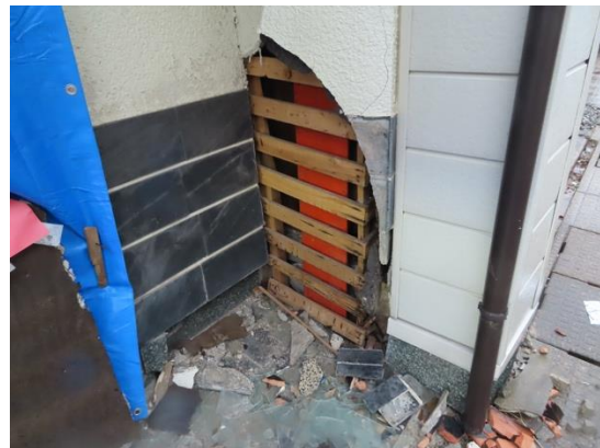
写真 5.5-51 外壁の一部脱落
