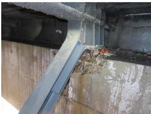
写真 5.5-123 支承部の定着モルタルの破壊
