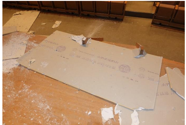
写真 5.3.2-83 内装材の落下
