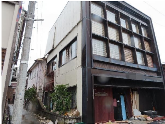
写真 5.5-89 外観（側面の外壁の脱落）
