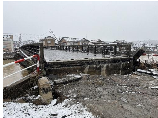
写真 5.7-18 橋と道路との間の段差
