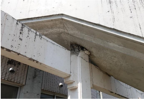
写真 5.3.2-78 外階段-柱接合部の損傷
