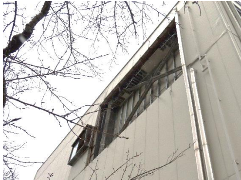
写真 5.6.2.(3)-5 校舎 3 階の ALC パネルによる外壁の脱落 (WA-101：輪島市、教育施設)
