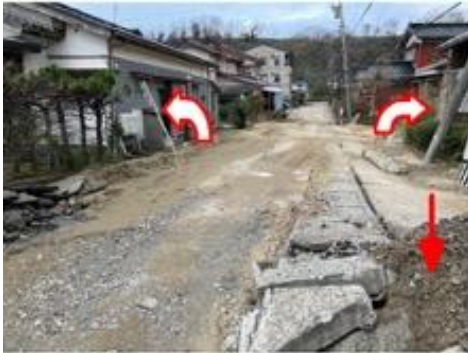
g) 地盤沈下と傾斜した電柱等
