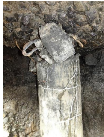
写真 5.3.2-9 杭 No.④-1 の損傷状況
