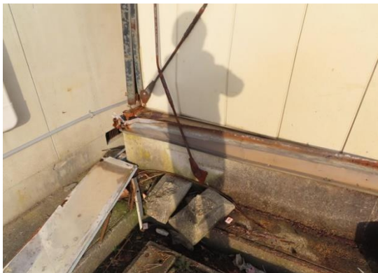
写真 5.5-83 ターンバックルブレースの座屈及び溶接接合部の破断
