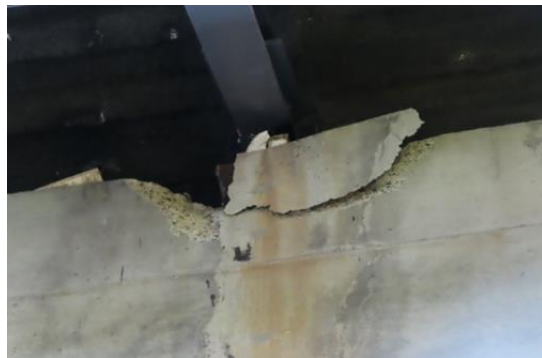
写真 5.5-122 支承部の RC 造架構のコンクリートの剥落
