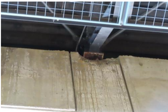
写真 5.5-121 支承部の RC 造架構のコンクリートの剥落
