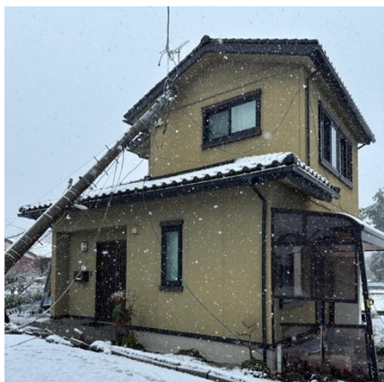
写真 5.7-35 ガイドライン工法による住宅 (J形瓦)
