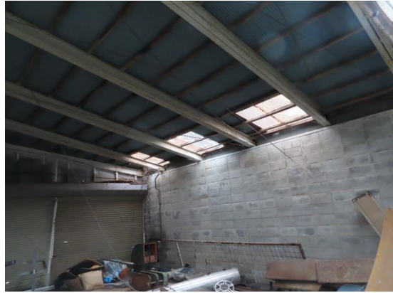
写真 5.5-95 下屋の水平ブレースの破断
