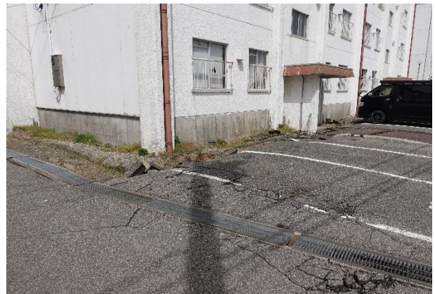
写真 5.3.2-140 建築物 AC-2 東側の地盤変状
