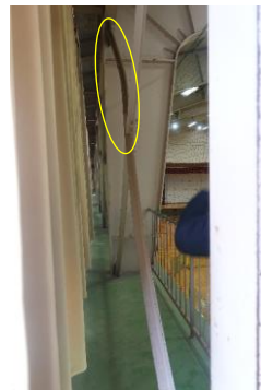
写真 5.5-138 第一体育館 山形鋼ブレース (1 丁) の面外たわみ
