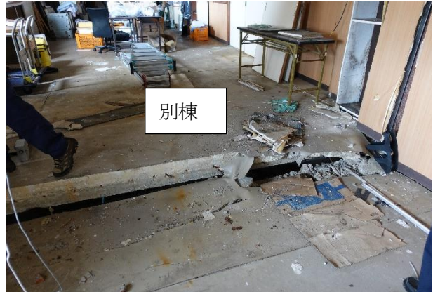
写真 5.3.2-160 AI-1 棟と別棟間の 1 階床損傷
