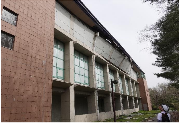
写真 5. 3. 2-98 平構面の RC 造壁の面外破壊
