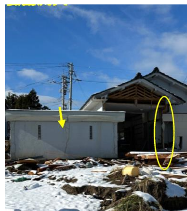
写真 5.7-27 外壁の損傷と隅柱の流失
