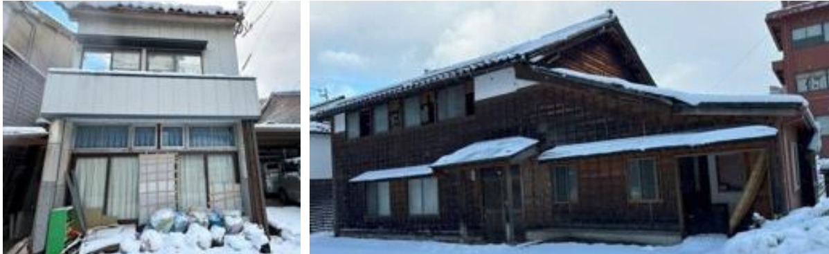
写真5.2.2-16 建築年が古いと見える割に外観上被害軽微と見受けられる木造家屋
