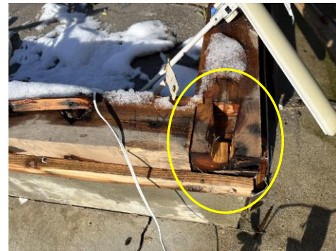
写真 5.7-29 流失した住宅の土台の状況
