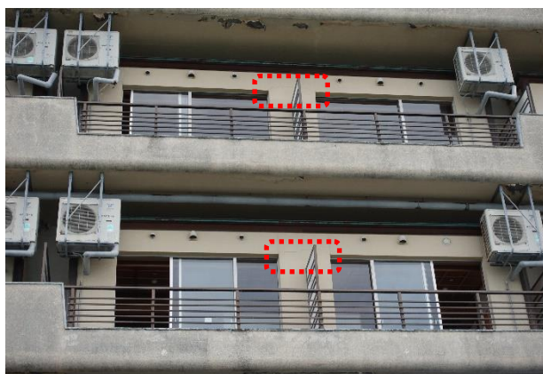
写真 5.3.2-170 西側棟方立壁の曲げひび割れ
