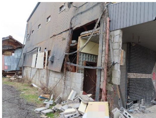
写真 5.5-34 建築物全体の大きな変形及び外壁脱落
