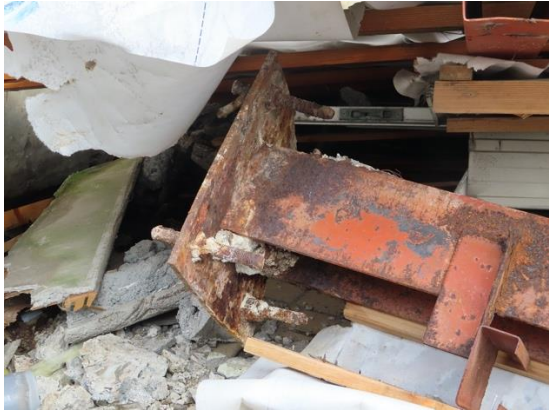
写真 5.5-11 露出柱脚のアンカーボルト破断、柱脚の引き抜け
