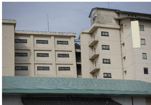
写真 5.3.2-164 西側棟の傾斜による Exp.J.の被害
