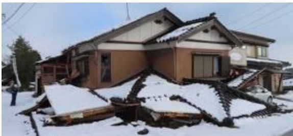
写真5.2.2-48 1層が崩壊した木造住宅
