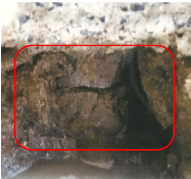
写真 5. 3. 2-41 杭頭部の損傷 (D-1①)
