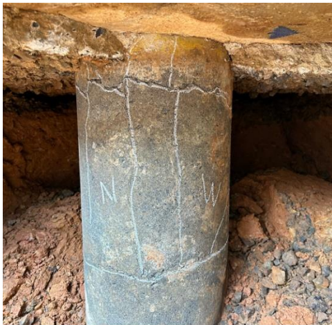
写真 5.3.2-122 杭の損傷状況 (③)
