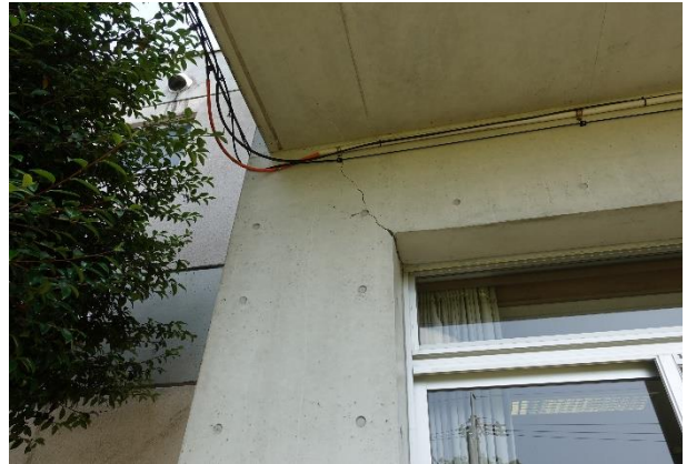
写真 5.3.2-81 梁端部の曲げひび割れ
