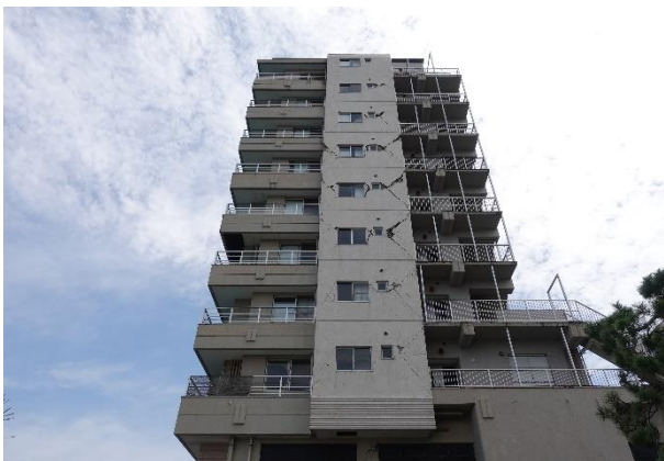
写真 5.3.2-161 AI-2 棟 方立壁のせん断破壊
