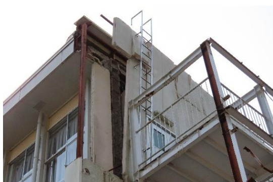
写真 5.6.2.(3)-3 校舎の鉄骨屋外階段付近の ALC パネルによる外壁の被害 (WA-111：輪島市、教育施設)
