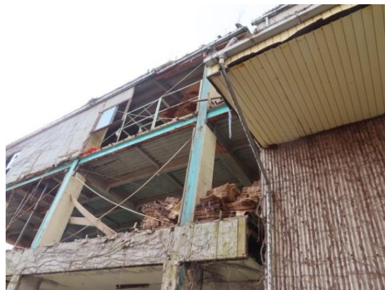
写真 5.5-68 ターンバックルブレースのたわみ
