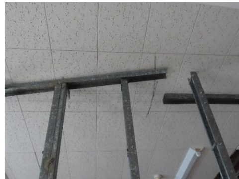
写真 5.6.2.(2)-21 校舎3階 教室の間仕切壁の被害 (左写真の壁上端拡大) (WA-101: 輪島市、教育施設)
