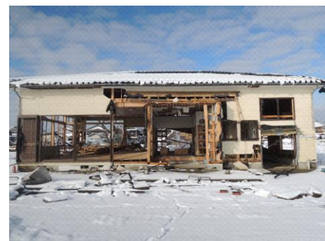
写真 5.7-16 津波による前面の被害
