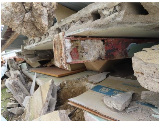
写真 5.5-18 露出柱脚の引き抜け
