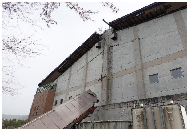
写真 5.3.2-96 妻構面の RC 造壁の面外破壊①
