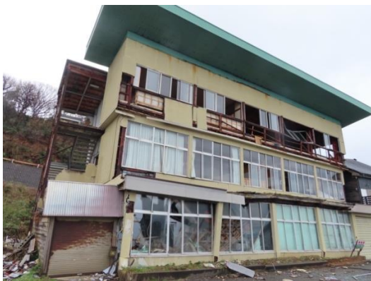
写真 5.5-42 外観(前面の窓ガラスや窓枠の破損、周辺地盤の隆起、沈下)
