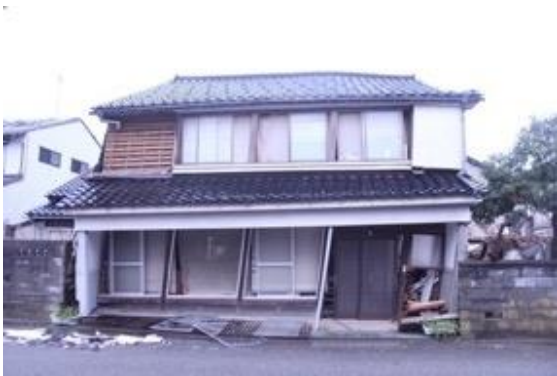
写真5. 2. 2-82 大きく傾斜した木造住宅
