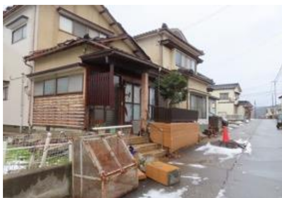
写真 5. 2. 2-68 外壁が剥落した木造住宅
