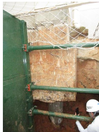
写真 5.4.2-52 杭③パイルキャップの被害状況
