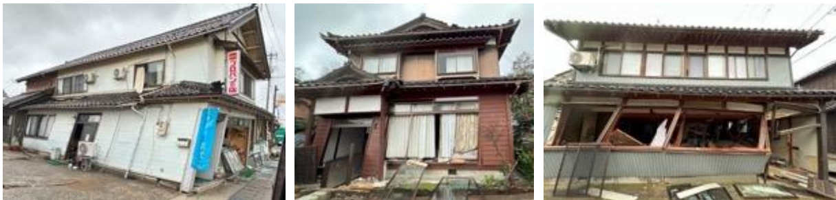
写真5. 2. 2-34 珠洲市正院町正院で一部は安全限界変形を超える大きな残留変形が残る家屋
