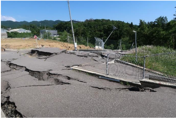
写真 5.3.2-112 建築物 O-4 南側の地盤変状
