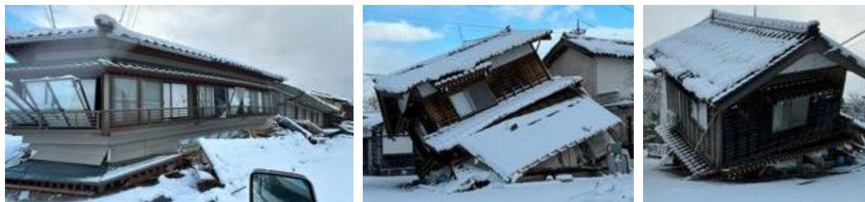
写真5.2.2-13 門前町門前・走出の倒壊家屋群
