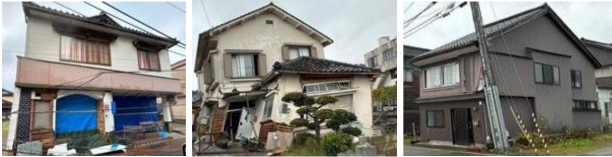
写真5. 2. 2-30 一部は安全限界変形を超えるような大きな残留変形のある木造家屋（珠洲市飯田町）
