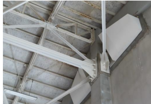
写真 5.5-135 妻壁（反対側）とトラス屋根接続部では損傷無し
