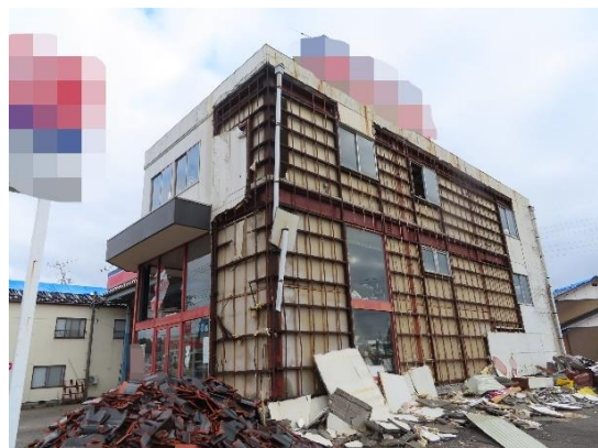
写真 5.5-114 外壁の広範囲の脱落
