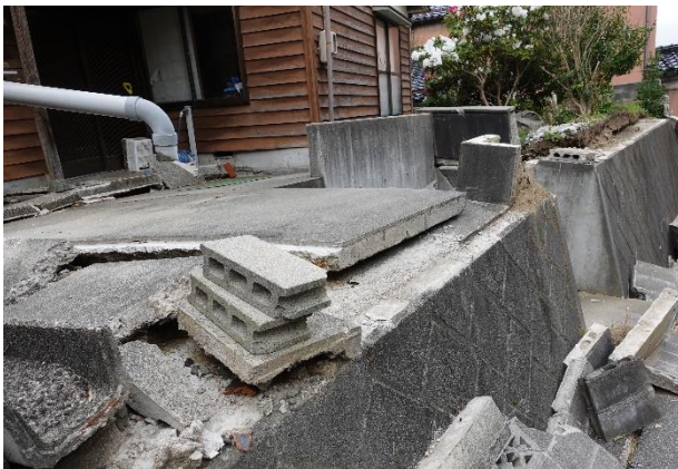
写真 5. 3. 2-190 土間等の変状
