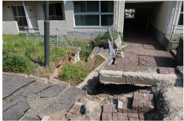
写真 5. 3. 2-61 7~9 通り階段室南側通路の地盤 変状
