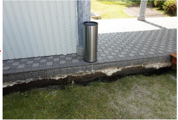
写真 5.3.2-85 J-4 棟周辺の地盤変状
