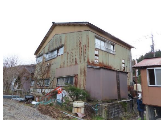
写真 5.5-25 建築物の裏側からは大きな残留変形(たわみ)が見られた
