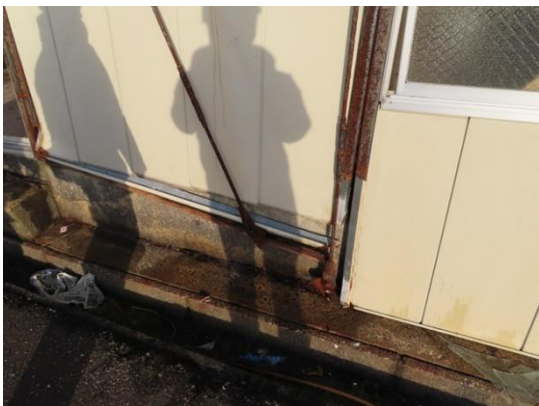
写真 5.5-84 溝形鋼組立て材柱の錆と破断
