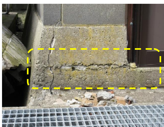
写真 5.3.2-93 建築物 L-2 基礎部の亀裂
