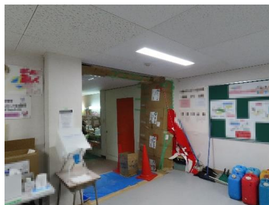
写真 5.6.2.(5)-2 Exp.J 近傍の内装材の被害 (WA-103 : 輪島市、教育施設)
