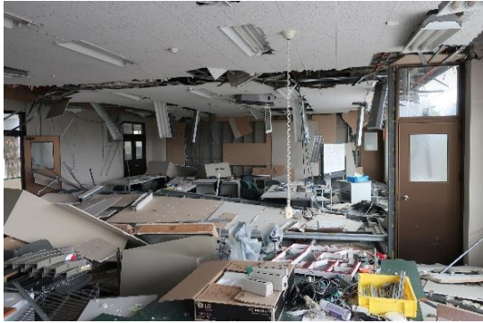
写真 5.6.2. (2)-14 校舎 間仕切壁の転倒等 (AN-101 : 穴水町、教育施設)
