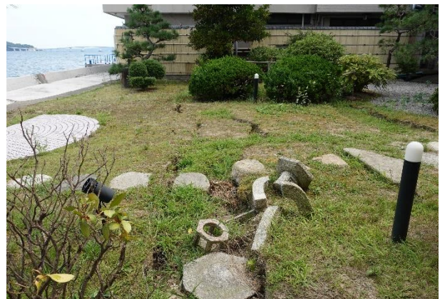
写真 5.3.2-162 AI-2 棟北西部の地盤変状
