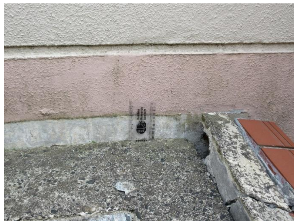
写真 5.3.2-63 周辺の地盤変状
