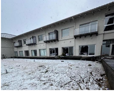
写真 5.7-8 1階の窓ガラスの損傷(1)
