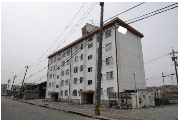
写真 5.3.2-136 建築物 AC-1 外観および塔屋の傾斜
