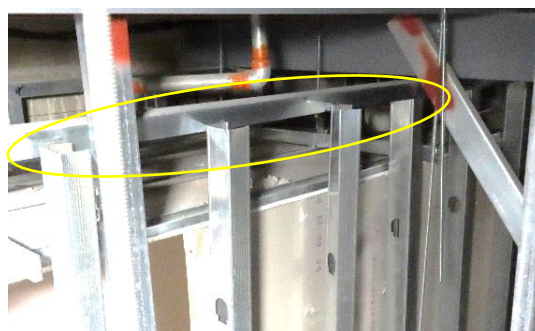
写真 5.6.2.(1)-10 ステージ上立ち上がり壁においてランナから外れたスタッド (AN-103: 穴水町、音楽等用ホール)
