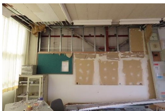
写真 5.6.2.(2)-10 校舎 3階 ブレース構面手前の内壁のボード、下地材の損傷 (WA-111：輪島市、教育施設)
