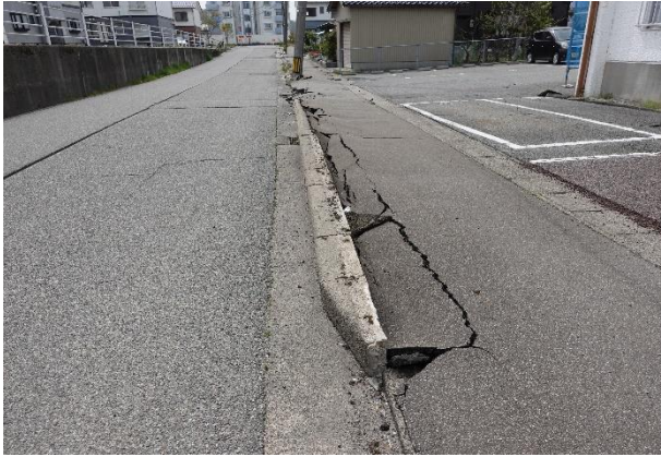
写真 5.3.2-138 建築物 AC-1 東側の地盤変状
