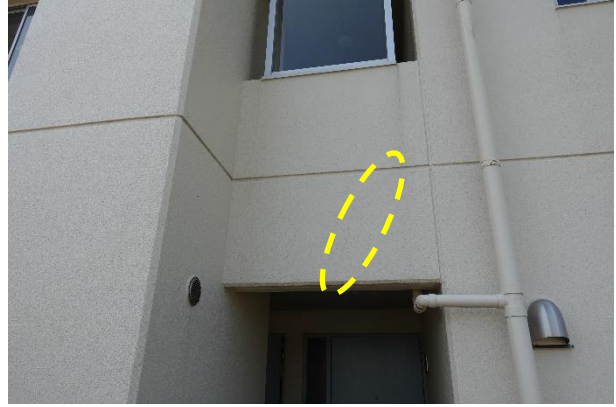
写真 5. 3. 2-59 西側階段室上部のひび割れ
