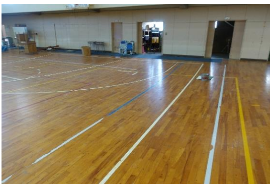
写真 5.5-145 第二体育館 床の沈下
