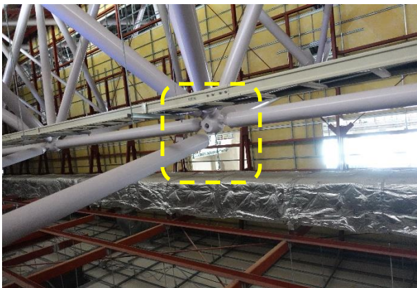
写真 5. 3. 2-102 システムトラス屋根のポールジョイント部での破断
