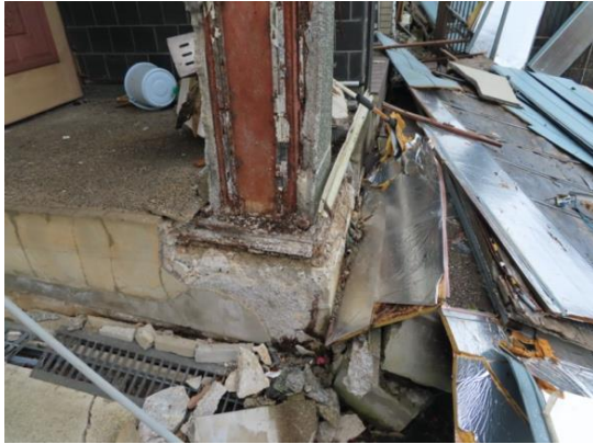
写真 5.5-81 露出柱脚のコンクリートの破壊
