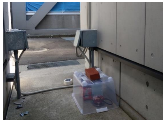
写真 4.4-18 地震計設置状況 (WJMZ、Atom No.6_162)
