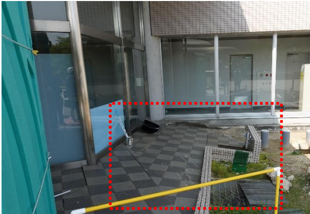
写真 5.3.2-75 J-1 棟周辺の地盤被害
