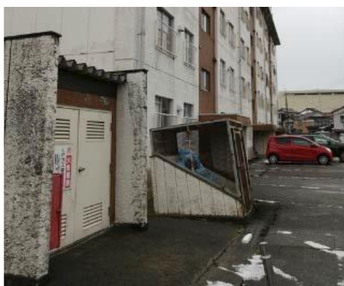
写真 5. 4. 2-41 ごみ集積場の被害（傾斜）
