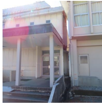
写真 5.5-142 第一体育館と第二体育館の隙 間
