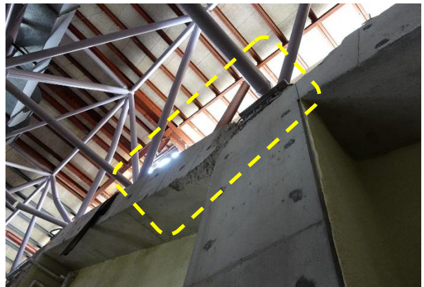
写真 5. 3. 2-101 屋根支承部の接合部損傷
