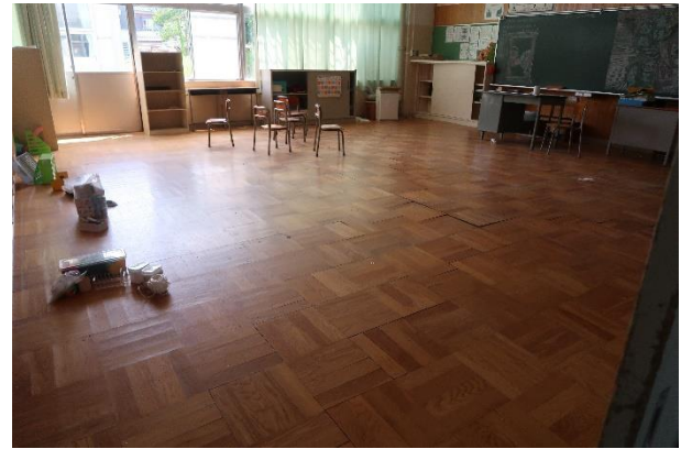
写真 5.3.2-35 建築物 C-4 床面の盛り上がり
