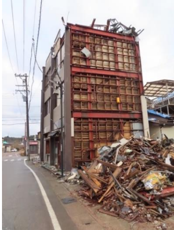
写真 5.6.2.(3)-15 湿式構法による外壁の脱落 (AN-01: 穴水町、店舗兼事務所。写真 5.5-108 を再掲)
