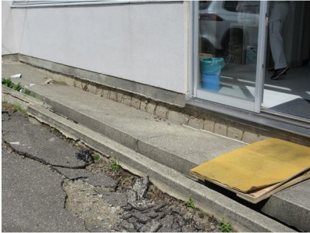
写真 5.3.2-16 建築物 B-4 周辺の地盤変状
