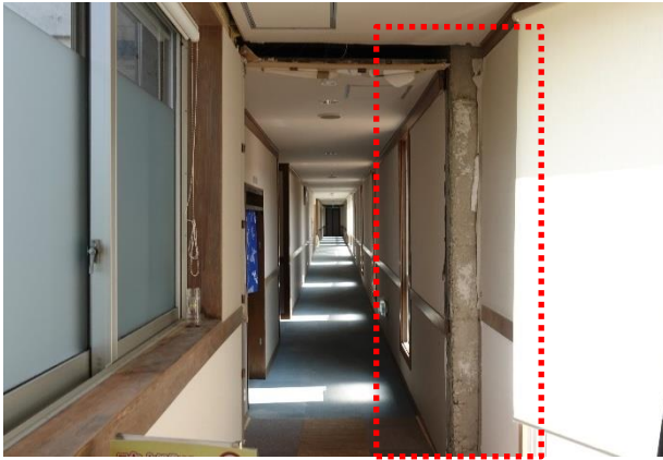
写真 5.3.2-73 J-1 棟-J-2 棟間の Exp. J.部の損傷状況
