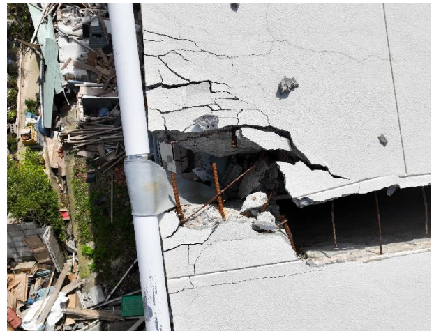
写真 5.3.2-127 西側壁面の損傷 (拡大図)
