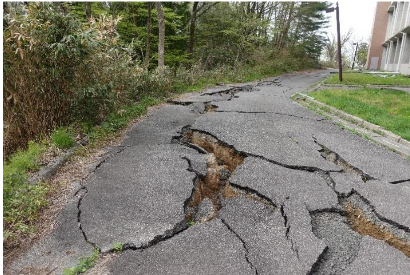
写真 5.3.2-193 建築物 M-1、M-2 周辺の地盤変状
