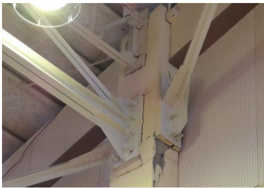
写真 5.5-132 RC造柱のコンクリートのひび割れ
