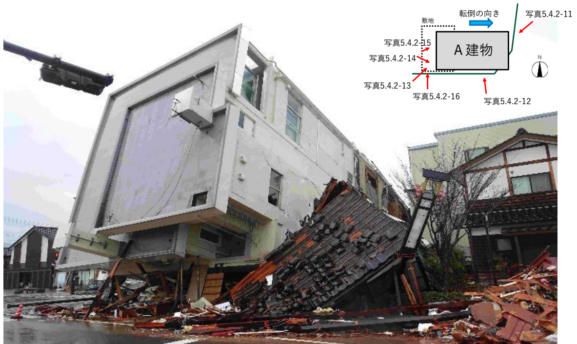
写真 5.4.2-11 転倒したA建物（東側から撮影）
