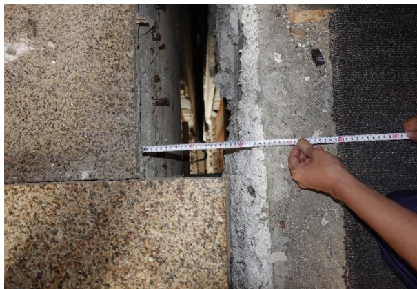
写真 5.3.2-169 7 階の西側棟及び東側棟の離間
