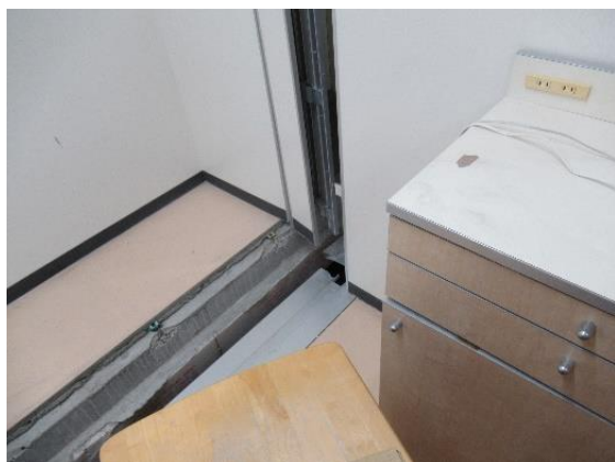
写真 5.3.2-3 Exp. J.の損傷②
