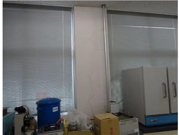
写真 5. 3. 2-183 柱のひび割れ (AN-2)
