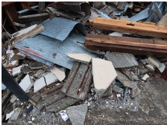
写真 5.5-112 脱落したラスシートモルタル外壁
