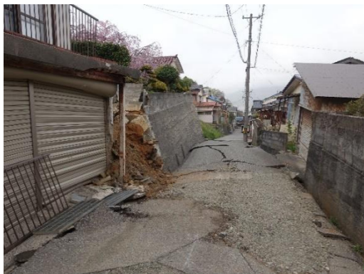
写真 5.3.2-186 地割れの状況①
