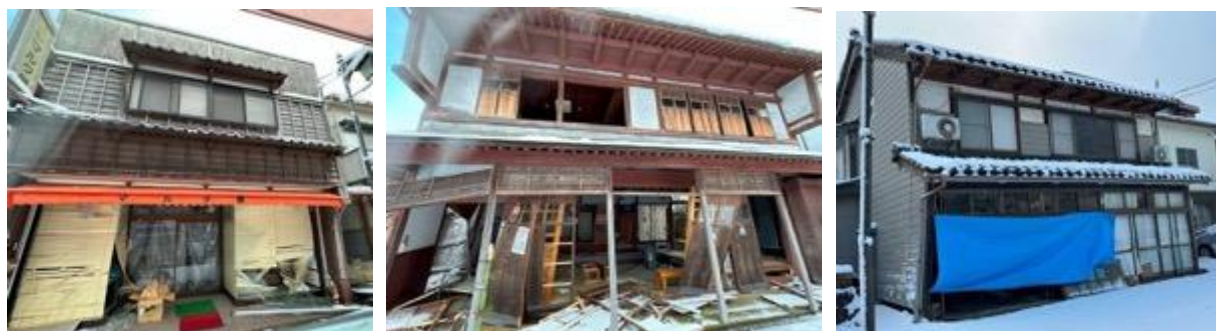
写真5.2.2-14 一部は安全限界変形を超える大きな残留変形のある家屋（門前町門前）
