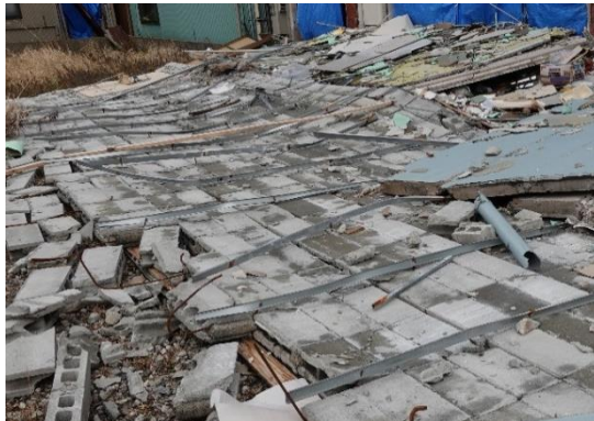
写真 5.5-106 外壁（コンクリートブロック壁）の脱落・転倒
