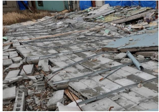
写真 5.6.2.(3)-18 コンクリートブロック壁の脱落・転倒 (NA-04: 七尾市、事務所)
