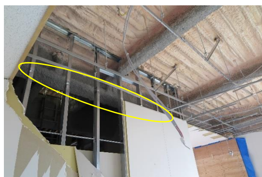
写真 5.6.2.(2)-11 屋内運動場 舞台裏の間仕切壁、天井の被害（天井面高さの位置でスタッドが変形） (WA-102：輪島市、教育施設)
