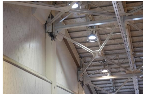
写真 5.5-129 妻面（入り口側）の RC 造柱とトラス屋根の梁の接続部の損傷
