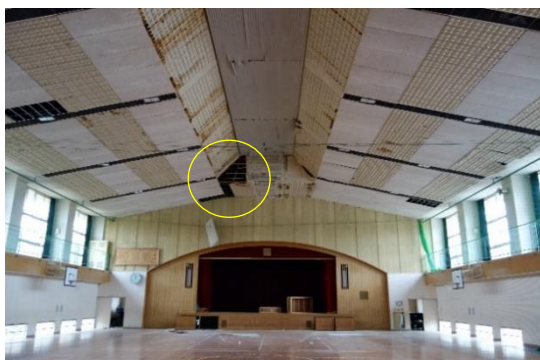
写真 5.6.2.(1)-5 屋内運動場内観（丸囲み部分が損傷箇所） （NA-105：七尾市、教育施設）
