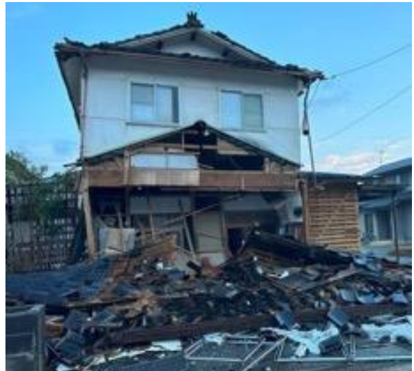
写真5. 2. 2-57 傾斜が残る住宅 (穴水町川島)
