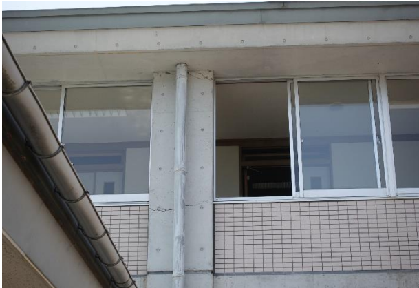
写真 5.3.2-80 2階柱の曲げによる損傷
