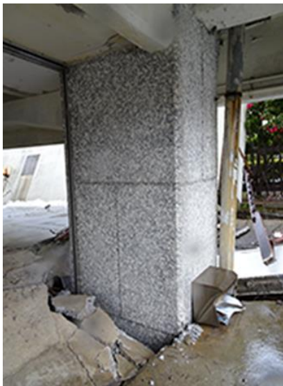
c) 北東隅柱の沈下状況
