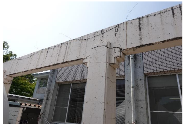
写真 5.3.2-77 柱頭部の曲げひび割れ
