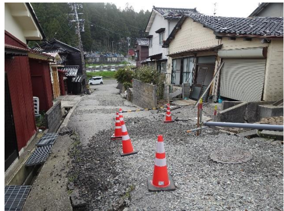
写真 5. 3. 2-191 地割れの状況②
