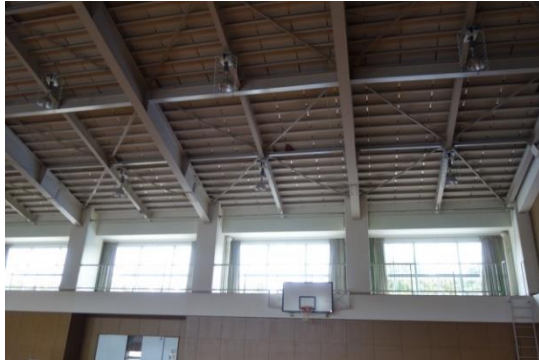
写真 5.5-159 2階体育館の水平ブレースの たわみ
