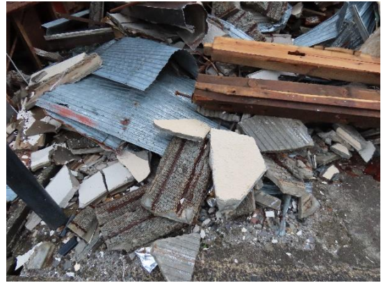
写真 5.6.2.(3)-16 左写真の施設から脱落した外壁 (AN-01: 穴水町、店舗兼事務所。写真 5.5-112 を再掲)
