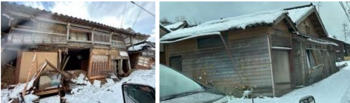
写真5. 2. 2-26 一部は安全限界変形を超えるような大きな残留変形がある家屋（門前町黒島）
