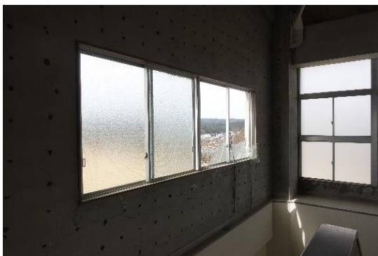
写真 5.6.2(4)-1 屋内運動場 引き違い窓のガラスの破損 (AN-102：穴水町、教育施設)
