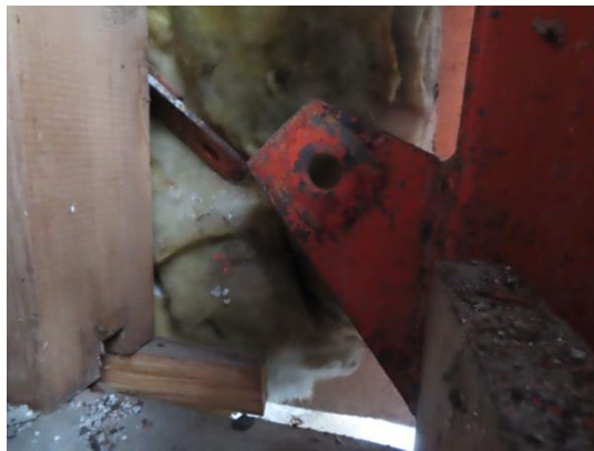
写真 5.5-52 H形鋼柱の弱軸方向におけるブレース端部ボルトの破断、平鋼ブレース変形
