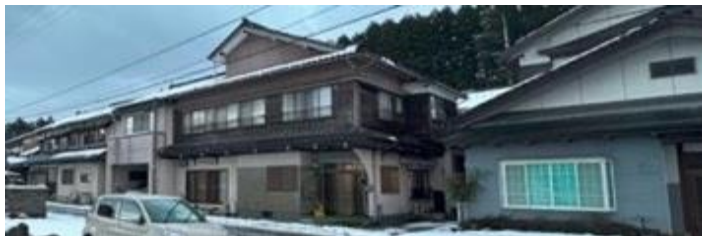
写真 5. 2. 2-67 外観上無被害に見える木造家屋
