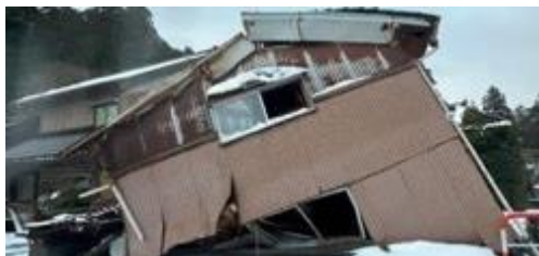
写真 5. 2. 2-66 倒壊した納屋
