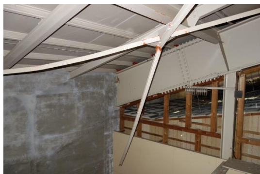
写真 5.5-155 水平ブレース端部の破断
