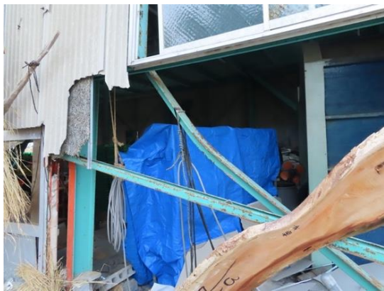
写真 5.5-67 山形鋼ブレース座屈
