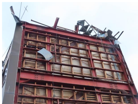
写真 5.5-109 側面の外壁の広範囲での脱落
