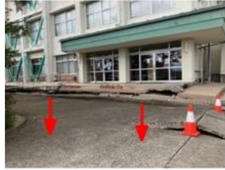
f) 周辺地盤が沈下した建物
