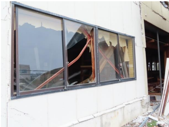
写真 5.5-70 山形鋼ブレースの座屈
