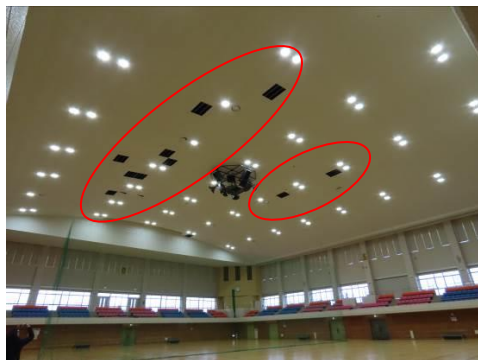
写真 5.6.2.(1)-3 屋内運動場のグラスウール板数枚の落下 （建築物 O：富山市、運動施設）
