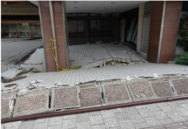
写真 5.3.2-159 AI-1 棟南側の地盤変状
