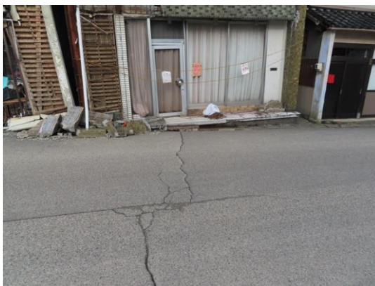
写真 5.5-28 付近の地面の様子
