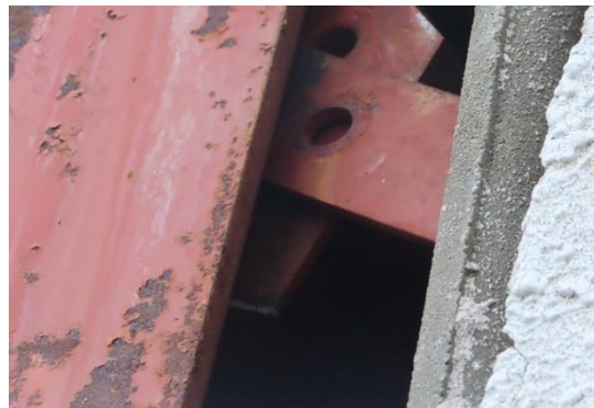
写真 5.5-77 ブレース接合部ボルト無し、ガセット溶接部破断による回転
