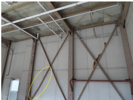
写真 5.5-61 山形鋼ブレースの変形
