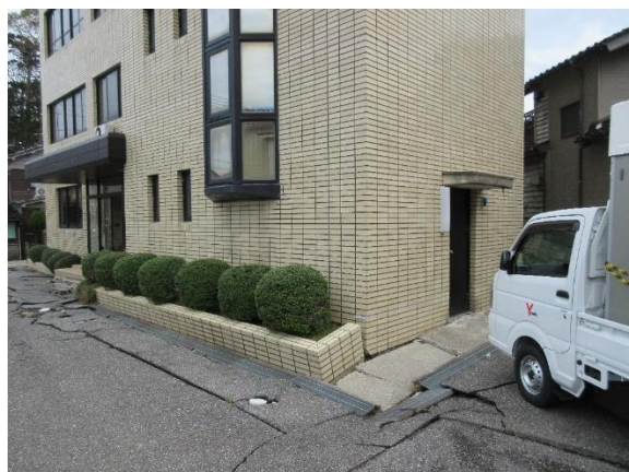
写真 5.3.2-88 周辺の地盤変状
