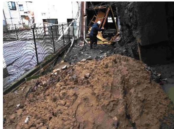
写真 5. 4. 2-16 地表面の変状（敷地の南側）
