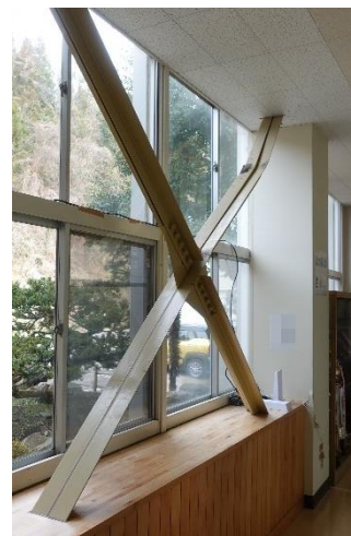
写真 5.5-162 1階ブレースの座屈の 被害
