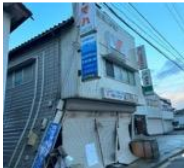
写真5. 2. 2-56 傾斜が残る店舗併用住宅 (穴水町川島)
