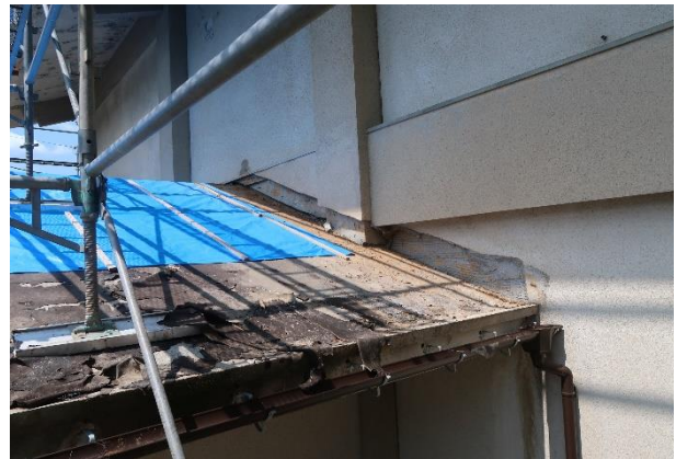
写真 5.3.2-179 外壁等の仕上げ材の剥落
