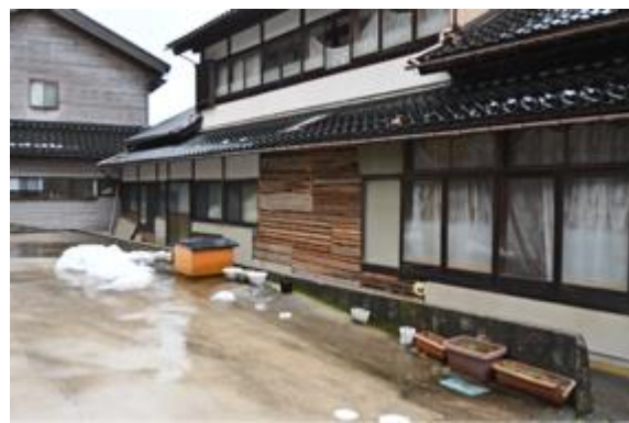
写真5.2.2-75 外壁の剥落した木造住宅
