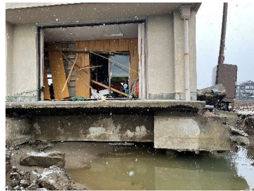
写真 5.7-12 RC造建築物周囲の地盤の洗掘
