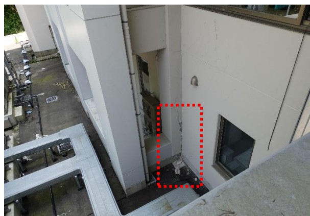
写真 5.3.2-67 柱のひび割れ
