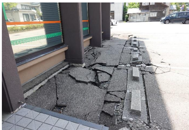
写真 5. 3. 2-154 建物周辺地盤の変状
