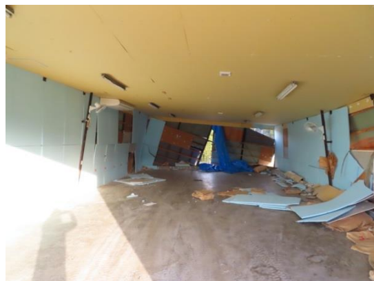
写真 5.5-37 床の沈下、傾斜
