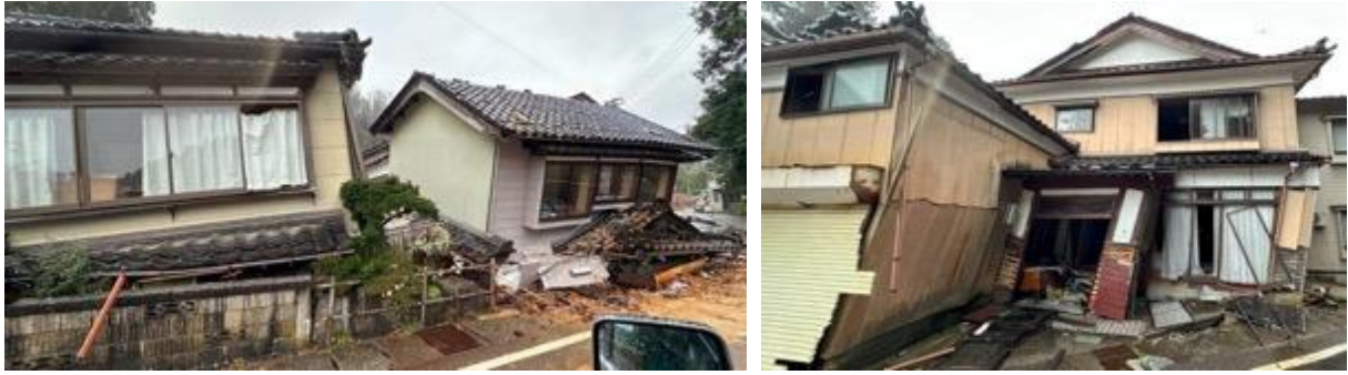
写真5. 2. 2-29 珠洲市役所前以外で倒壊を含む大きな被害を受けた家屋（珠洲市上戸町）
