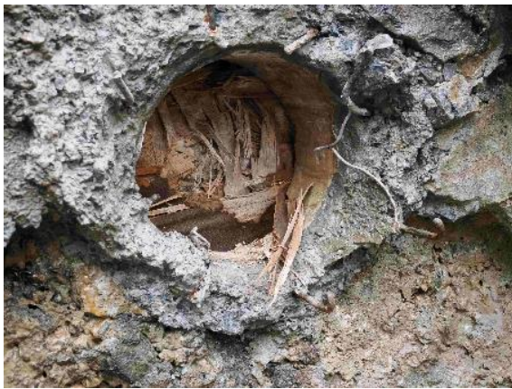
a) パイルキャップの木片
