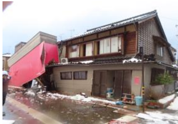
写真5. 2. 2-65 倒壊した木造店舗併用住宅
