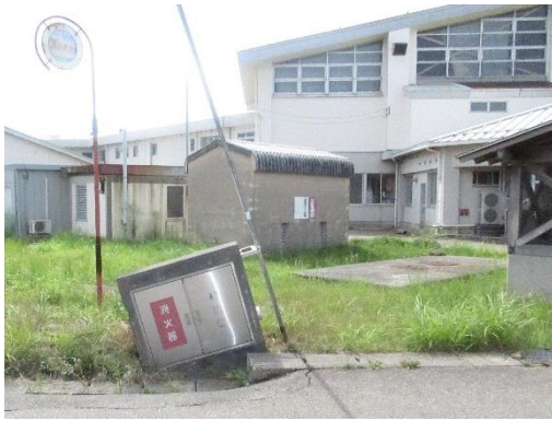
写真 5.4.2-49 敷地地盤の変状 (右奥がS棟)
