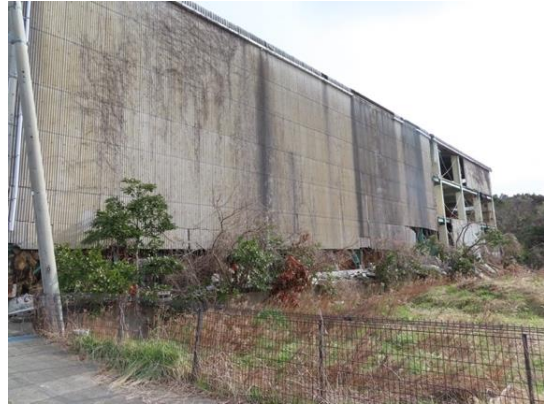
写真 5.5-64 建築物背面の外壁の脱落
