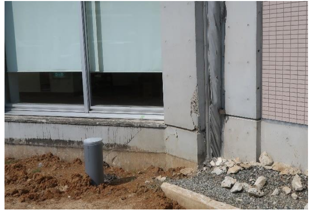
写真 5.3.2-74 1 階柱脚の被害 (J-1 棟)
