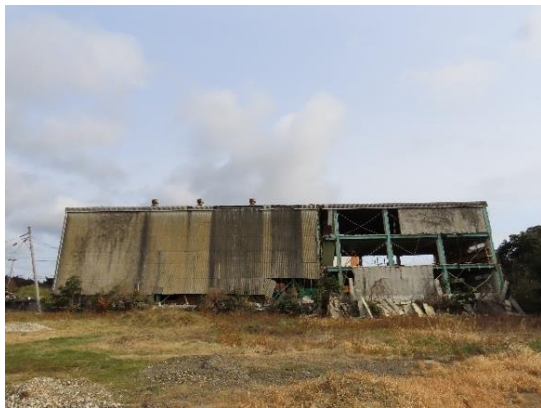
写真 5.5-65 建築物背面の外壁の脱落
