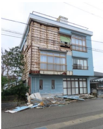
写真 5.5-78 外壁の脱落（表側）
