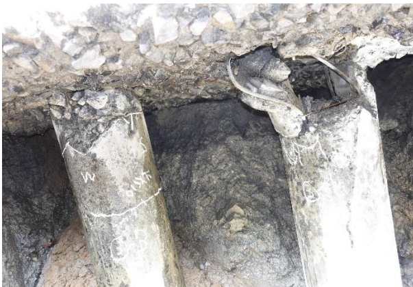
写真 5.3.2-8 杭 No.③の損傷状況 (左杭：No.③-3、右杭：No.③-1)
