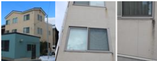
写真5.2.2-84 珠洲市野々江町の3階建枠組壁工法住宅の開口周囲のひび割れ (2004年竣工)
