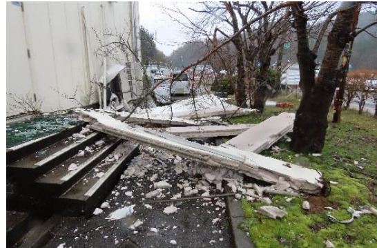
写真 5.6.2.(3)-6 左写真の外壁から落下した ALC パネル (WA-101：輪島市教育施設)
