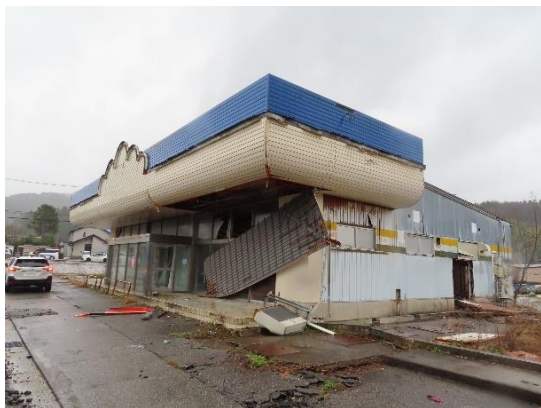
写真 5.5-96 外観（軒天井の脱落）
