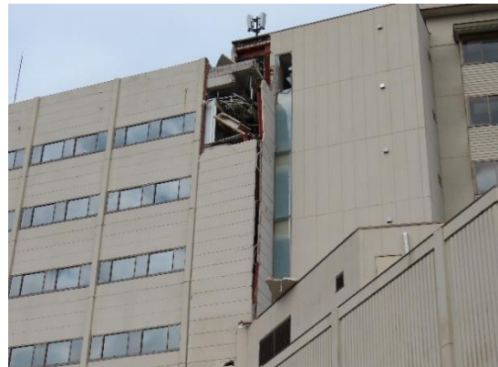
写真 5.6.2.(3)-8 ALC パネルによる外壁の脱落 (NA-07：七尾市、宿泊施設)
