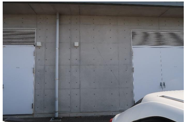
写真 5.3.2-117 建築物 O-1 壁のひび割れ
