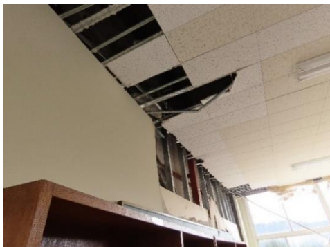
写真 5.6.2.(1)-25 校舎 3階天井・内壁の被害（WA-111：輪島市、教育施設）
