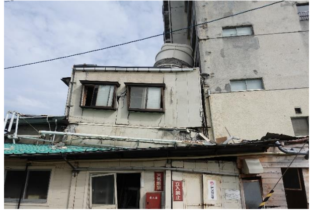
写真 5.3.2-166 西側棟の傾斜による北側 2 階建て建築物の被害
