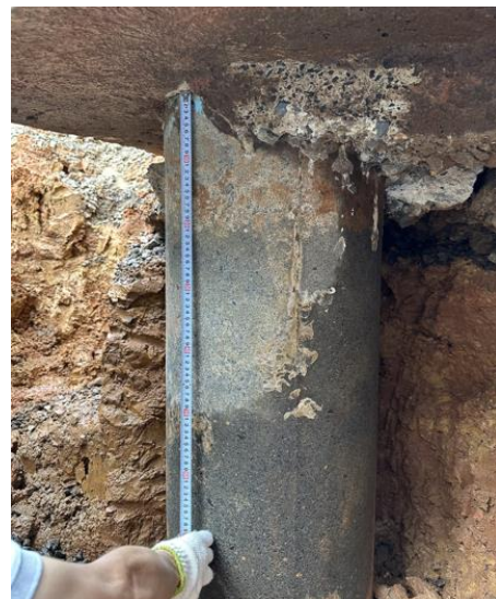
写真 5.3.2-123 杭の損傷状況 (④)
