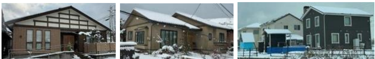
写真5.2.2-22 外観上無被害に見える築年数の浅い家屋（門前町道下・館）
