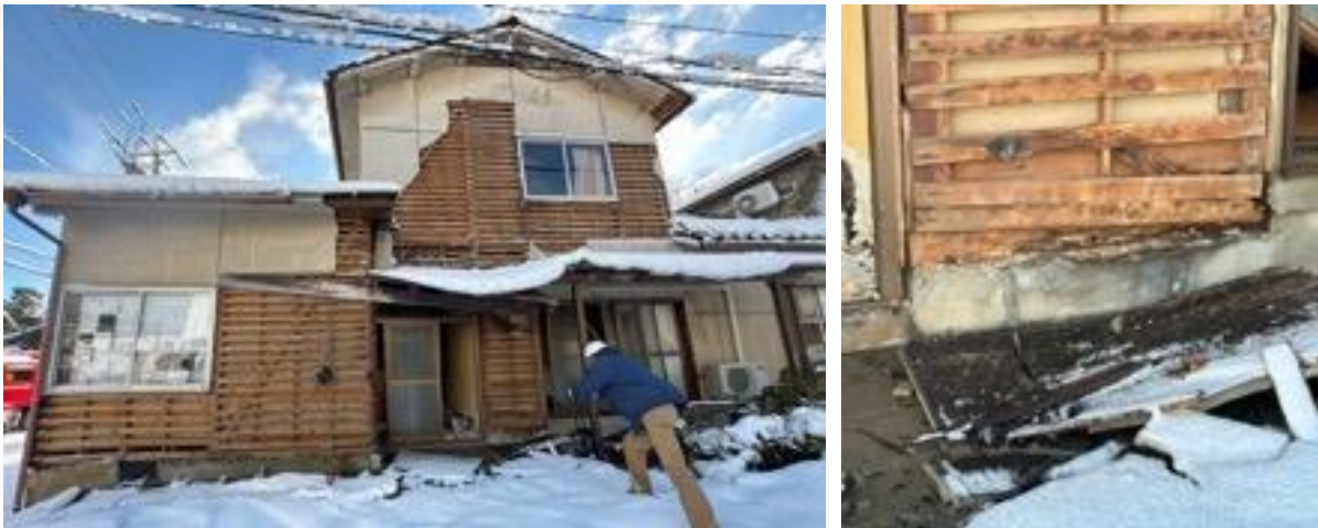
写真5.2.2-17 モルタル外壁が大規模に剥落した住宅とその土台の腐朽
