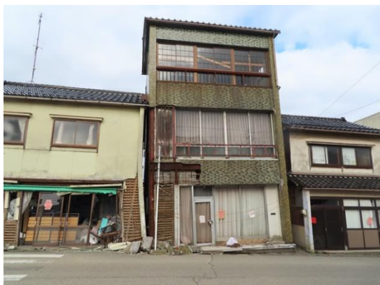
写真 5.5-27 外観（建築物全体の傾斜）
