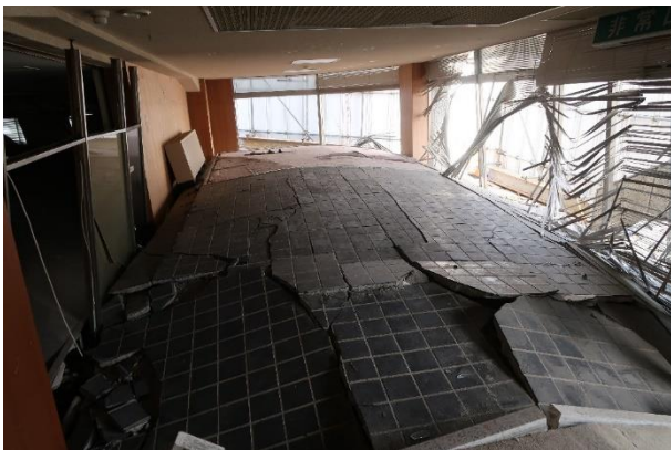
写真 5. 3. 2-133 Y1~Y2 構面 1 階床の膨れ上がり
