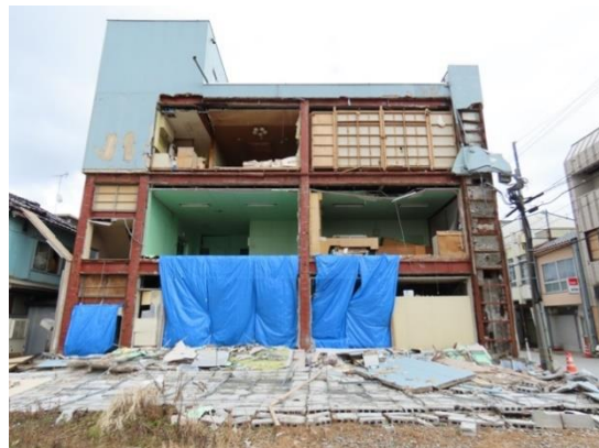
写真 5.5-103 外壁（ALCパネル、コンクリートブロック壁）の広範囲での脱落・転倒
