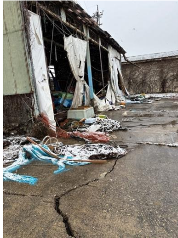
写真 5.7-11 鉄骨造倉庫の被害
