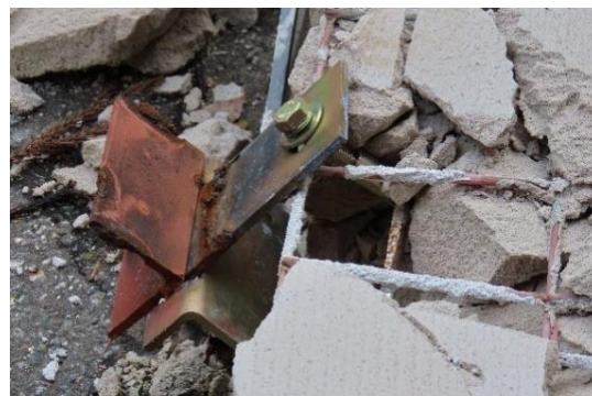
写真 5.6.2.(3)-4 鉄骨屋外階段付近の落下した ALC パネル (WA-111：輪島市、教育施設)
