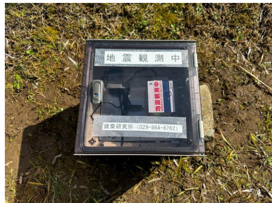
写真 4.4-6 強震計設置状況 (WJMC1 : 南側地表、Sonas No.7)
