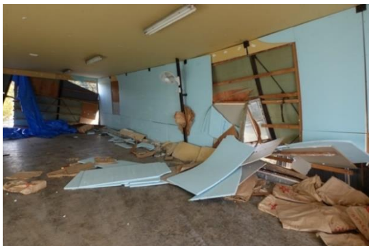
写真 5.5-38 組立て材のフレームの端部の破断と傾き、はらみ出し、外壁、内壁の破損
