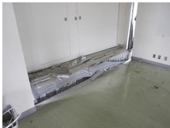
写真 5.4.2-38 建物の傾斜による 2 階のエキスパンションジョイントの破損
