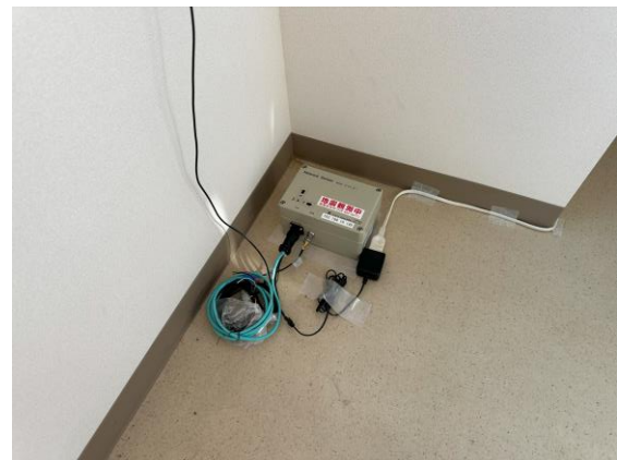
写真 4.4-15 強震計設置状況 (WJMF4 : 北側3階、CV374_148)
