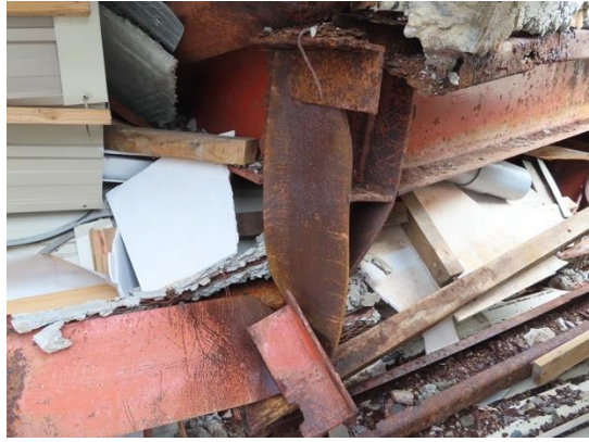
写真 5.5-12 1階 H 形鋼柱の柱頭部の座屈
