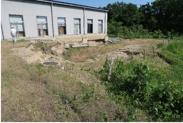
写真 5.3.2-110 建築物 O-3 南西部の地盤変状
