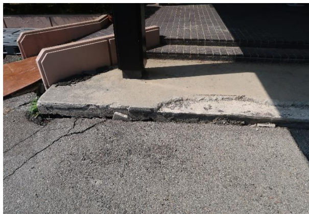
写真 5.3.2-156 周辺地盤の変状
