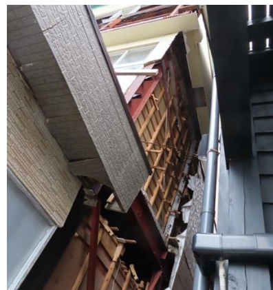
写真 5.5-43 2階のターンバックルブレース端部の破断・脱落
