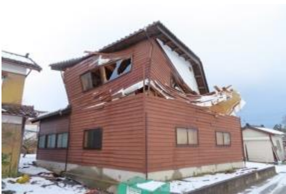
写真5.2.2-50 2層が崩壊した木造住宅
