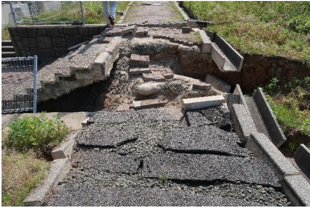
写真 5. 3. 2-60 7~9 通り階段室南側通路の地盤 変状
