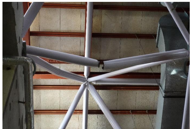
写真 5. 3. 2-103 システムトラス屋根の主部材の座屈及び破断
