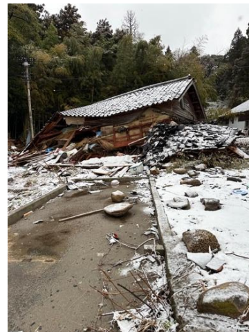
写真 5.7-23 移動した住宅
