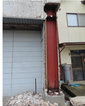
写真 5.5-75 柱脚の錆と腐食
