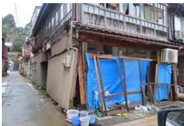
写真 5. 2. 2-69 大きく傾斜した木造店舗併用住宅
