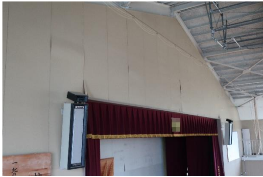
写真 5.6.2.(2)-5 屋内運動場 1 プロセニウムアーチの内装仕上材の損傷 (NA-106 : 七尾市、教育施設)
