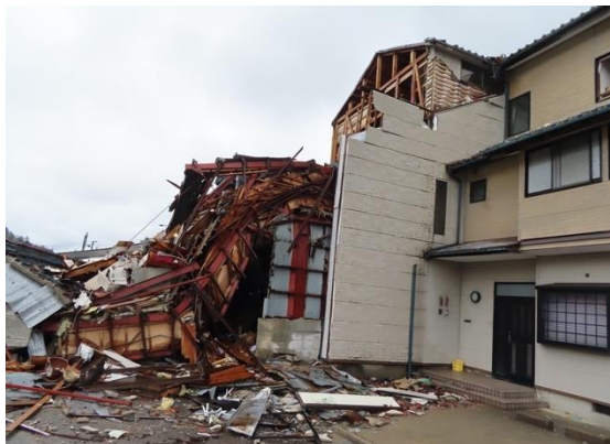
写真 5.5-1 2階と3階が西側に倒壊（写真の手前が南側の木造住宅）
