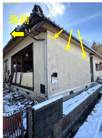
写真 5.7-30 漂流物による外壁の被害と津波の痕跡
