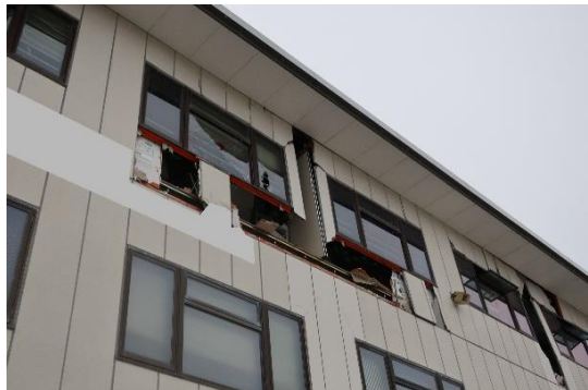
写真 5.6.2. (2)-18 校舎桁行方向の外装材の脱落 (AN-101 : 穴水町、教育施設)
