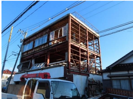
写真 5.5-54 建築物側面の広範囲で外壁脱落
