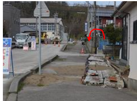
j) 擁壁の転倒
