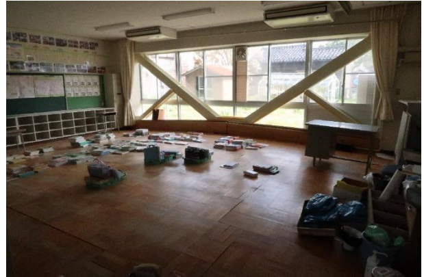
写真 5.3.2-17 建築物 B-1 1階床の膨れ上がり
