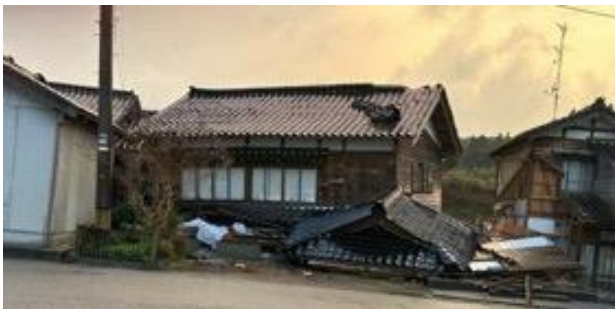
写真5. 2. 2-54 穴水町志ヶ浦の倒壊家屋
