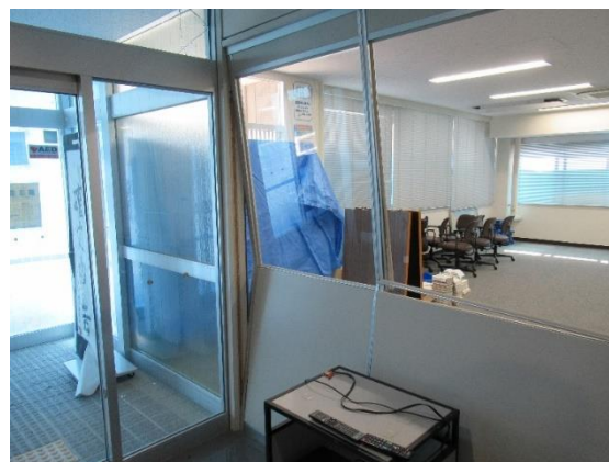
写真 5.3.2-4 間仕切りの損傷
