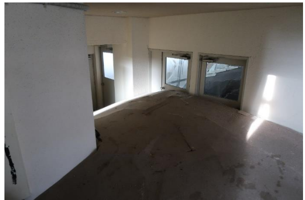
写真 5. 3. 2-134 Y2~Y3 構面 1 階床の膨れ上がり
