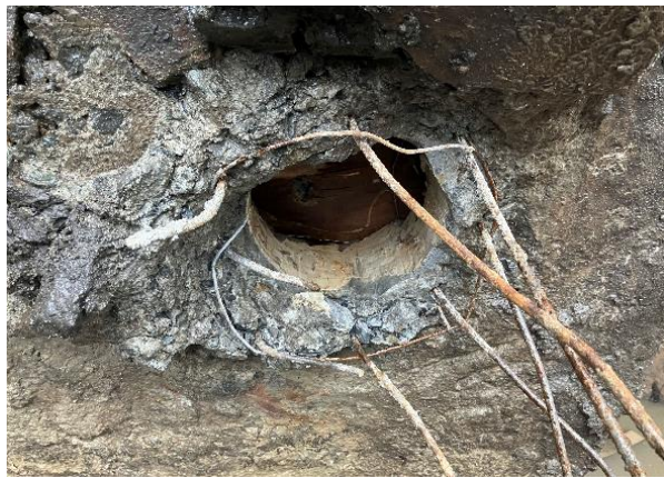
b) パイルキャップ部に残った杭の一部
