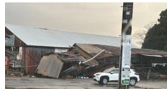
写真5. 2. 2-55 穴水町志ヶ浦の工場社屋の倒壊
