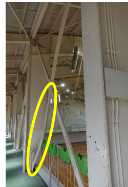
写真 5.5-146 第二体育館 ブレース (CT形鋼) の面外たわみ
