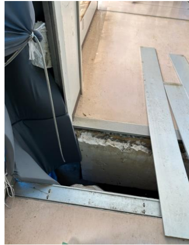
写真 5.3.2-120 Exp. J.の損傷
