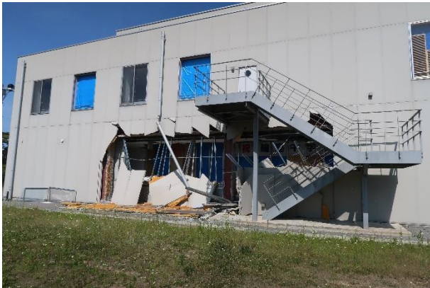
写真 5.3.2-114 建築物 O-2 の西面の外装損傷
