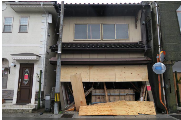
写真5. 2. 2-81 大きく傾斜した木造店舗併用住宅
