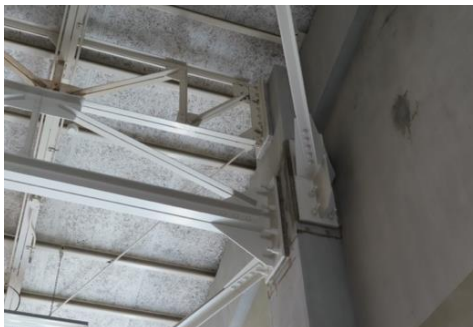
写真 5.5-136 妻面（反対側）のRC造柱とトラス屋根接続部では損傷無し
