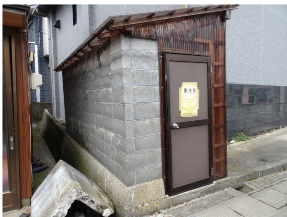
写真 5.3.2-92 建築物 L-2 の傾斜
