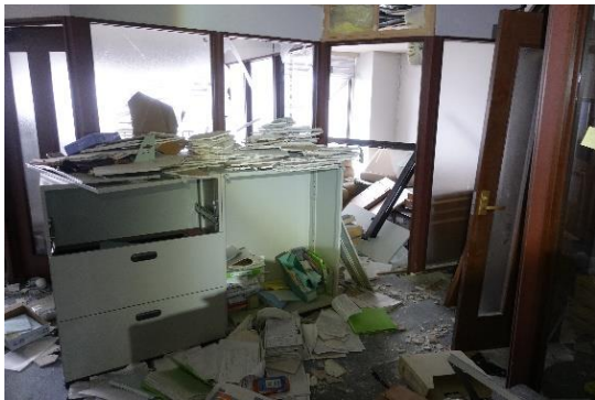
写真 5.6.2. (2)-16 事務所5階執務室 ガラス窓被害、天井・間仕切壁の被害 (WA-104 : 輪島市、音楽等用ホールを有する施設)
