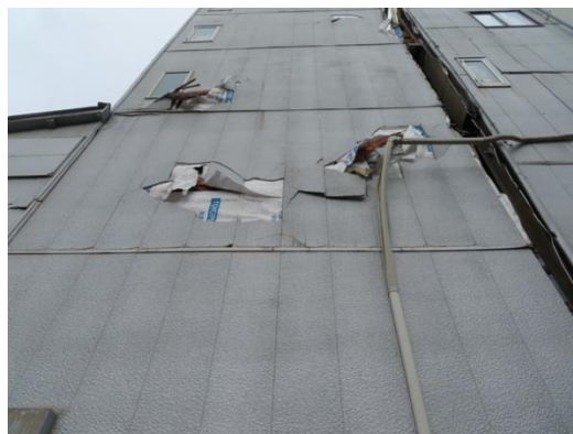
写真 5.6.2.(3)-19 平鋼ブレースの変形とそれによる外壁の被害 (WA-03: 輪島市、店舗兼住宅。写真 5.5-45 を再掲)
