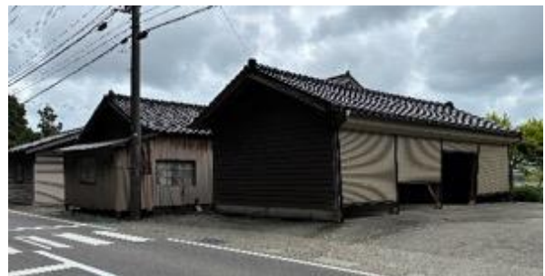
写真5. 2. 2-42 写真5.2.2-41の近傍で2023年地震時に倒壊を免れた家屋 (2023年5月撮影)
