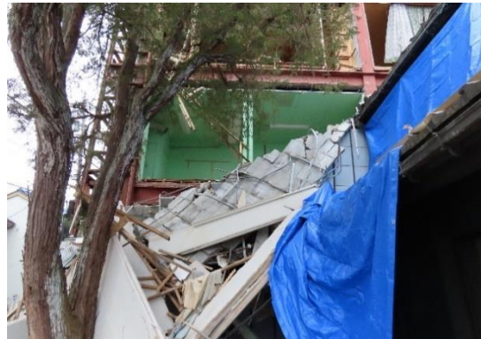
写真 5.5-107 外壁（コンクリートブロック壁）の脱落
