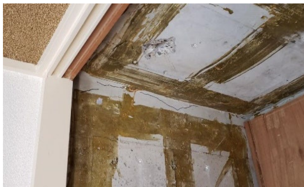
写真 4.5-1 下階壁のひび割れ
