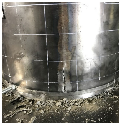
(c) 破壊状況 : 鋼管端部破壊状況
