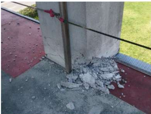
(c) 前震後の3階柱脚の損傷 (Ya2 構面, 図 3.2.4 における B 部分)
