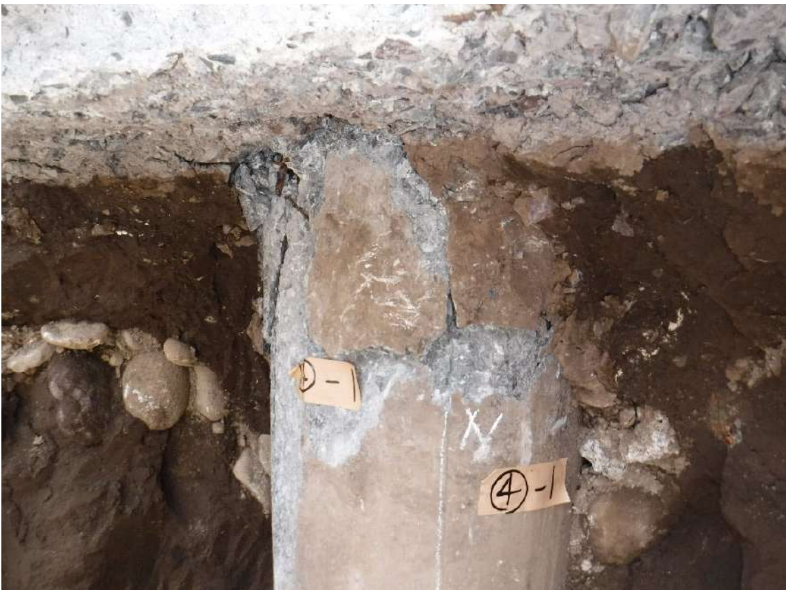
写真 7.4.2.28 杭④-1の杭頭部の状況
