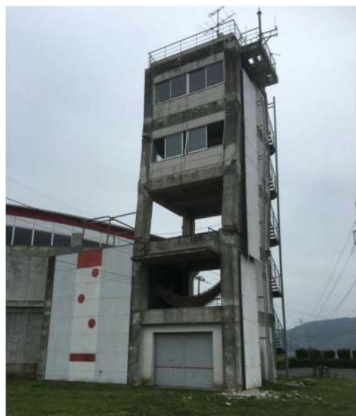
(b) 本震後の被害 (Ya2 構面)
