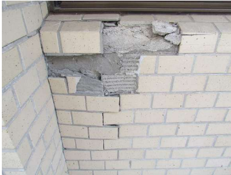
写真 7.4.1.2 タイル剥落部の拡大写真
