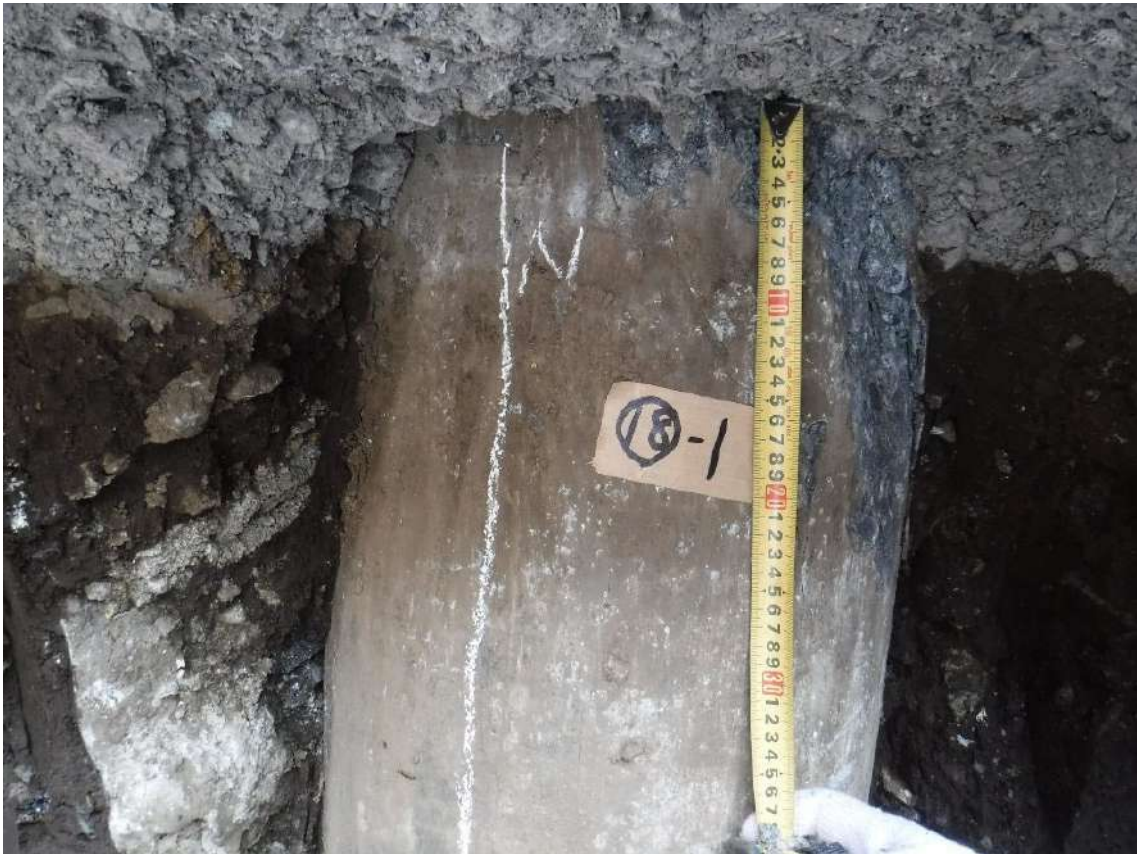
写真 7.4.2.49 杭⑱-1の杭頭部の状況
