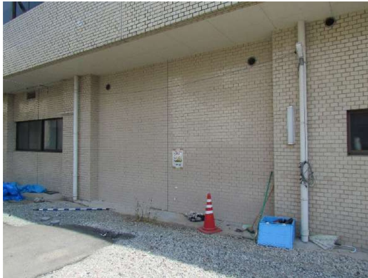
写真 7.4.1.8 損傷度 I の両側柱付壁
