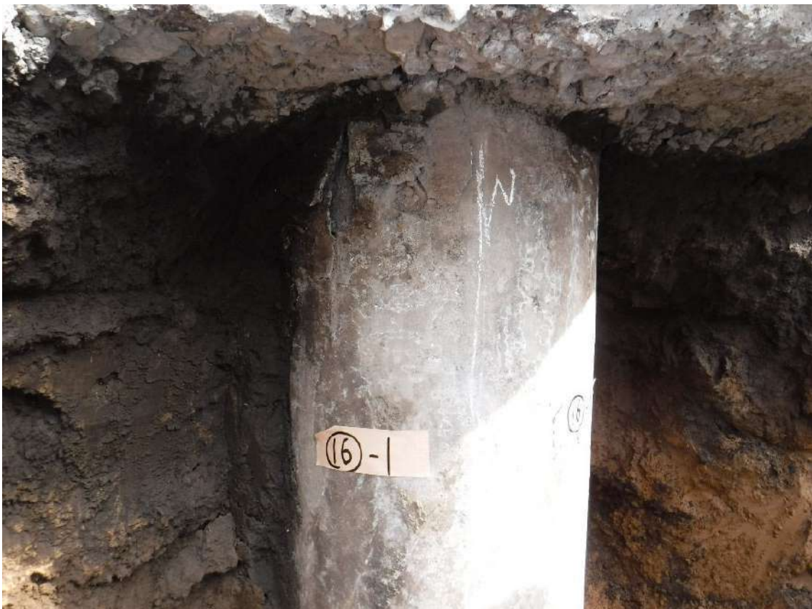
写真 7.4.2.46 杭⑯-1の杭頭部の状況
