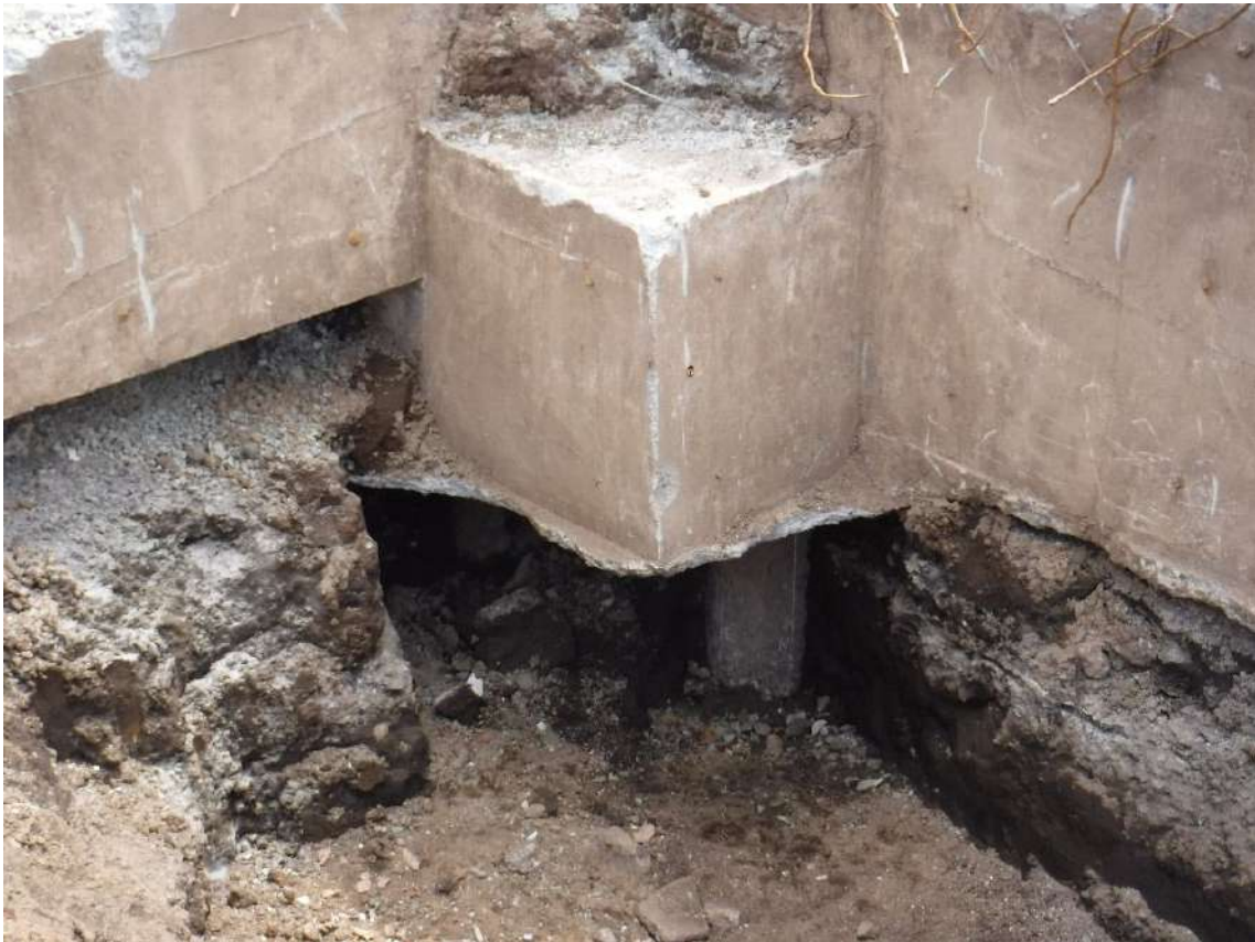
写真 7.4.2.13 基礎フーチング⑨周辺の状況
