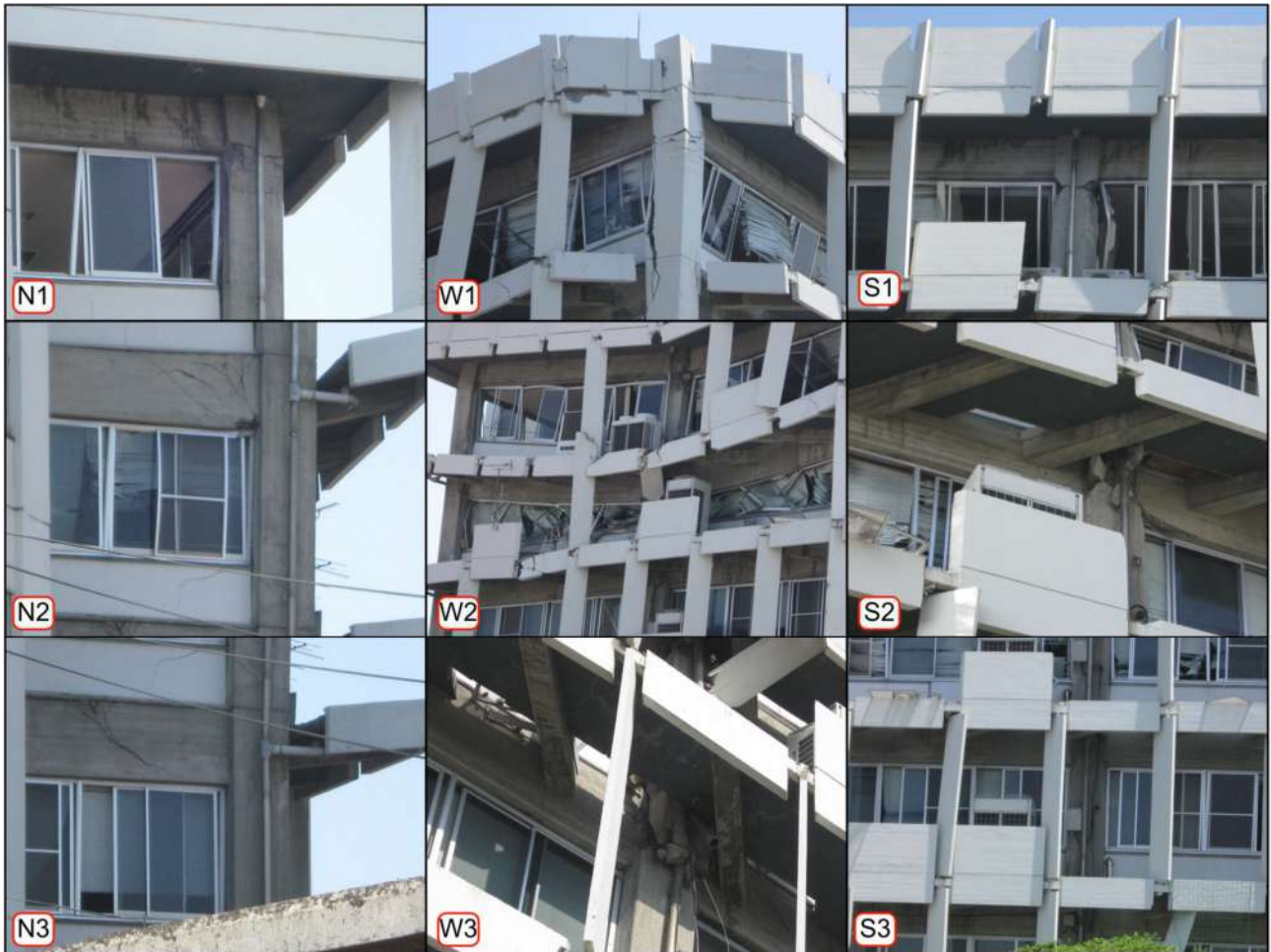
図 9.3.1 北面・西面・何面の損傷状況 [9.3-2]
