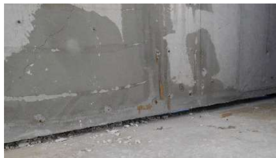
写真 4.3.1.4 2階戸境壁の脚部の離間
