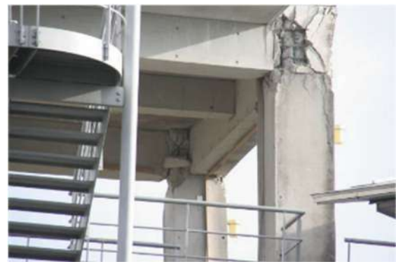
(f) 4階柱梁接合部の損傷 (Ya1 構面, 図 3.2.4 における H 部分)
