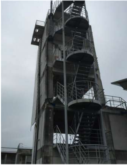
(c) 本震後の被害 (Ya1 構面)
