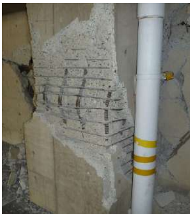
写真 4.3.1.1 1階 X4Y2 柱の損傷状況
