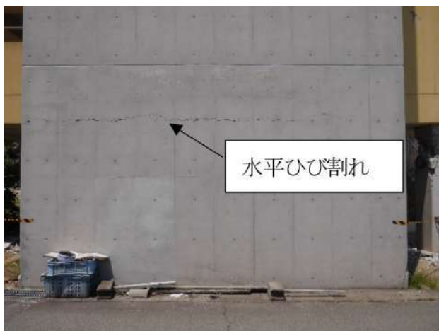
(a) 桁行外柱連層耐力壁 (水平ひび割れ)
