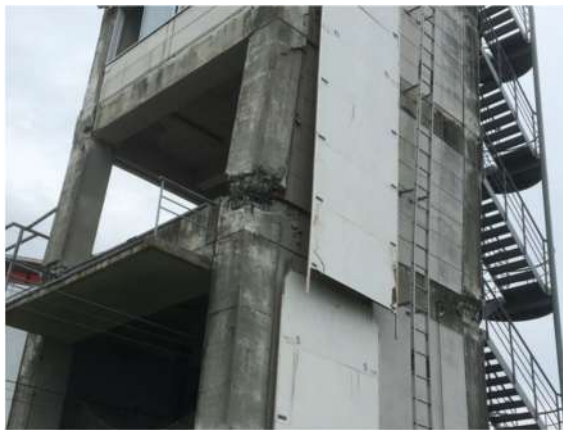
(e) 本震後の3階部分の損傷 (Ya2 構面)
