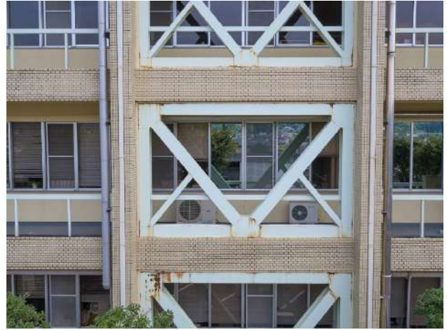
写真 8.4.3.34 ブレース⑦の損傷 (2000 万画素)
