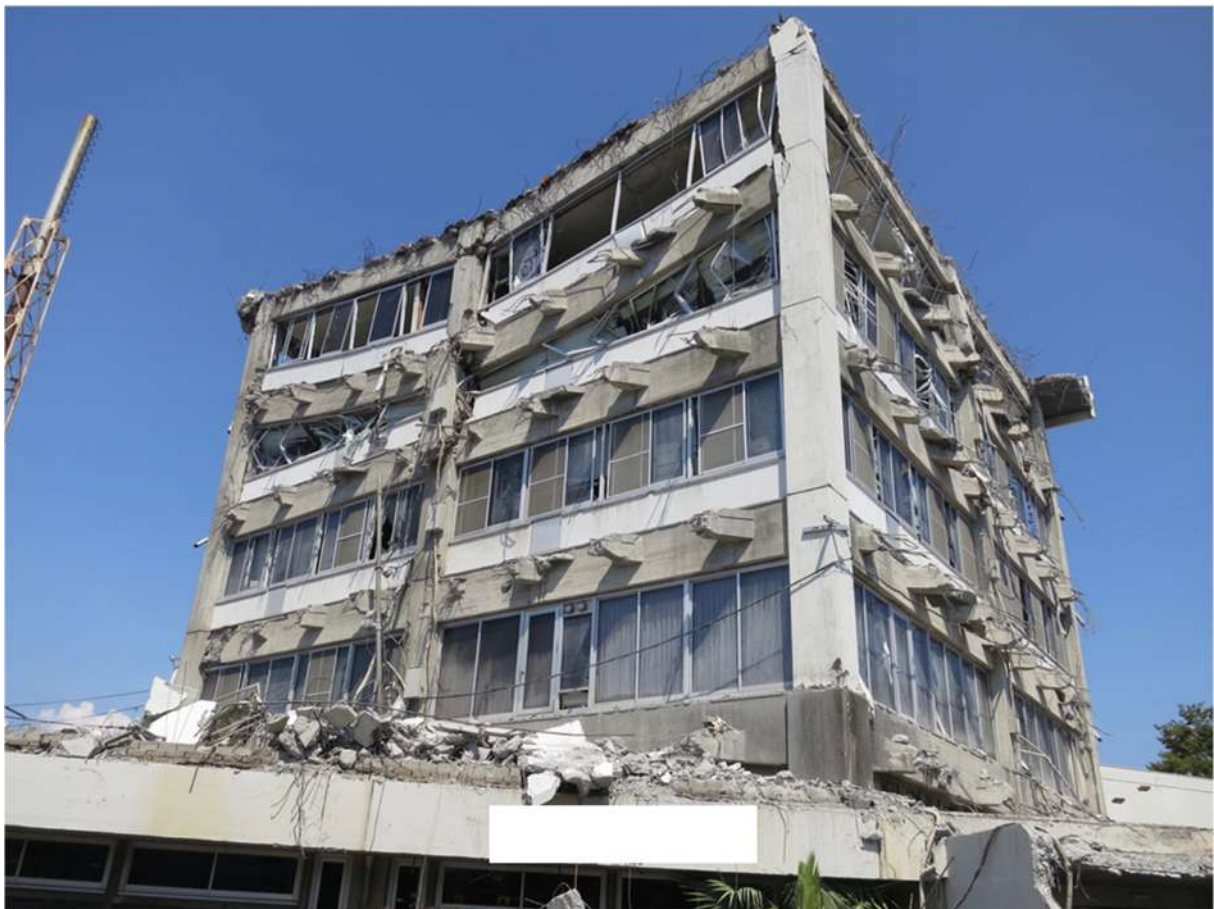
写真 9.1.1 被災後(解体中)の庁舎建物（建築物G）
