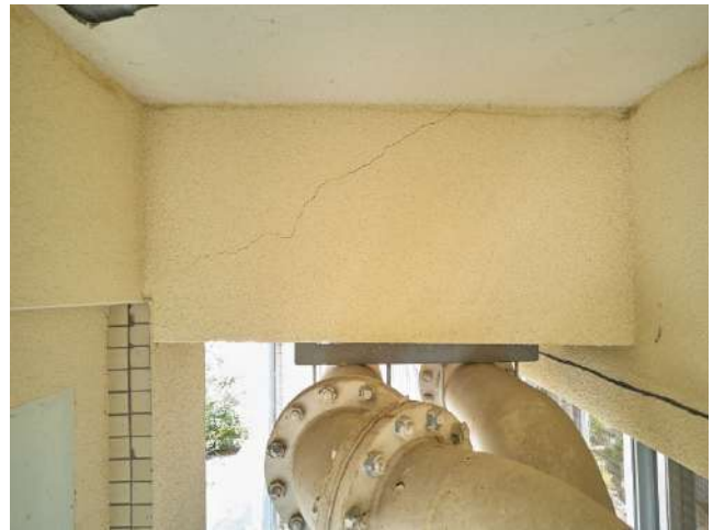
写真 8.4.3.30 梁Dの損傷
