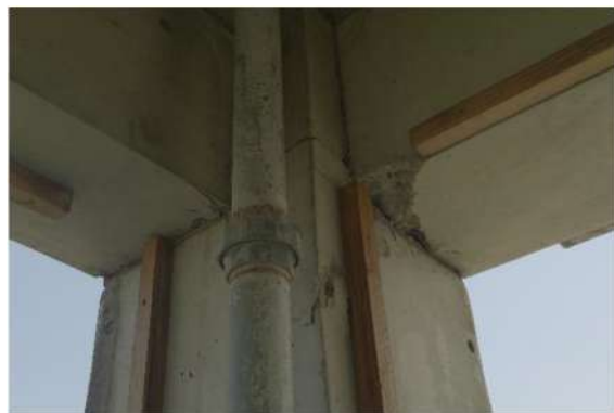
(d) 前震後の4階大梁の損傷 (Ya2 構面, 図 3.2.4 における A 部分)
