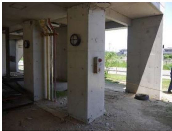
写真 5.3.3 X5-Y3 柱 (曲げ降伏, 損傷度Ⅲ)
