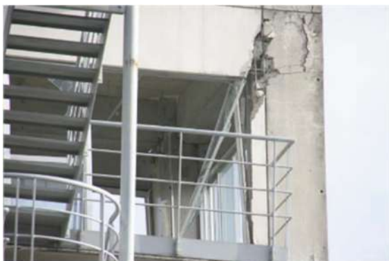
(g) 本震後の5階柱梁接合部の損傷 (Ya1 構面, 図 3.2.4 における G 部分)
