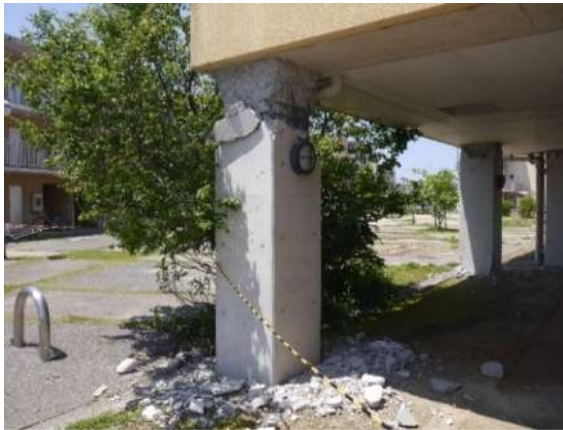
(a) 東側から見た柱全景
