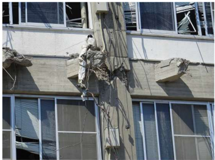
(d) 4階十字形柱梁接合部 (南側面)
