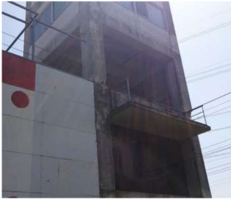
(a) 前震後の被害 (Ya2 構面)
