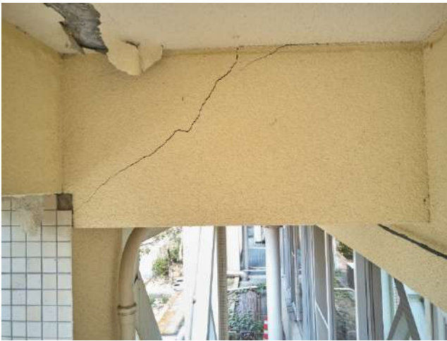
写真 8.4.3.29 梁Cの損傷
