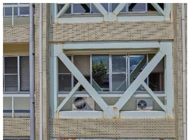
写真 8.4.3.32 ブレース⑦の損傷 (1億画素)
