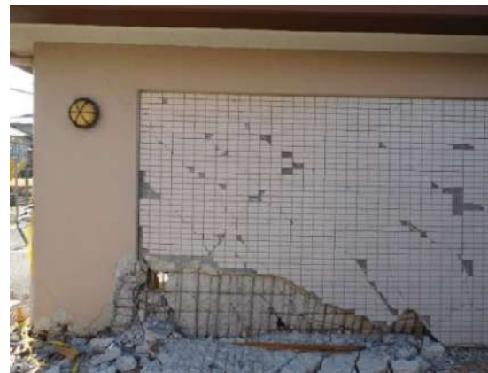
写真 4.3.1.2 1階 X5Y1 柱と X5 壁の損傷状況
