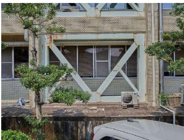
写真 8.4.3.31 ブレース⑥の損傷 (1億画素)
