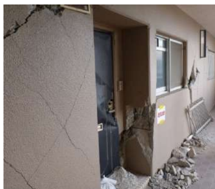
写真 4.3.1.6 2階共用廊下側の損傷状況
