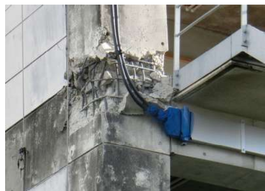
(i) 本震後の3階柱脚部の柱梁接合部の損傷 (Ya1 構面, 図 3.2.4 における D 部分)
