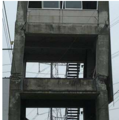
(d) 本震後の3階柱脚部の損傷 (Ya2 構面)
