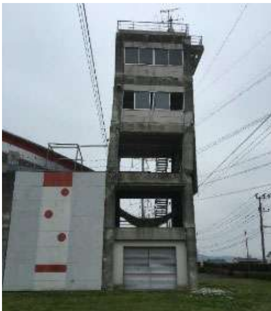
(a) 本震後の被害 (Ya2 構面)
