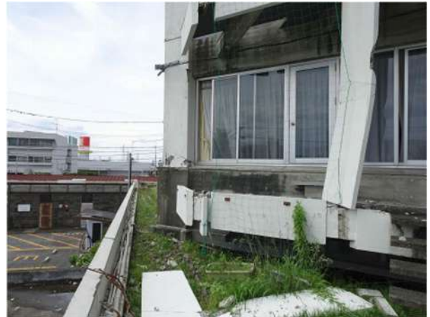
写真 9.3.4 南側2階柱脚部の破壊
