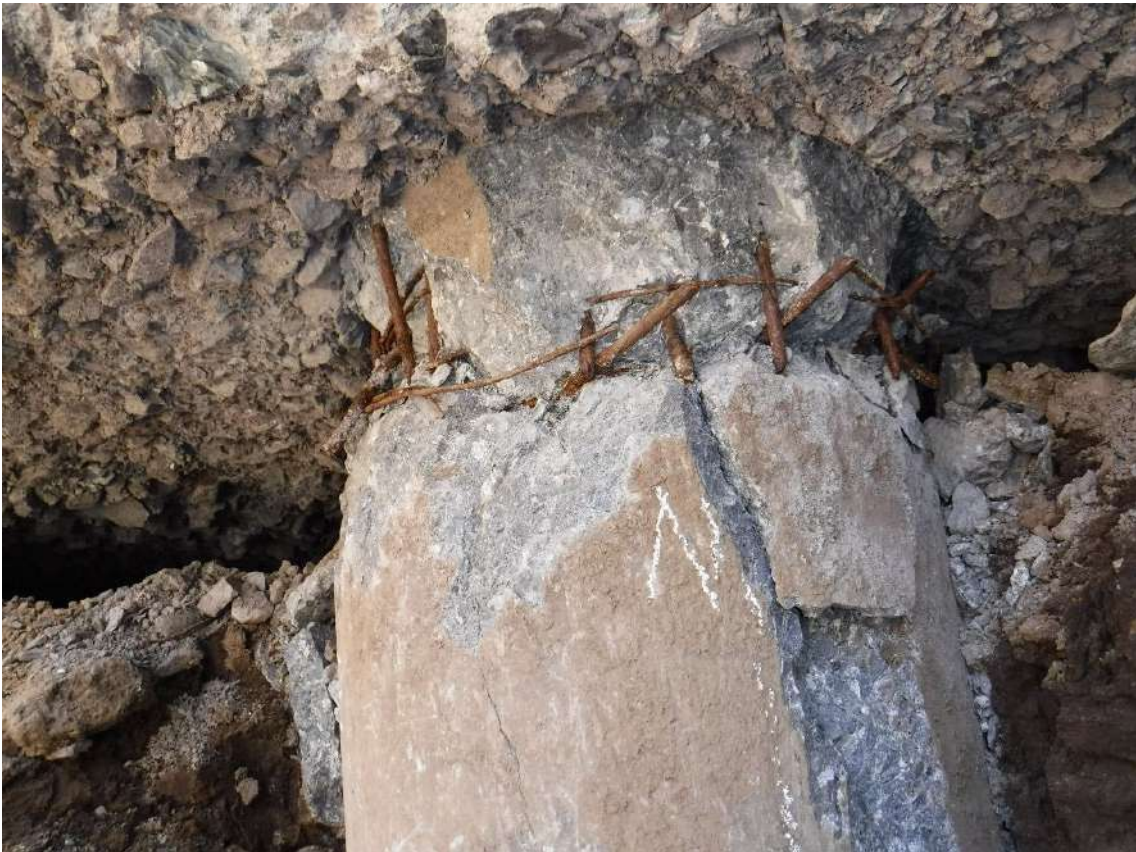
写真 7.4.2.27 杭③-1の杭頭部の状況
