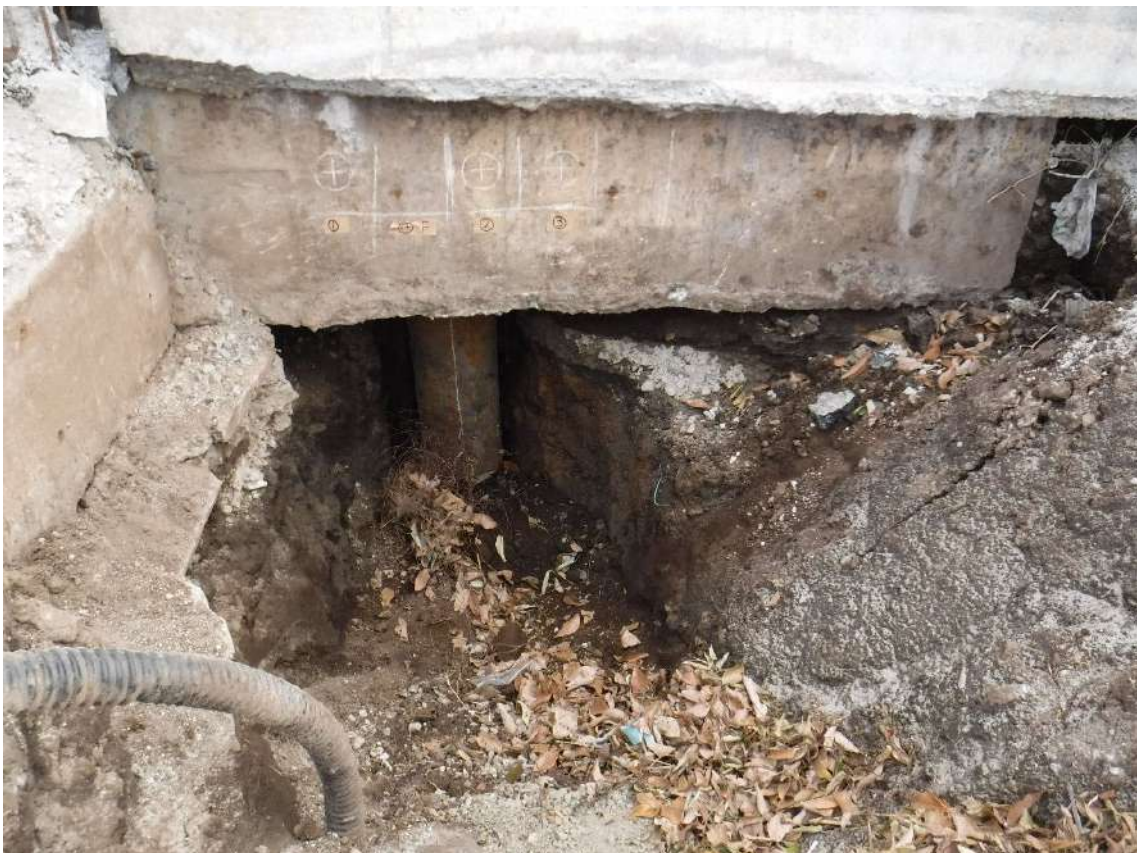
写真 7.4.2.18 基礎フーチング⑭周辺の状況
