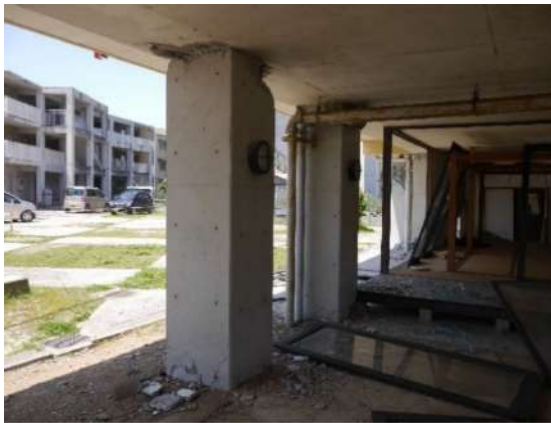
(a) 東側から見た柱全景
