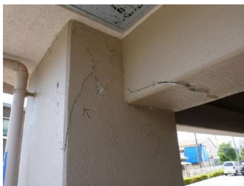
写真 4.3.1.5 2階X1Y1柱梁接合部の損傷状況
