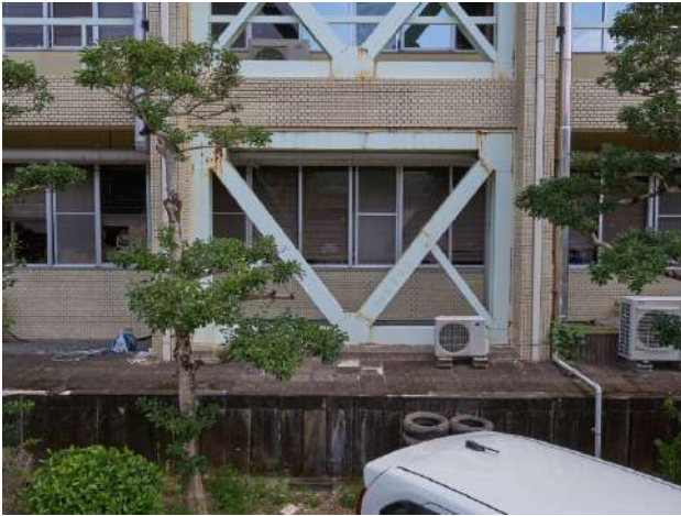
写真 8.4.3.33 ブレース⑥の損傷 (2000 万画素)
