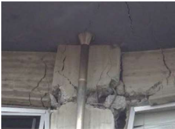
写真 9.3.3 5階柱頭部の破壊
