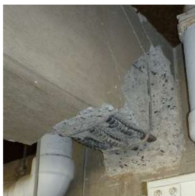
写真 4.3.1.3 2階大梁の損傷状況
