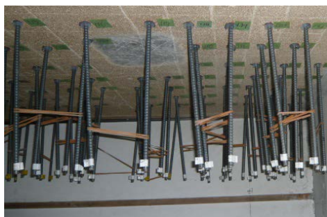
写真 5.2.2.5-1 位置固定・脱落防止（ゴムバンド）
