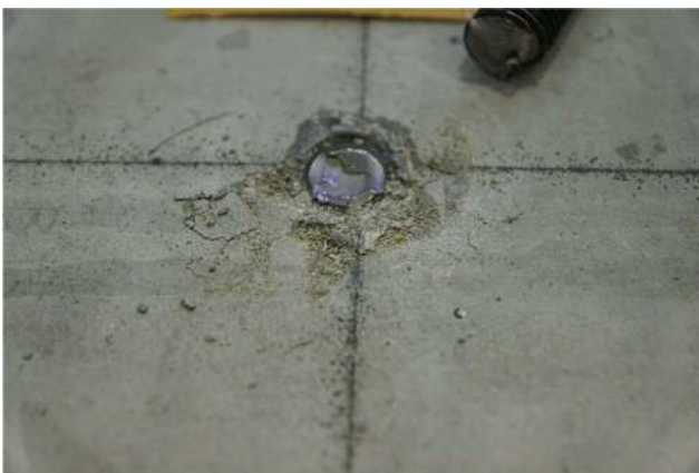
(M20-B15) *アンカー筋の破断
