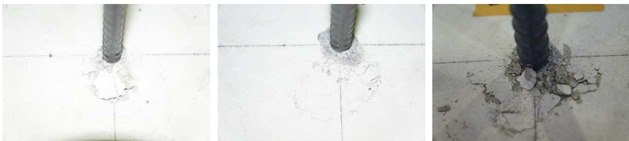
写真 2.2.3.2-1 せん断変位 4mm 時の支圧破壊状況
