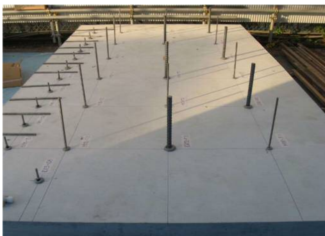
付写真1.1.1 コンクリート版及びアンカー筋打設状況の一例
