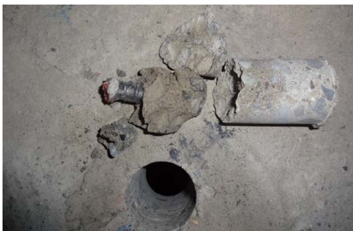
写真 5.2.3.4-1 床でコア採取を試みたがコア成形されずに崩壊した例
