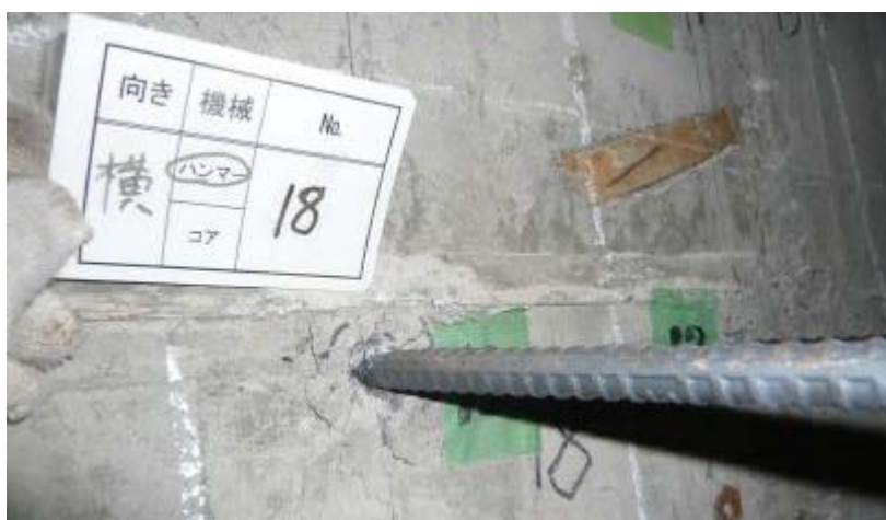
写真5.2.3.4-4 壁の型枠境界位置における不陸の例
