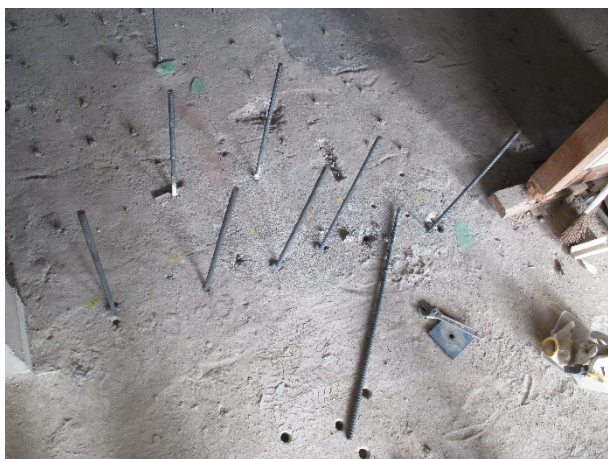
写真 5. 5. 3. 6 引張試験後の状況 (ホットドッグ②)
