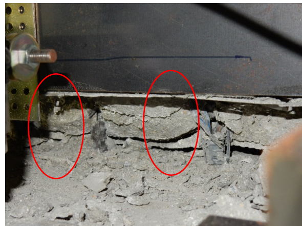
(b) アンカーの破断
