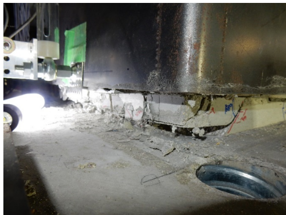
(b) 脚部の損傷状況（アンカー破断無し）
