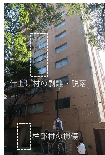
写真 3.37 外壁の損傷(建築物 14)
