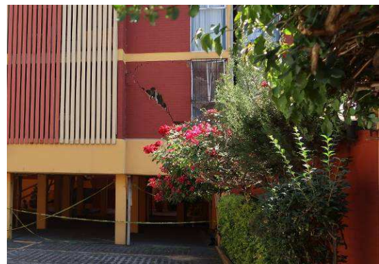
写真 3.2 袖壁状の組積造壁の損傷
