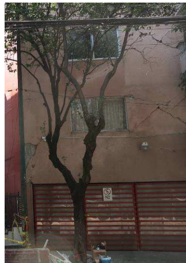
写真 3.42 壁のひび割れ
