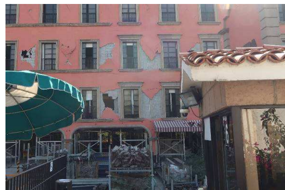
写真 3.15 ブロック造壁の被害
