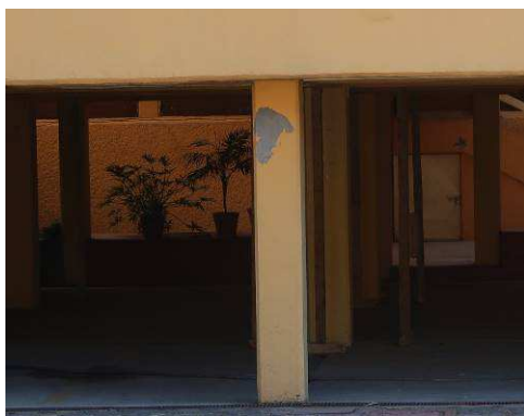
写真 3.3 柱頭部分の軽微な損傷
