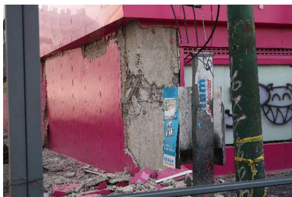
写真 3.31 1階無補強柱の損傷
