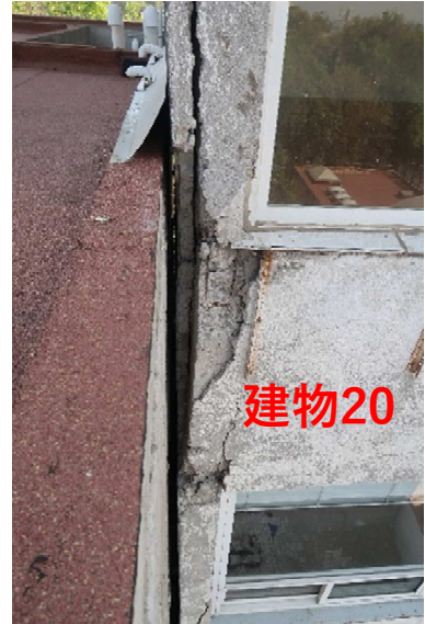
写真 3.51 衝突の痕跡 (隣棟屋上階より)
