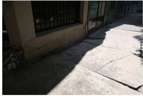
写真 3.45 建築物周辺での地盤変状の様子
