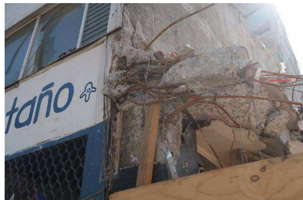
写真 3.48 崩壊建築物の残骸
