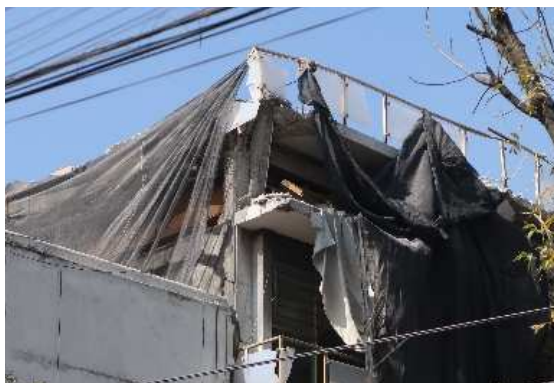
写真 3.38 6階の層崩壊(建築物 15, 7階以上は除去済み)
