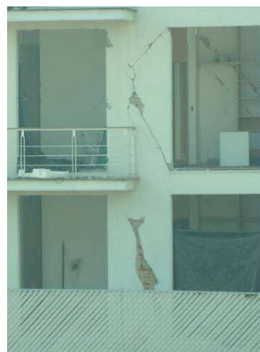
写真 3.21 方立て壁及び柱(内側)の被害
