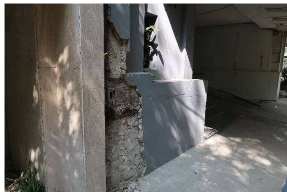
写真 3.52 隣棟との境界壁脚部の損傷 (左の隣棟側より)
