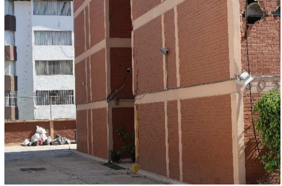
写真 3.10 妻側壁面の被害
