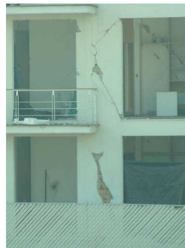
写真 3.21 方立て壁及び柱(内側)の被害
