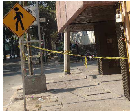
写真 3.17 入口付近の地盤変状の様子
