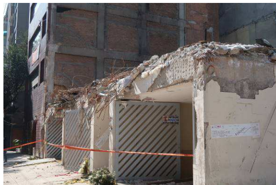
写真 3.54 残存した1階部分
