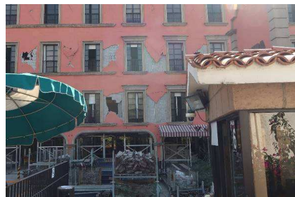
写真 3.15 ブロック造壁の被害
