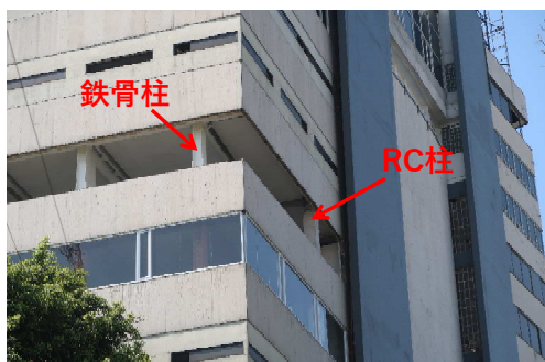
写真 3.57 外装材が脱落した6階部分
