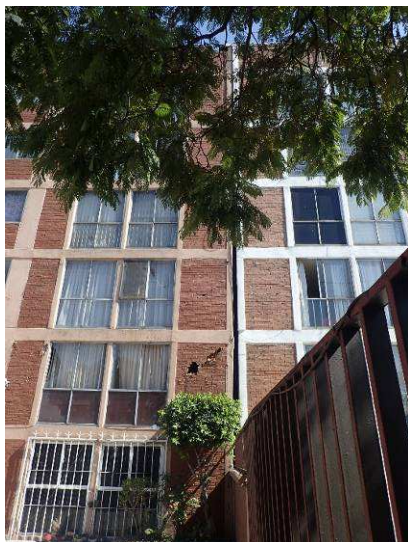
写真 3.11 隣棟との接触
