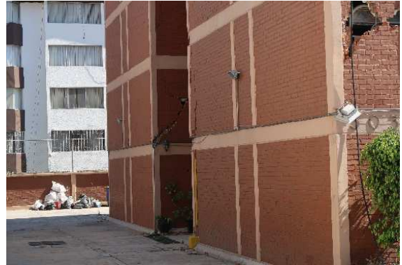
写真 3.10 妻側壁面の被害
