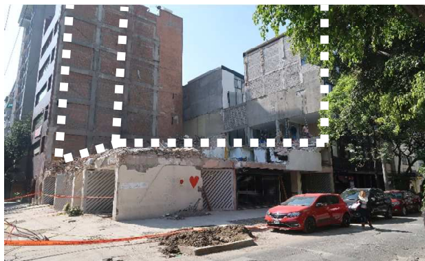
写真 3.53 崩壊建築物の除去後の様相
