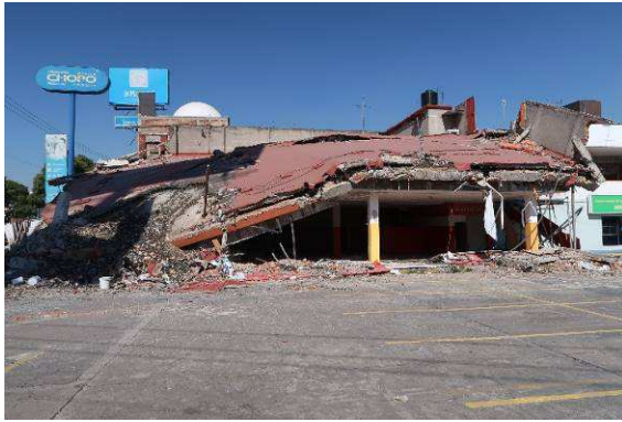
写真 3.12 コーナー部分の崩壊
