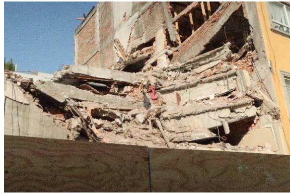
写真 3.28 被害建築物の残骸
