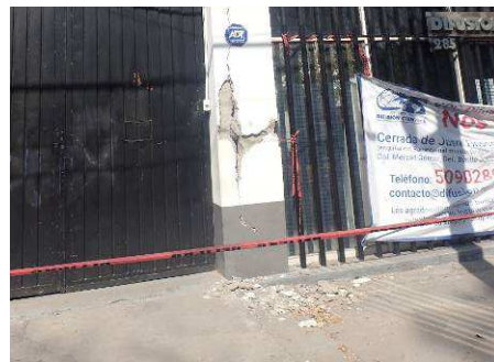
写真 3.19 柱の損傷と地盤変状の様子
