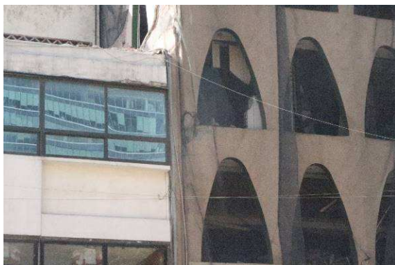
写真 3.60 隣棟との衝突の痕跡
