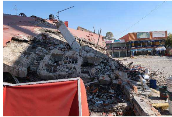
写真 3.13 崩壊したコーナー部分拡大
