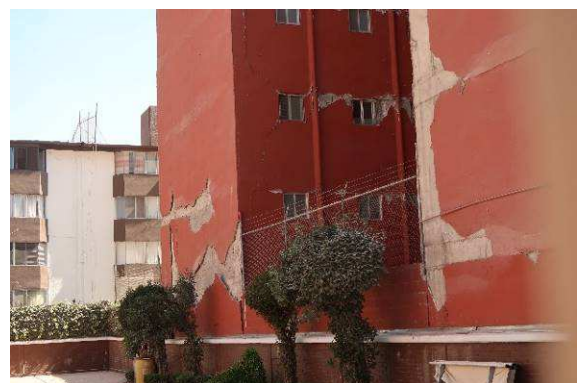
写真3.8 妻側壁面の損傷の様相
