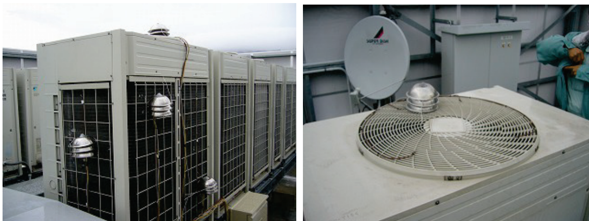
図IV. 2. 2. 7 室外機計測の様子
