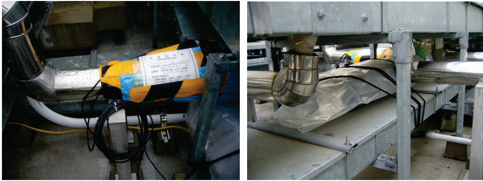
図IV. 2. 2. 9 超音波流量計設置の様子
