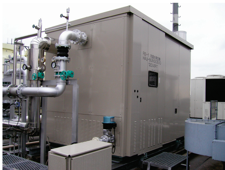
図Ⅲ.4.4.3.2. 事務所 1C 熱源機設置状況
