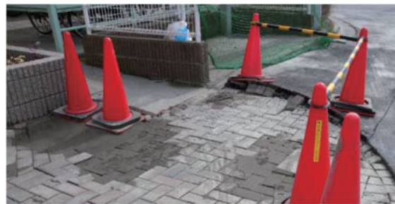
写真 2.3-2 周辺地盤の液状化の様相
