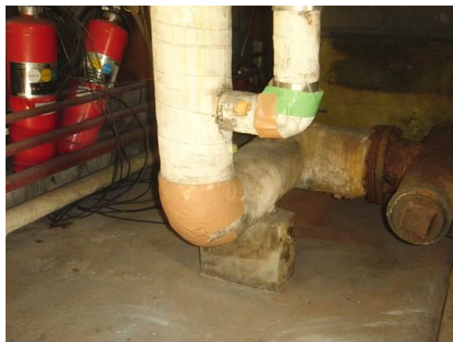
機械室 配管エルボ部
