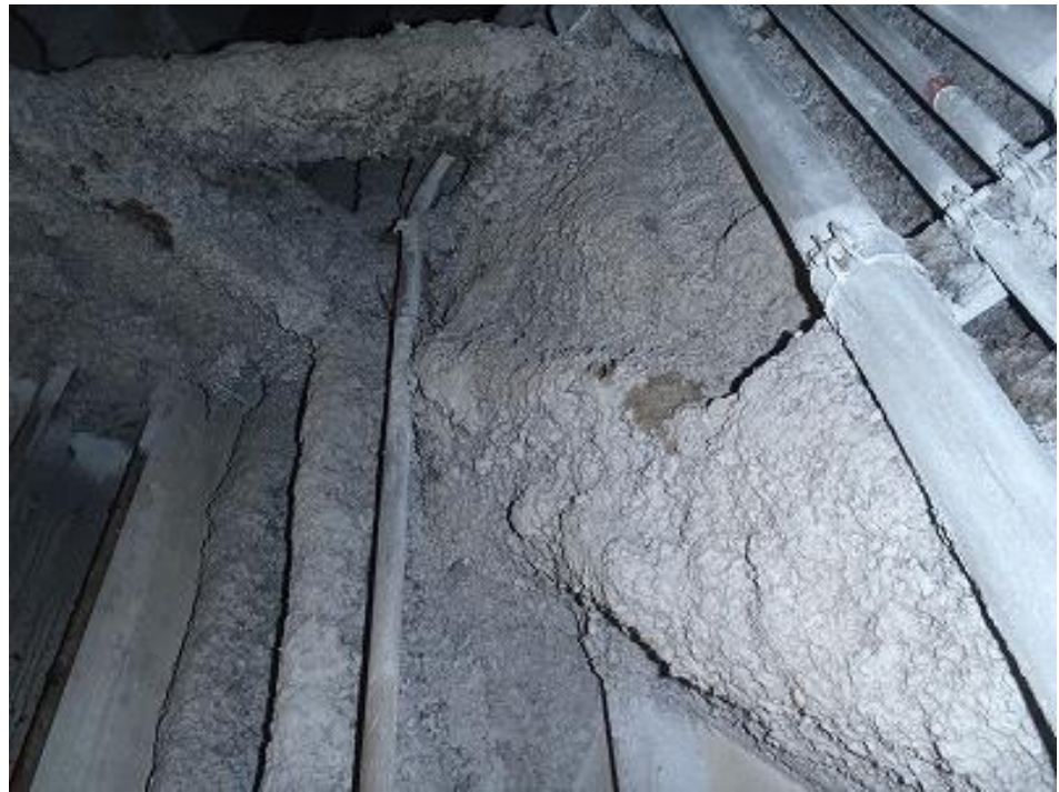
吹付け材の状況 3号機
