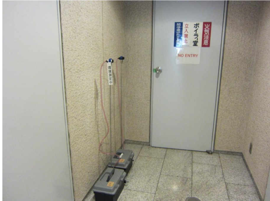
ボイラー室前（マンションエントランス内）
