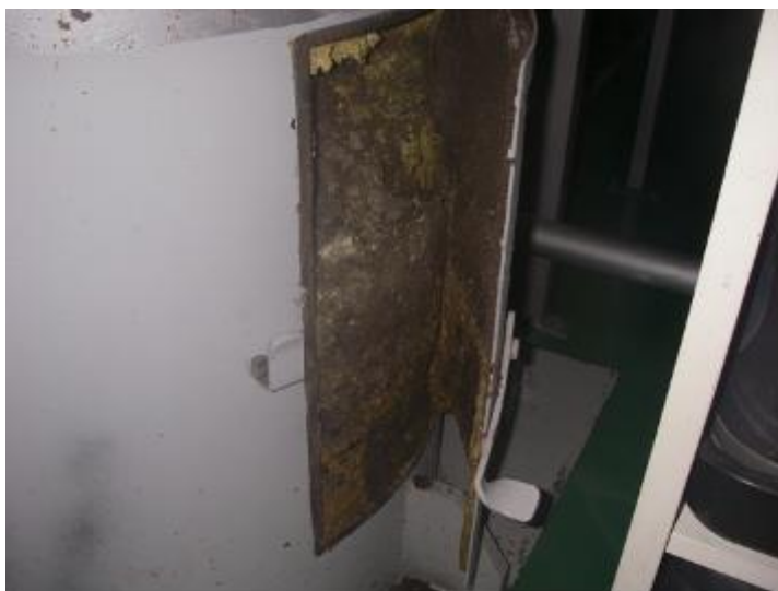
点検口部の断熱材堆積状況
