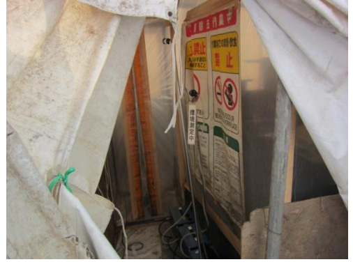
セキュリティーゾーン前（煙突頂部）
