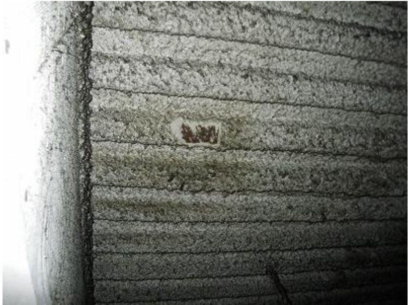
吹付けアスベスト
