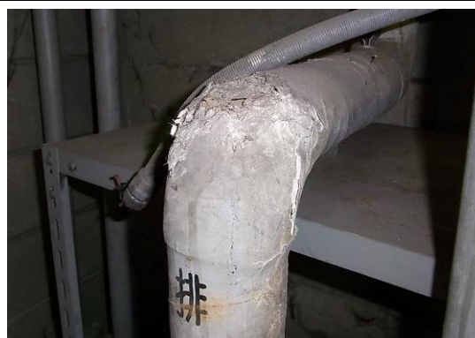
機械室内 配管エルボ
