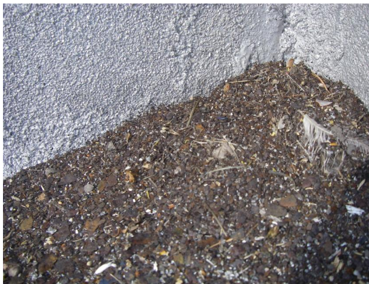
屋上に堆積していた煙突断熱材等と思われる堆積物
