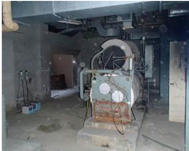
ボイラー室内
