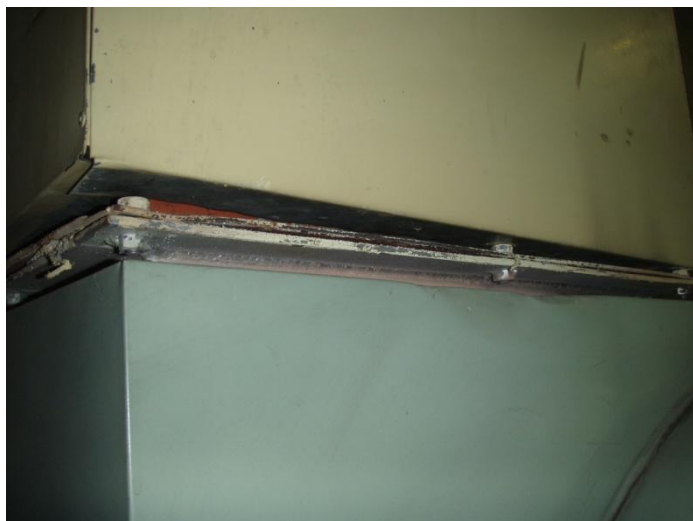
ボイラーダクトパッキン
