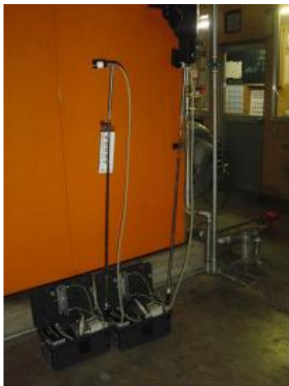
ボイラー室内サンプリング
