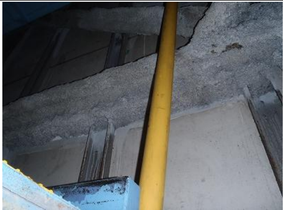
吹付け材の状況 3号機
