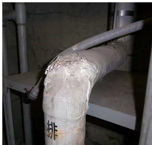
機械室内 配管エルボ
