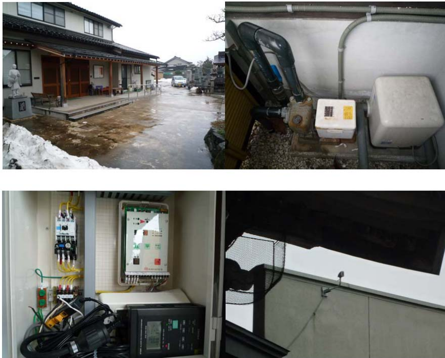
図 4.1.43 融雪対象、ポンプ、制御盤及び降雪センサーの外観
