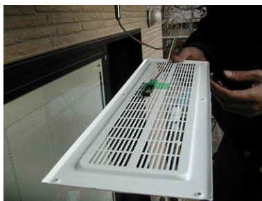
軒天換気口 風速計
