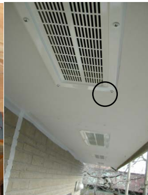
軒天換気口 微差圧計
