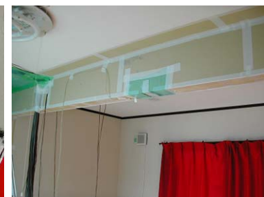
室内下がり壁と隙間状況
