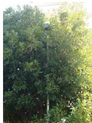
⊖ 樹木に覆われた防犯灯
