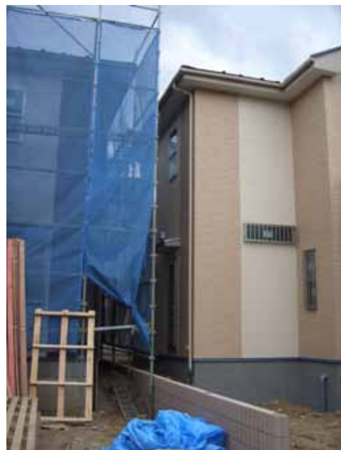
⊖ 足場から隣接建物への侵入に注意が必要
