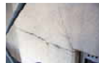
窓回りのひび割れ
