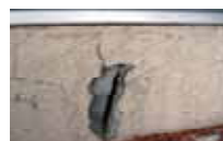
コンクリート爆裂部
