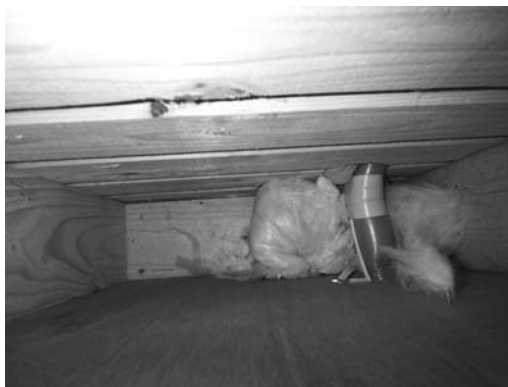
図4 竣工後にホールソーで壁に穴をあけた際に断熱材が巻き込まれた例
