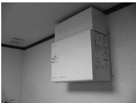
図4 壁設置の換気装置
